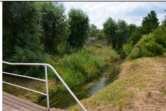
Obr. č. 26 Ješín – Červený potok je zanesený sedimenty a zarostlý vegetací – pohled proti toku směrem k silničnímu propustku I/7 Slaný Velvary
