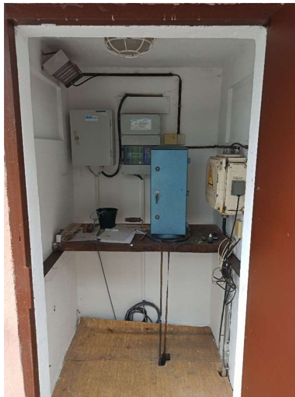
Obrázek 5 – stávající vybavení LMG Trpísta na Úterském potoce
