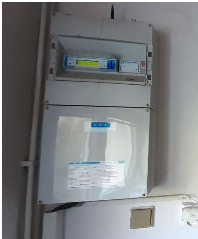
Obrázek 2 – stávající vybavení LMG Žlutice
