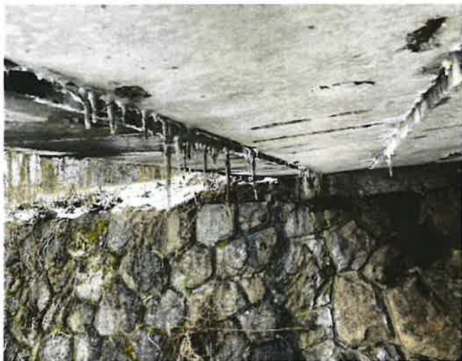
IMG_1452 - deformace jednotlivých nosníků nosné konstrukce pole 3 až 50mm, foto v zatížení pouze vlas
