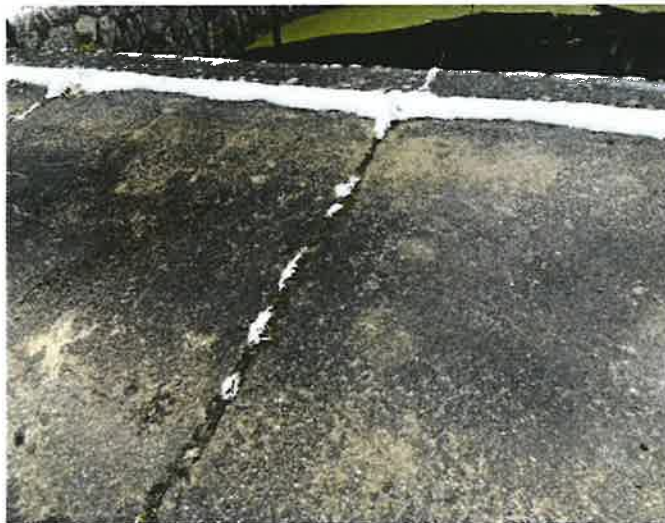
IMG_1468 - místy nepravidelné trhliny na povrchu vozovky
