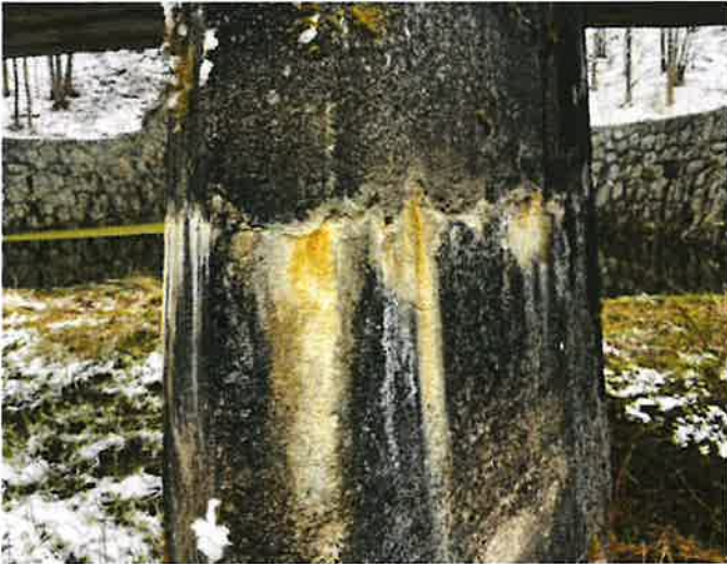
IMG_1379 - výluhy a stopy po zatékání na pilíři P2
