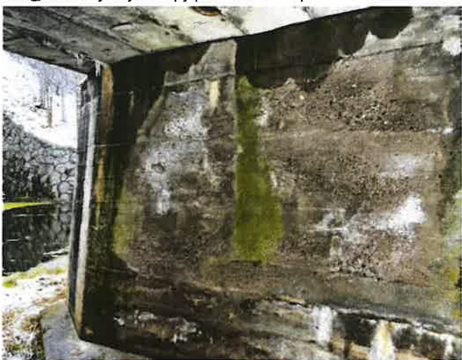
IMG_1391 - výluhy a stopy po zatékání na pilíři P3
