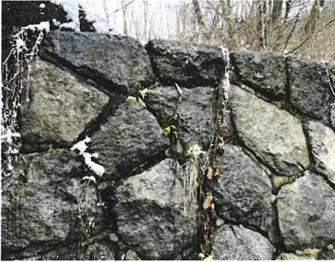
IMG_1373 - mech a vegetace ve sparách spodní stavby obou krajních opěr
