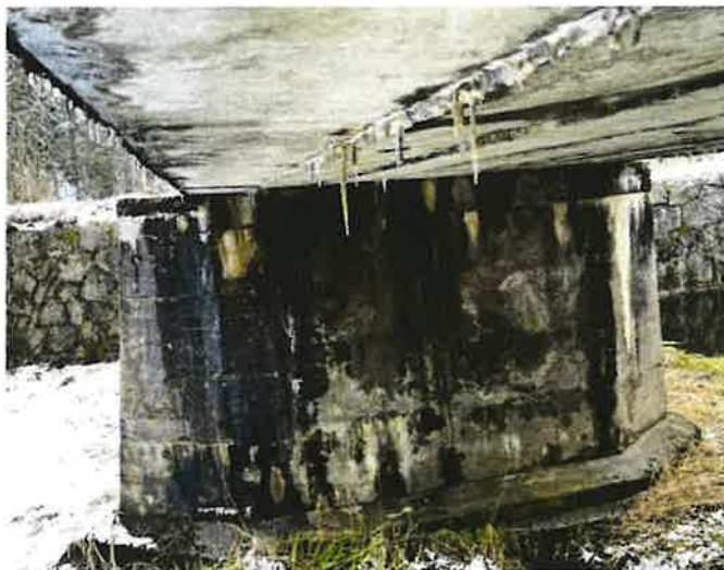
IMG_1442 - masivní zatékání do NK, krápníčky mezi jednotlivými nosníky
