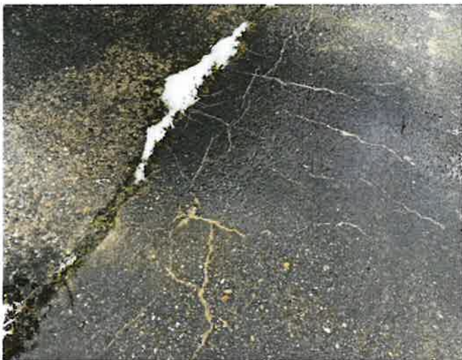
IMG_1471 - místy nepravidelné trhliny na povrchu vozovky
