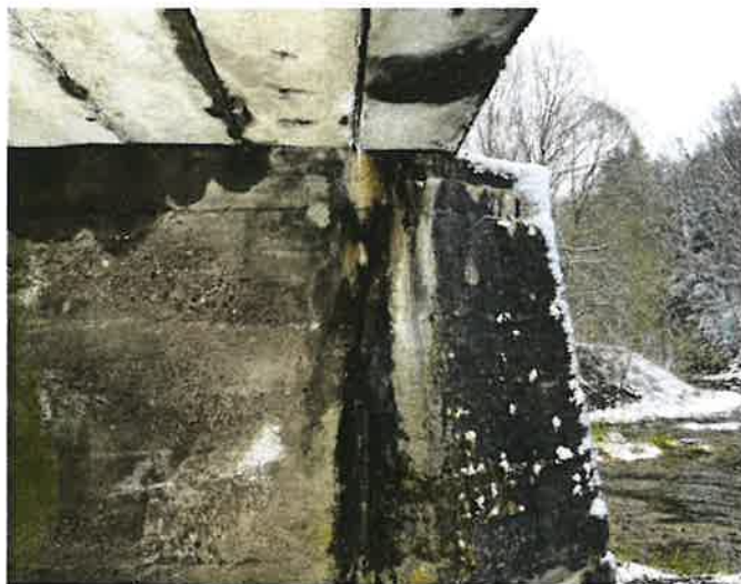
IMG_1390 - výluhy a stopy po zatékání na pilíři P3
