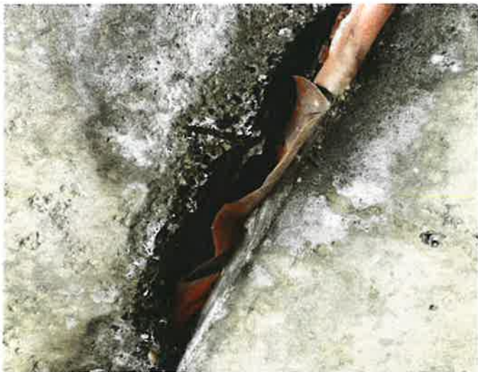
IMG_1423 - lokálně obnažená nosná výztuž 5. nosníku pole 3, koroze
