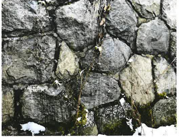
IMG_1374 - mech a vegetace ve sparách spodní stavby obou krajních opěr
