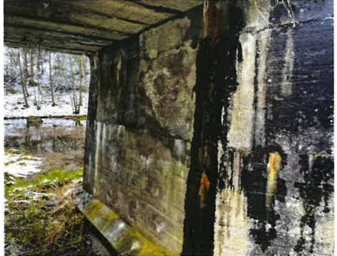
IMG_1384 - výluhy a stopy po zatékání na pilíři P2
