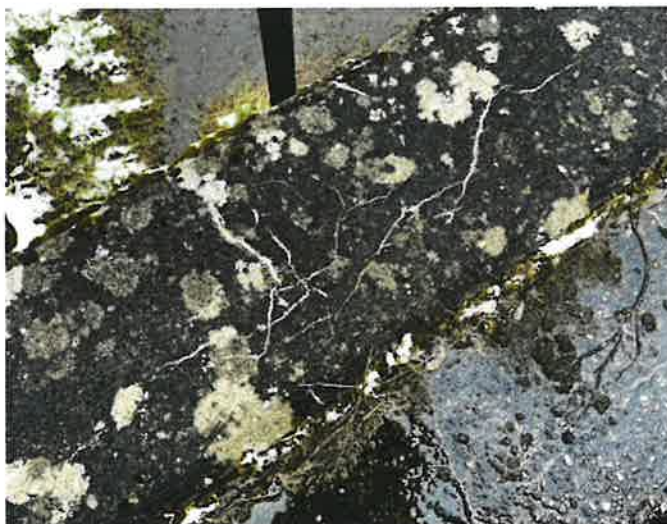
IMG_1482 - povrch říms je porostlý mechem, nepravidelné trhliny do 0,2mm
