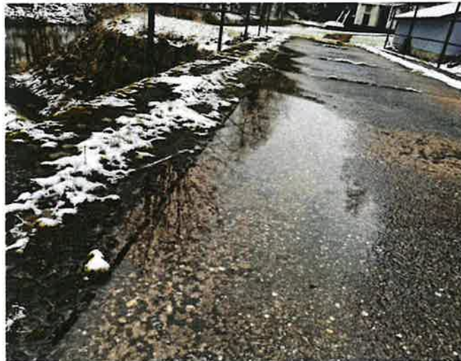
IMG_1466 - podél říms na vozovce stojí voda (zdroj zatékání do NK)
