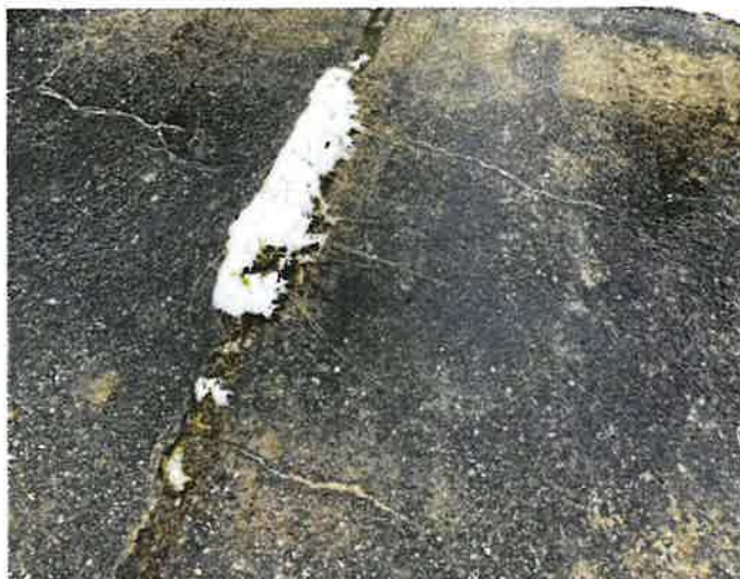
IMG_1464 - místy nepravidelné trhliny na povrchu vozovky
