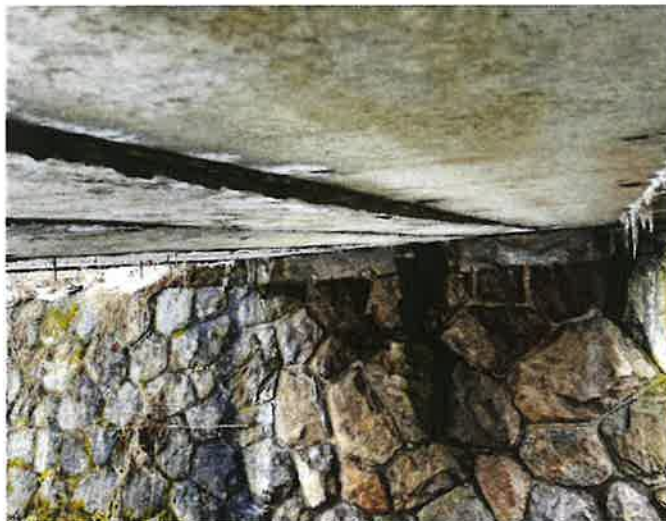
IMG_1451 - deformace jednotlivých nosníků nosné konstrukce pole 3 až 50mm, foto v zatížení pouze vlas
