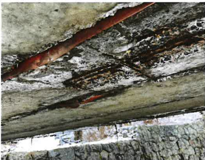
IMG_1449 - lokálně obnažená nosná výztuž 5. nosníku pole 3, koroze
