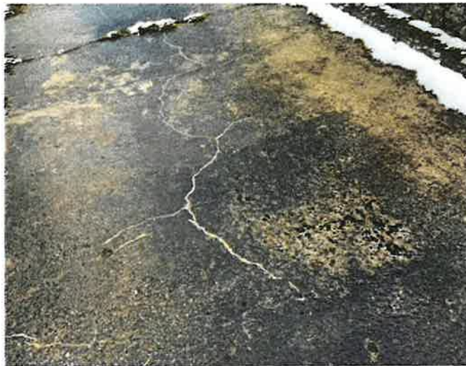
IMG_1472 - místy nepravidelné trhliny na povrchu vozovky
