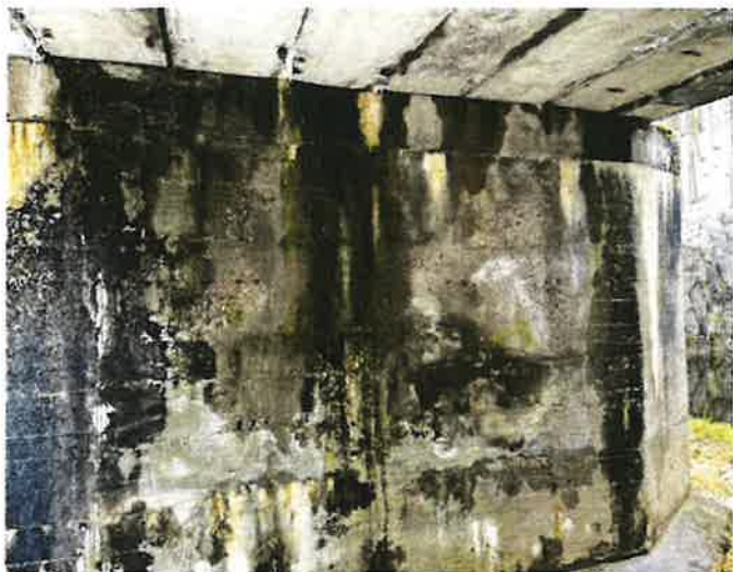
IMG_1387 - výluhy a stopy po zatékání na pilíři P3
