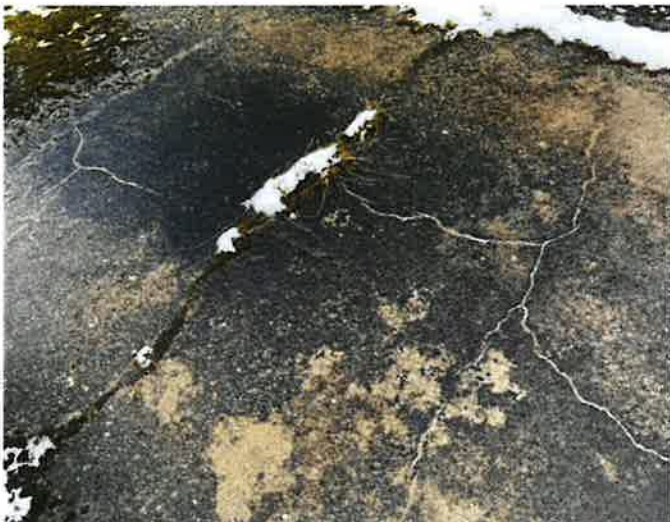
IMG_1473 - místy nepravidelné trhliny na povrchu vozovky
