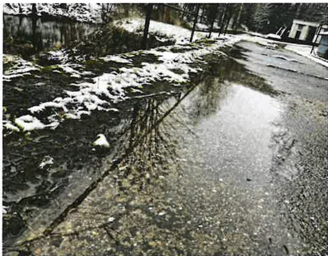
IMG_1467 - podél říms na vozovce stojí voda (zdroj zatékání do NK)
