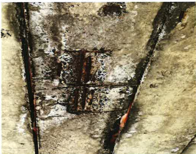
IMG_1421 - lokálně obnažená nosná výztuž 5. nosníku pole 3, koroze
