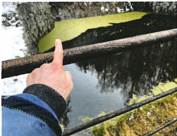
IMG_1479 - pravé zábradlí je mírně vratké
