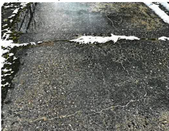
IMG_1461 - místy nepravidelné trhliny na povrchu vozovky
