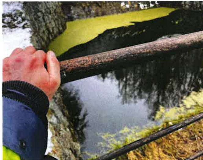
IMG_1478 - PKO zábradlí je dožilá, prozatím pouze povrchová koroze
