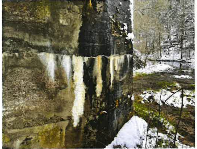
IMG_1381 - výluhy a stopy po zatékání na pilíři P2
