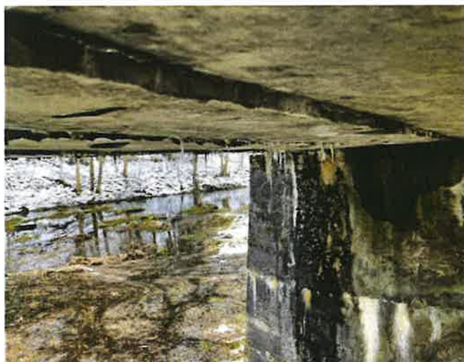
IMG_1437 - deformace jednotlivých nosníků nosné konstrukce pole 1 až 50mm, foto v zatížení pouze vlas
