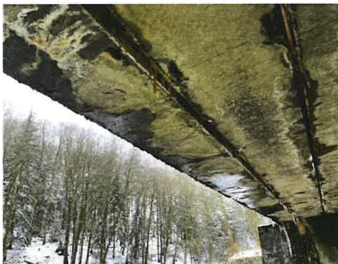
IMG_1402 - deformace jednotlivých nosníků nosné konstrukce pole 1 až 50mm, foto v zatížení pouze vlas
