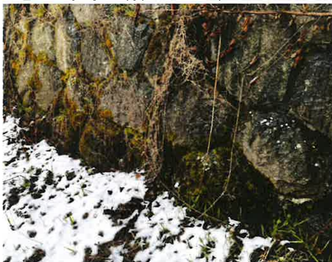
IMG_1396 - mech a vegetace ve sparách spodní stavby obou krajních opěr
