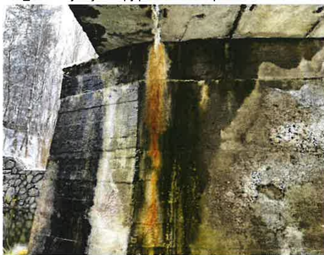
IMG_1392 - výluhy a stopy po zatékání na pilíři P3
