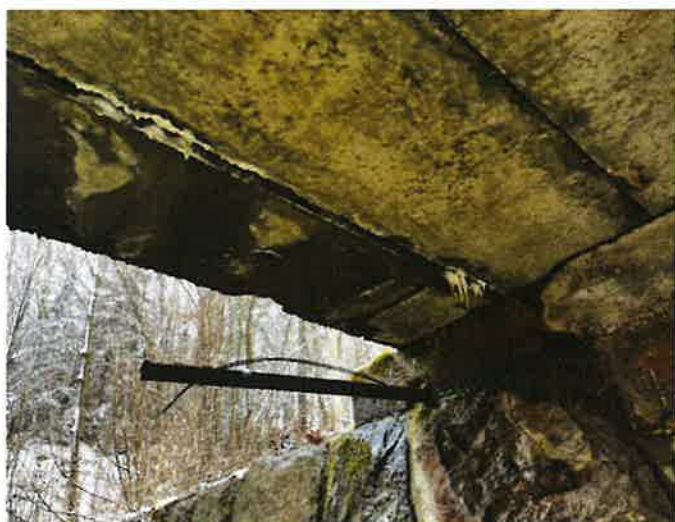
IMG_1406 - stopy po masivním zatékání na pohledu pole 1
