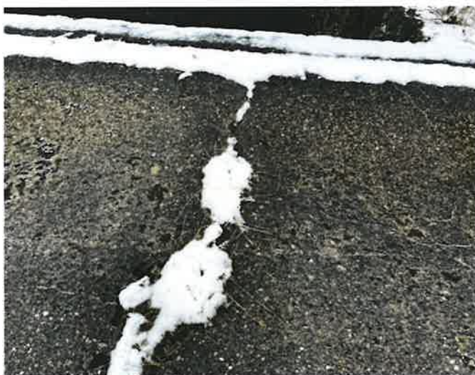
IMG_1460 - místy nepravidelné trhliny na povrchu vozovky
