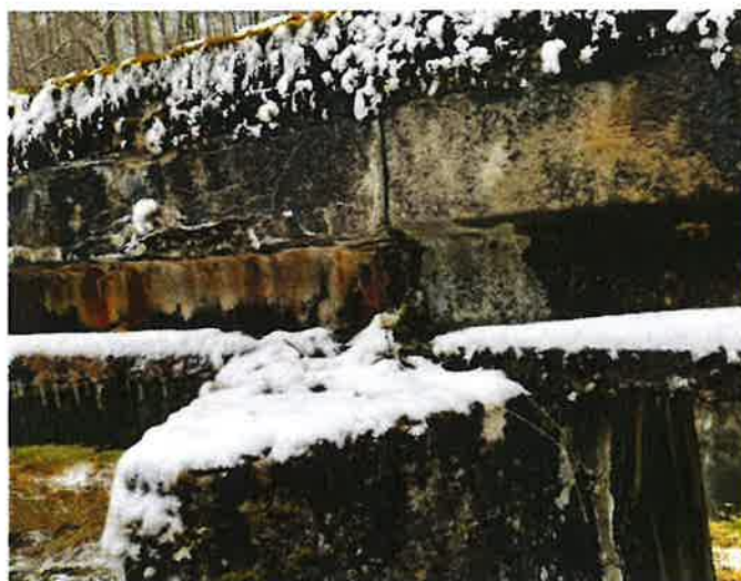
IMG_1439 - výluhy a trhliny levého nosníku pole 2
