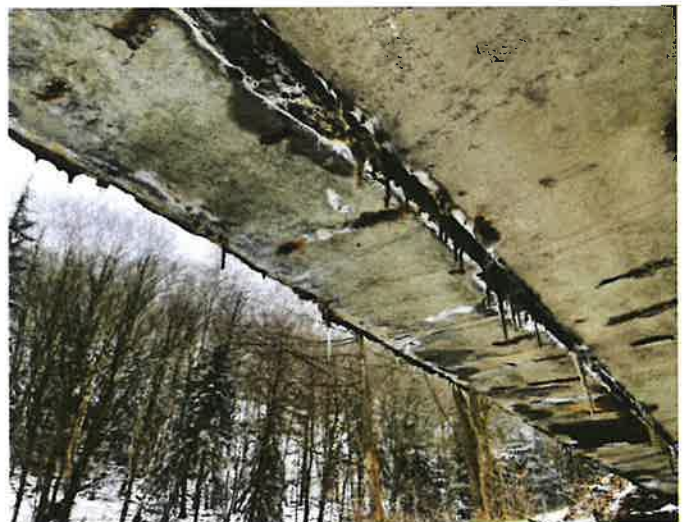
IMG_1419 - lokální hloubková degradace nosníků pole 3
