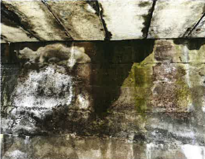
IMG_1382 - výluhy a stopy po zatékání na pilíři P2
