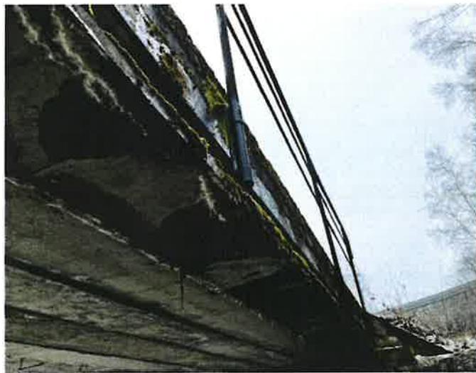
IMG_1425 - stopy po masivním zatékání na podhledu pole 3
