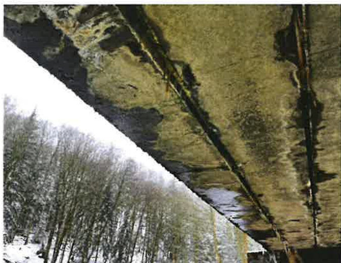
IMG_1403 - stopy po masivním zatékání na pohledu pole 1
