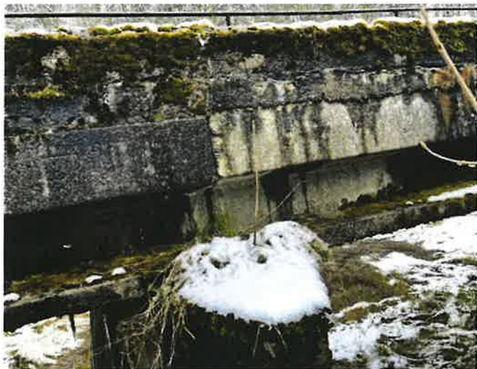
IMG_1440 - výluhy a výtoky mezi spádovou deskou a římsou
