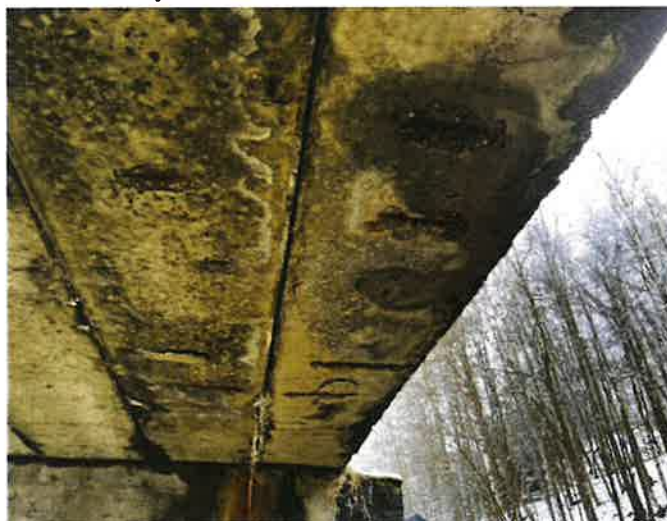
IMG_1408 - lokálně na pohledu všech polí obnažená pomocná výztuž, koroze
