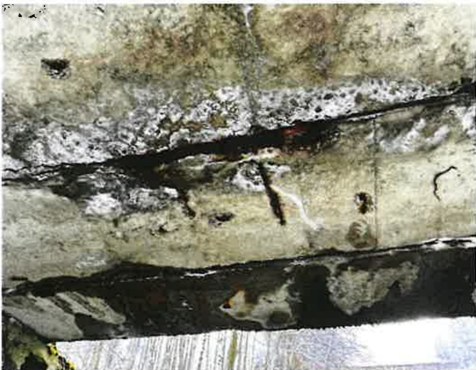
IMG_1428 - lokálně obnažená nosná výztuž 7. nosníku pole 3, koroze
