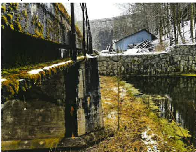
IMG_1436 - nosná konstrukce je po svých bočních plochách porostlá mechem
