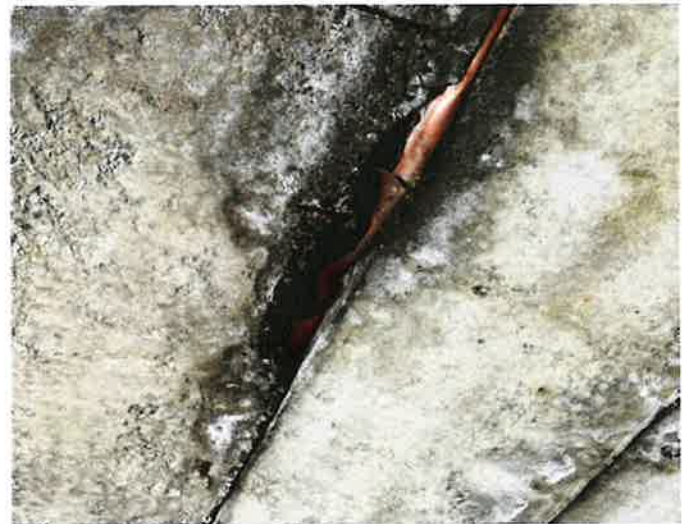
IMG_1422 - lokálně obnažená nosná výztuž 5. nosníku pole 3, koroze
