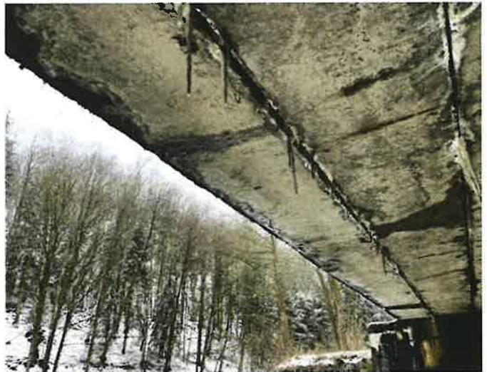
IMG_1413 - stopy po masivním zatékání na podhledu pole 1
