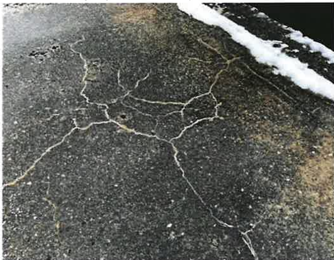
IMG_1465 - místy nepravidelné trhliny na povrchu vozovky
