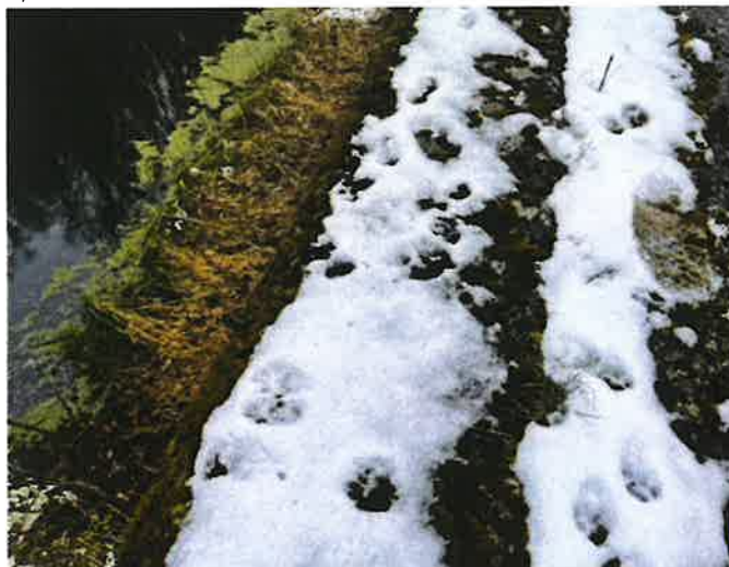
IMG_1486 - povrch říms je porostlý mechem, nepravidelné trhliny do 0,2mm
