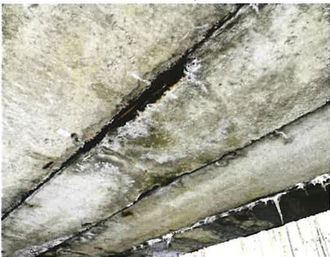
IMG_1426 - lokálně obnažená nosná výztuž 7. nosníku pole 3, koroze
