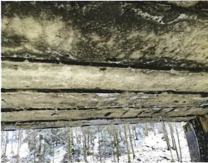
IMG_1409 - deformace jednotlivých nosníků nosné konstrukce pole 1 až 50mm, foto v zatížení pouze vlas
