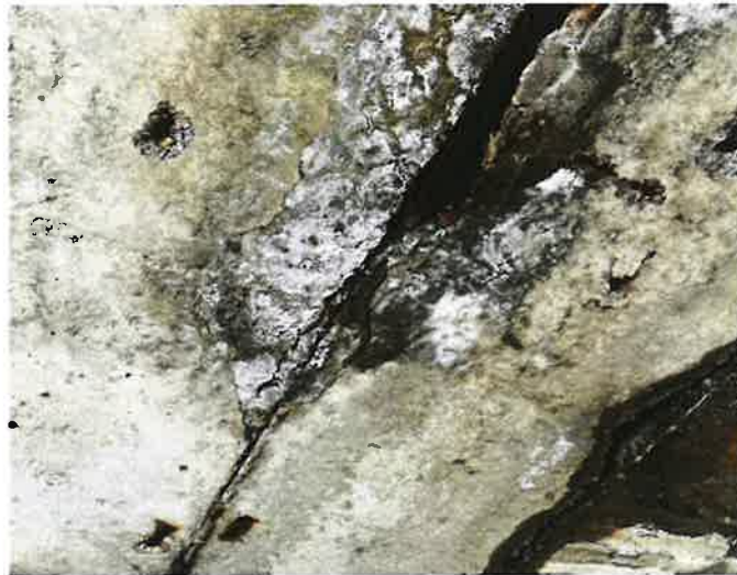
IMG_1429 - lokálně obnažená nosná výztuž 7. nosníku pole 3, koroze
