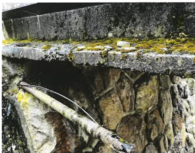
IMG_1435 - vyčnívající a přerušené kabelové vedení z opěry O1
