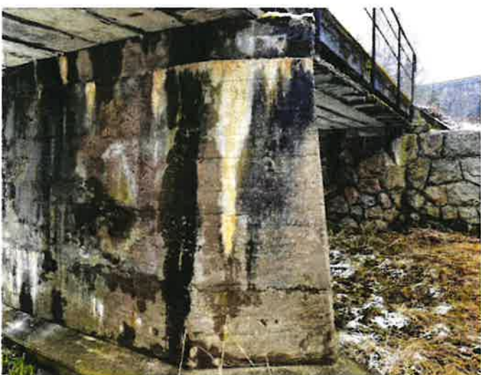
IMG_1394 - výluhy a stopy po zatékání na pilíři P3
