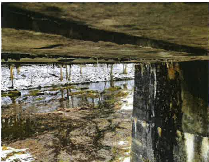
IMG_1438 - deformace jednotlivých nosníků nosné konstrukce pole 1 až 50mm, foto v zatížení pouze vlas
