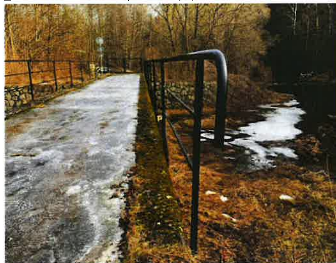
_Pohled na levou římsu proti směru popisu_foto 28.2.21
