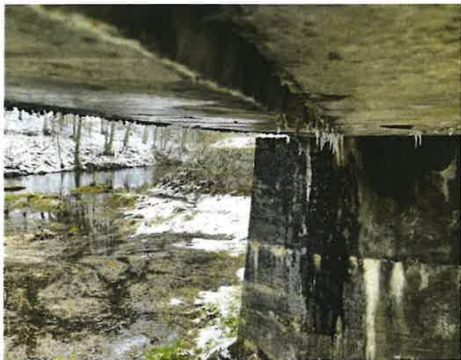
IMG_1433 - deformace jednotlivých nosníků nosné konstrukce pole 1 až 50mm, foto v zatížení pouze vlas
