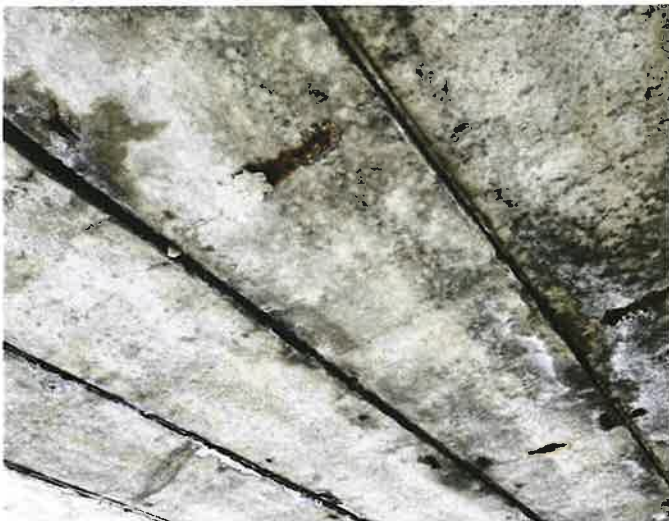
IMG_1416 - lokálně na podhledu všech polí obnažená pomocná výztuž, koroze
