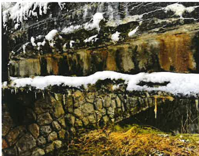
IMG_1447 - hloubková degradace levého okraje nosné konstrukce cca v polovině rozpětí pole 3
