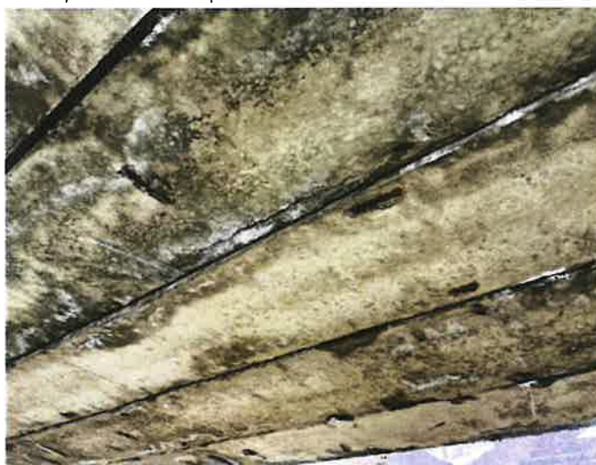
IMG_1405 - na 5. nosníku pole 1 podélná trhлина, známka rozvoje koroze hlavní nosné výztuže
