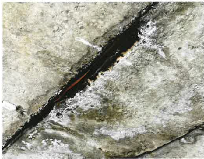
IMG_1427 - lokálně obnažená nosná výztuž 7. nosníku pole 3, koroze
