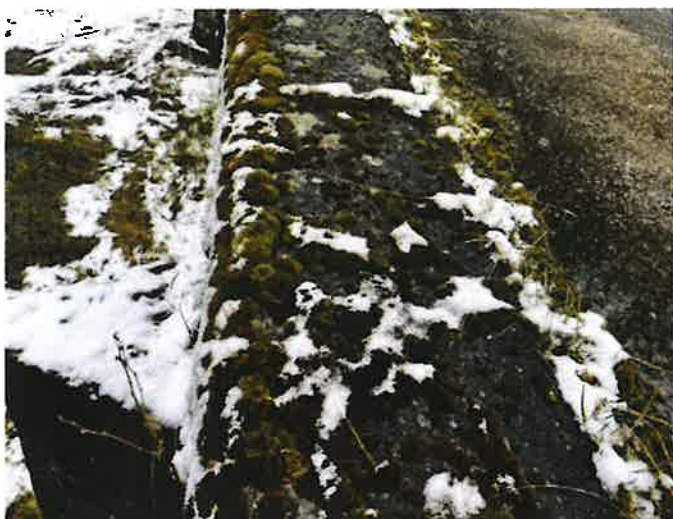
IMG_1483 - povrch říms je porostlý mechem, nepravidelné trhliny do 0,2mm
