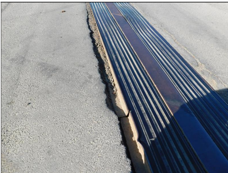
Rozpad živičného krytu vozovky u kolejové dráhy na předmostí u opěry OP1, detail
