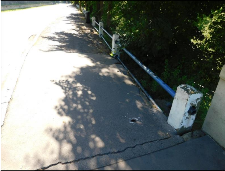
Nevhodně napojené zábradlí na levobřežním předmostí, záchytná funkce je omezená
