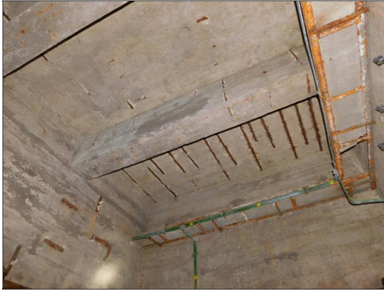
Opěra OP1 - vnitřní prostor, degradace betonu, koroze výztuže
