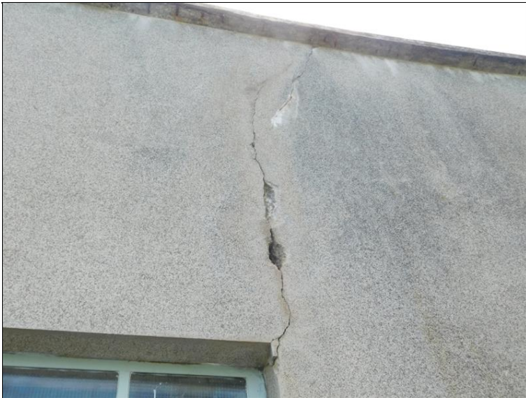
Pole 16 - svislá trhлина nad okenním otvorem na vnějším líci pravé stěny
