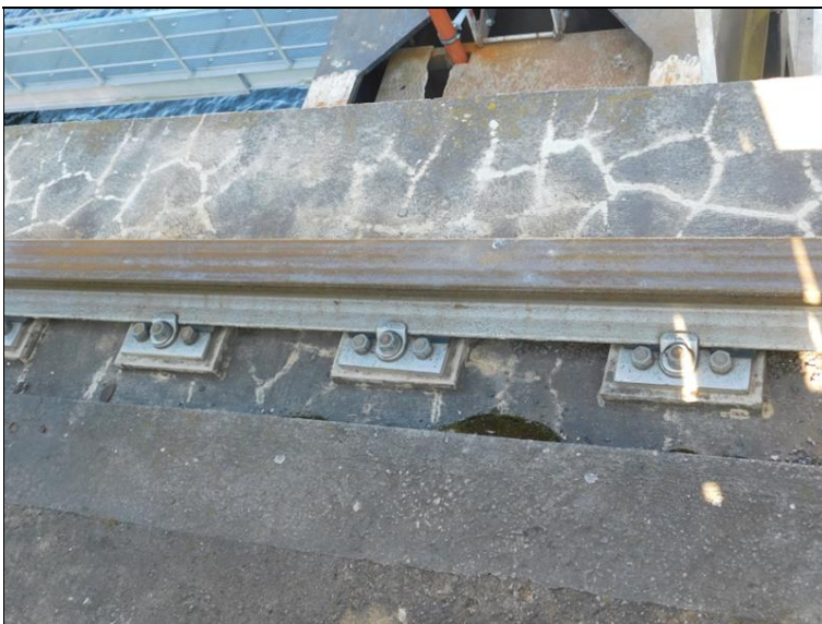
Sítové trhliny na horním líci sanací horního líce strojoven
