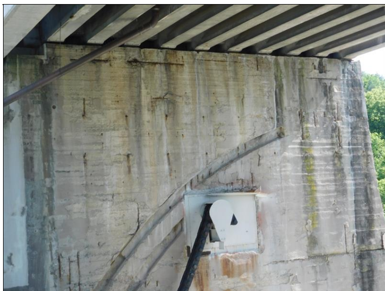
Pilíř P7 - líc do pole 7, plošná degradace betonu, na řadě ploch prokreslená korodující výztuž
