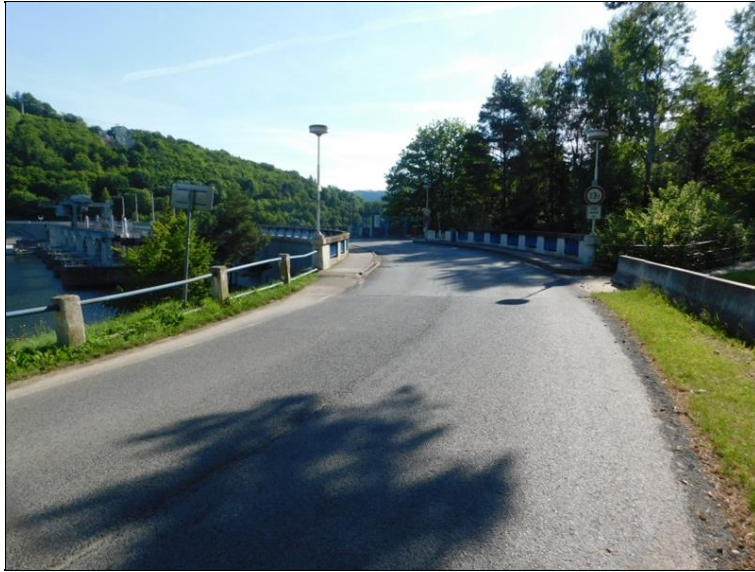
Záchytný systém na předmostí za opěrou OP18 je rozpadlý - sloupky se vyklání, některé hloubkově degradují
