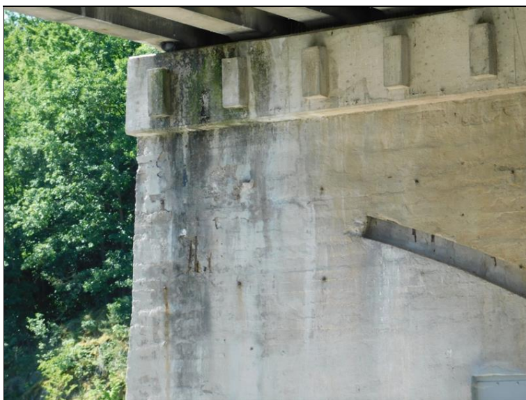
Pilíř P11 - silné zatékání na líci pilíře do pole 10, degradace betonu
