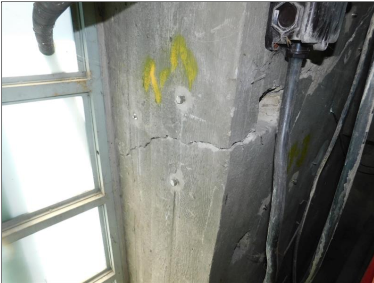
Strojovna 11b - šikmá trhlina na líci povodní stěny
