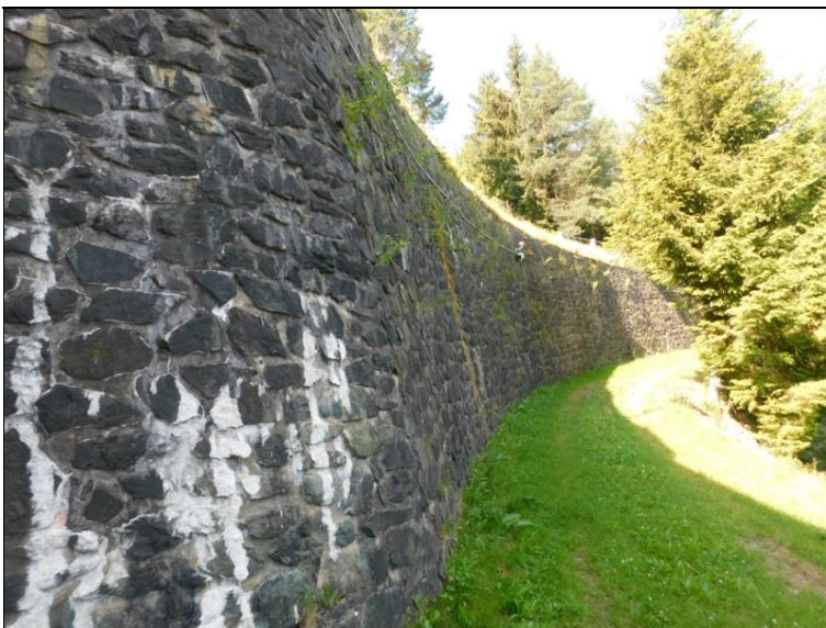
Navazující kamenné křídlo za opěrou OP18 na pravé straně - lokálně uchycená vegetace, výluhy pojiva
