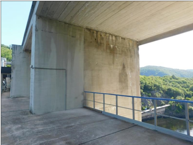
Pilíř P13 - silné průsaky v místě úložné spáry
