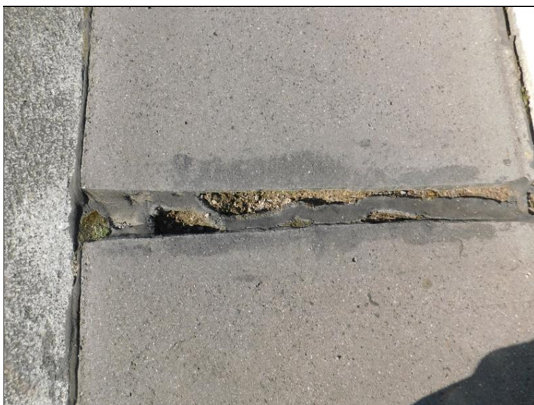
Široká trhlina v chodníku.
