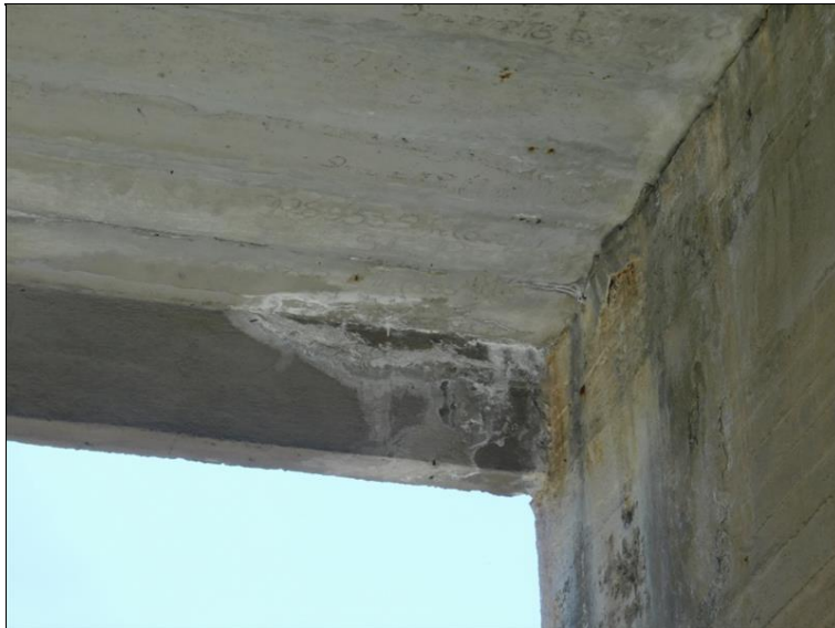
Pole 4 - silné průsaky s výluhy u plentovacího nosníku na levé straně
