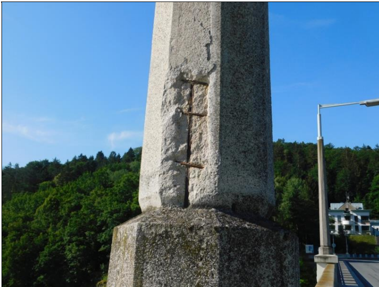
Lokálně odpadá krycí vrstva stožáru osvětlení, koroze odhalené betonářské výztuže
