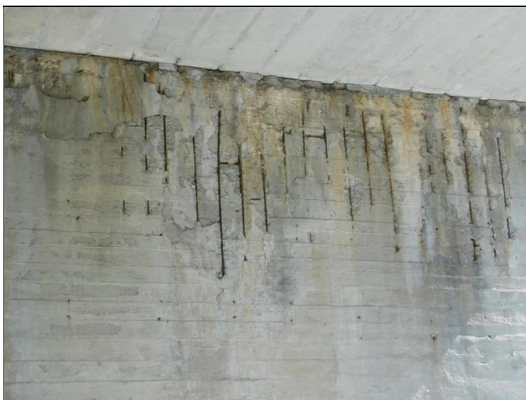
Pilíř P4 - plošná separace krycí vrstvy výztuže úložného prahu, silná koroze betonářské výztuže
