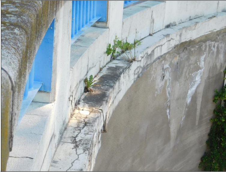
Rozpad betonové římsy s uchycenou vegetací na levé straně v poli 1
