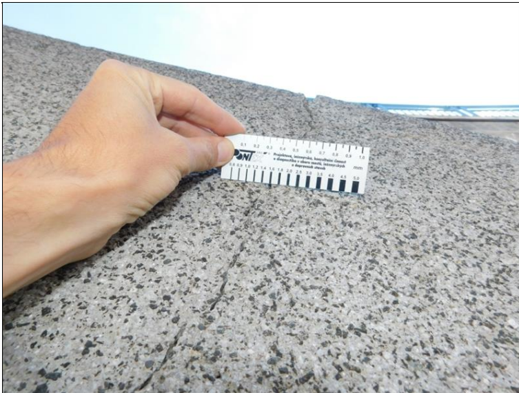
Svislá trhлина na líci schodiště u pravého křídla opěry OP1 šířky 1,6 mm
