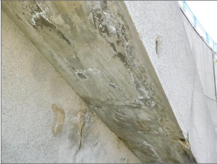
Degradace spodního líce schodiště u pravého křídla opěry OP1
