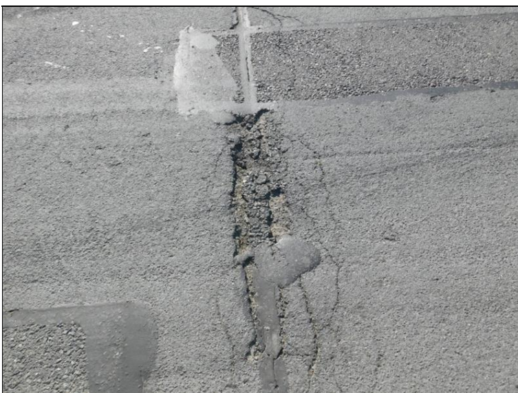
Výtluk ve vozovce
