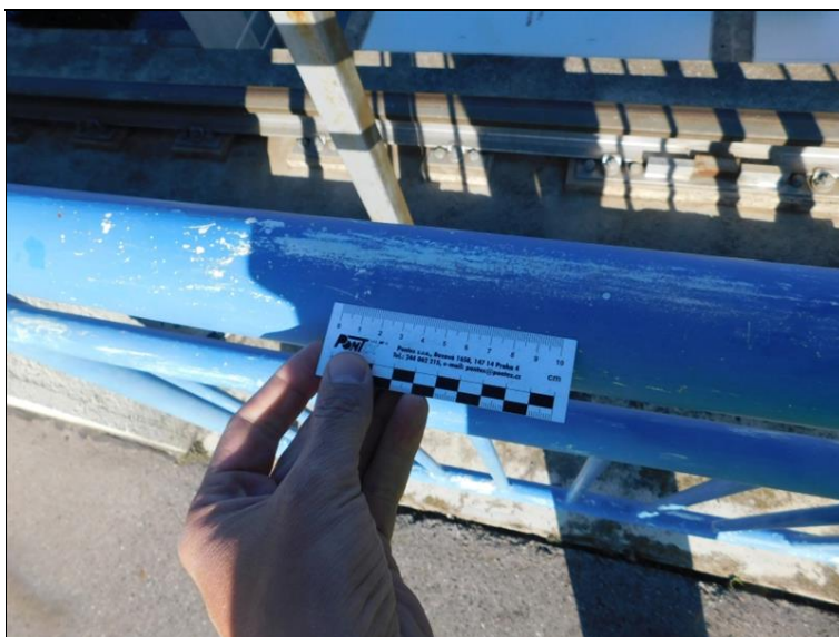
Poškozená protikoroze ochrana na horním madle zábradlí, pole 1, pravá strana
