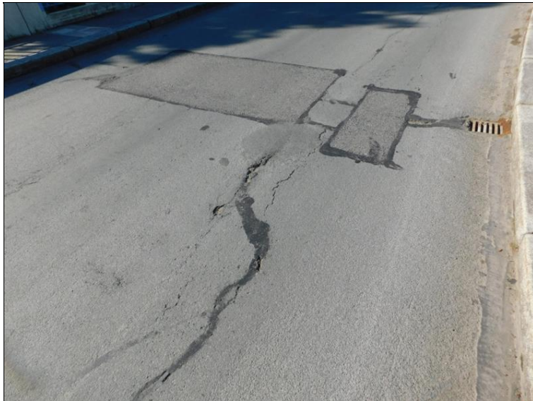
Podélné trhliny ve vozovce
