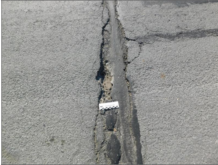
Výtluk ve vozovce, poškozené těsnění dilatační spáry
