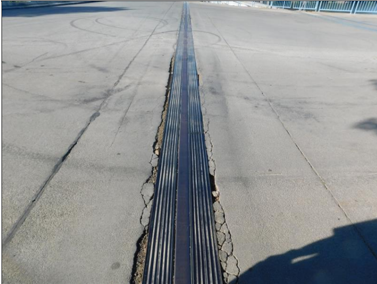
Rozpad živičného krytu vozovky u kolejové dráhy na předmostí u opěry OP1
