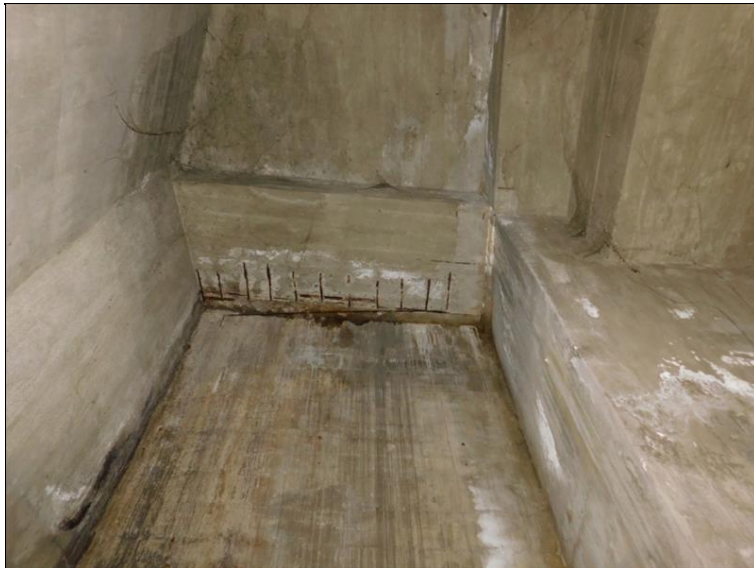
Pole 2 - silné průsaky dilatační spárou, koroze betonářské výztuže
