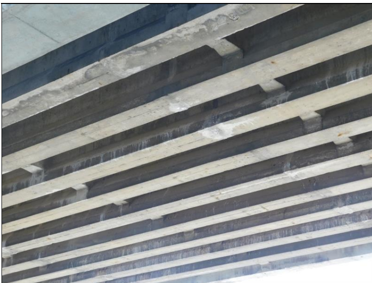
Pole 9 - stopy po průsacích v místě trhlín nosné konstrukce, trhliny kopírují vedení předpínací výztuže
