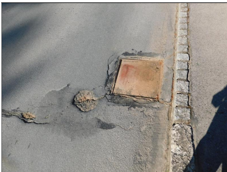
Pojížděný poklop neznámé únosnosti ve vozovce v poli 17, pravá strana
