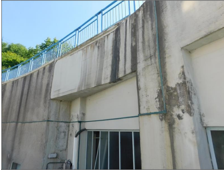
Pole 2 - silné zatékání na vnějším líci pole 2 na pravé straně
