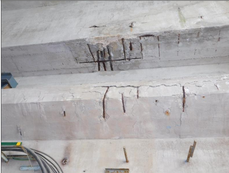
Strojovna 8b - degradace betonu a silná koroze betonářské výztuže stěny a jeřábové dráhy
