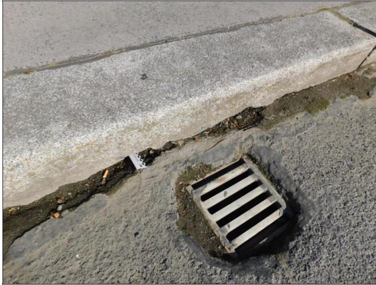
Lokální degradace pod kamenným obrubníkem chodníku, pravá strana
