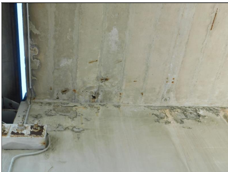
Pole 5 - průsaky na spodním líci nosné konstrukce, bodová koroze výztuže
