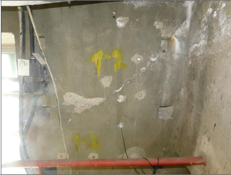
Strojovna 11b - šikmá trhlina na líci povodní stěny
