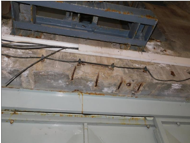
Strojovna 7b - degradace betonu a koroze výztuže v místě vstupního otvoru
