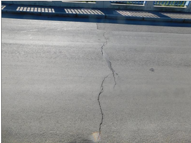
Příčné trhliny v živičném krytu vozovky
