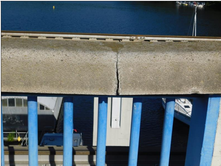
Rozlomené kamenné madlo zábradlí, pravá strana
