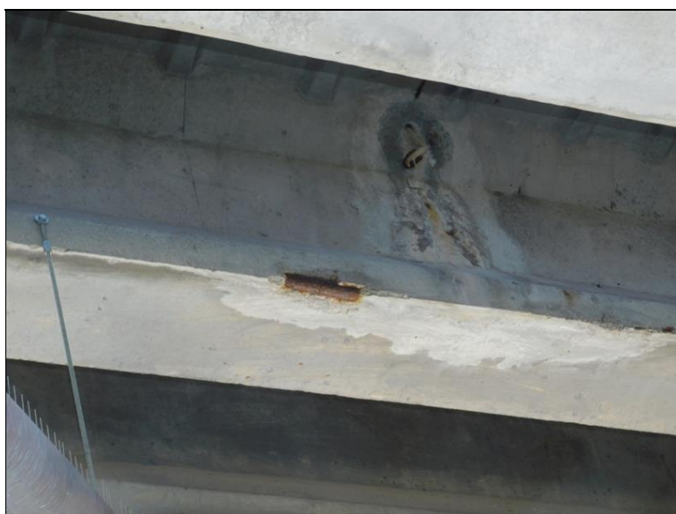
Pole 7 - pravý bok krajního nosníku, silný průsak v místě odvodňovacího otvoru, v hraně trámu korodující výztuž
