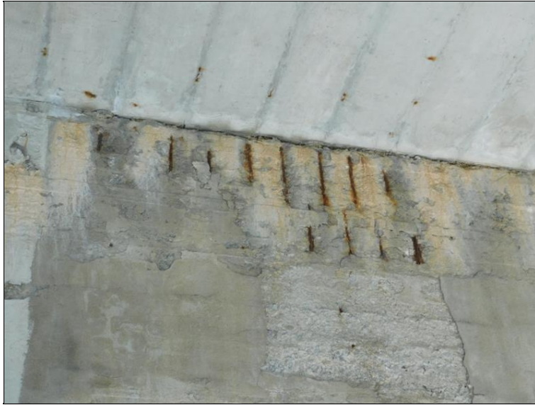
Pilíř P4 - plošná separace krycí vrstvy výztuže úložného prahu, silná koroze betonářské výztuže
