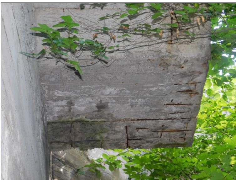
Degradace spodního schodiště na levé straně opěry OP17, silná koroze výztuže
