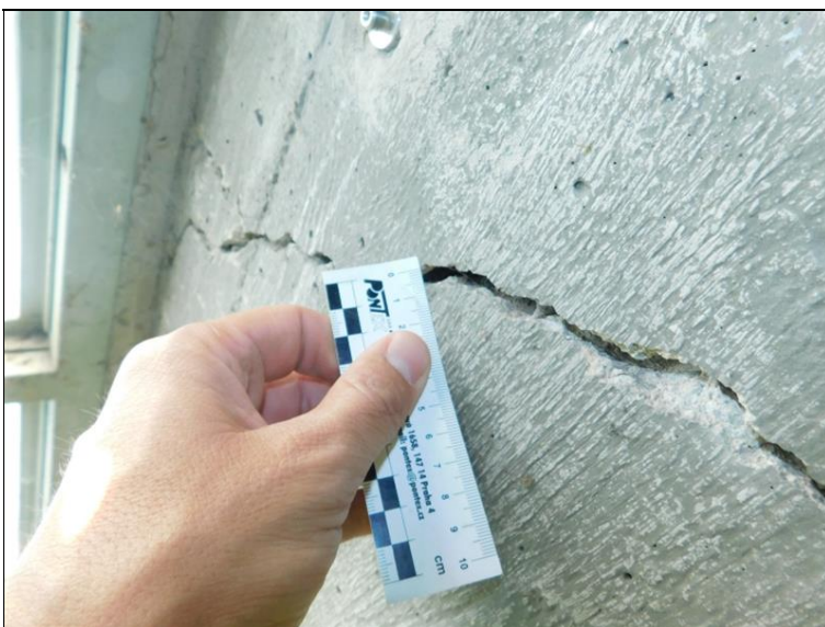
Strojovna 11b - šikmá trhlina na líci povodní stěny, detail šířky trhliny 7 mm
