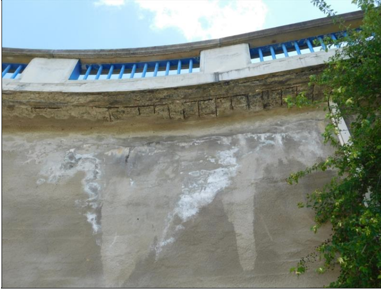
Opěra OP1, levé křídlo - výkvěty výluhů na líci křídla, na spodním líci plošně separovaná krycí vrstva, koroze betonářské výztuže
