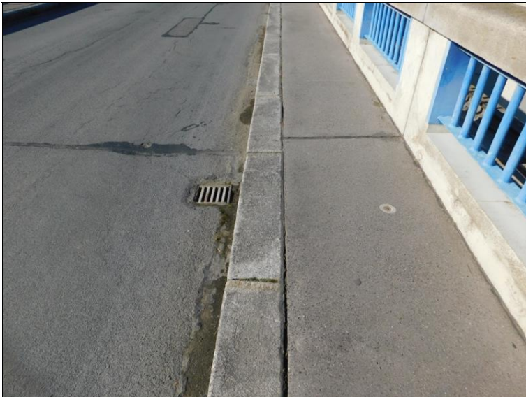
Otevřená podélná spára mezi obrubníkem a živičným krytem chodníku
