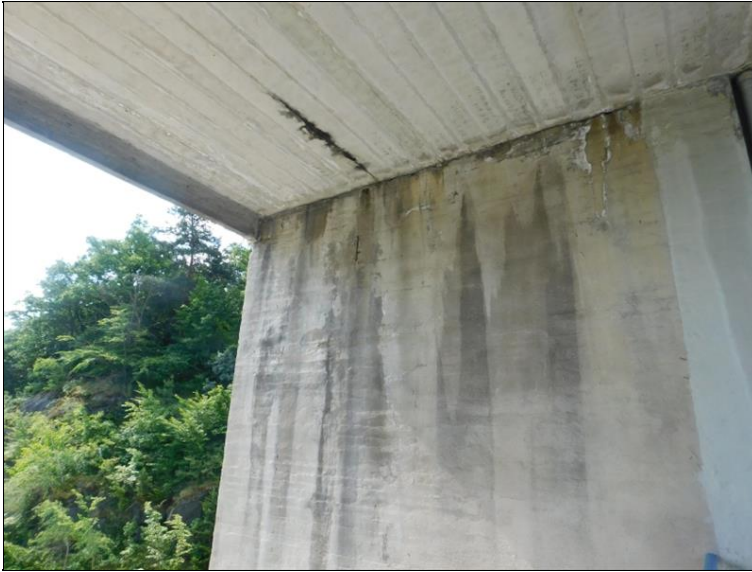
Pilíř P14 - silné průsaky v úložné spáře a lokálně i sparách mezi nosníky
