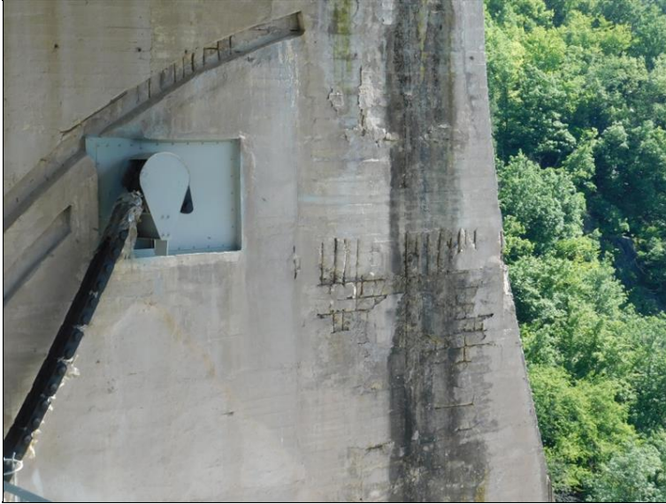
Pilíř P8 - silné průsaky na levou část pilíře přes úložné prahy, plošně odpadá krycí vrstva, plošná koroze betonářské výztuže
