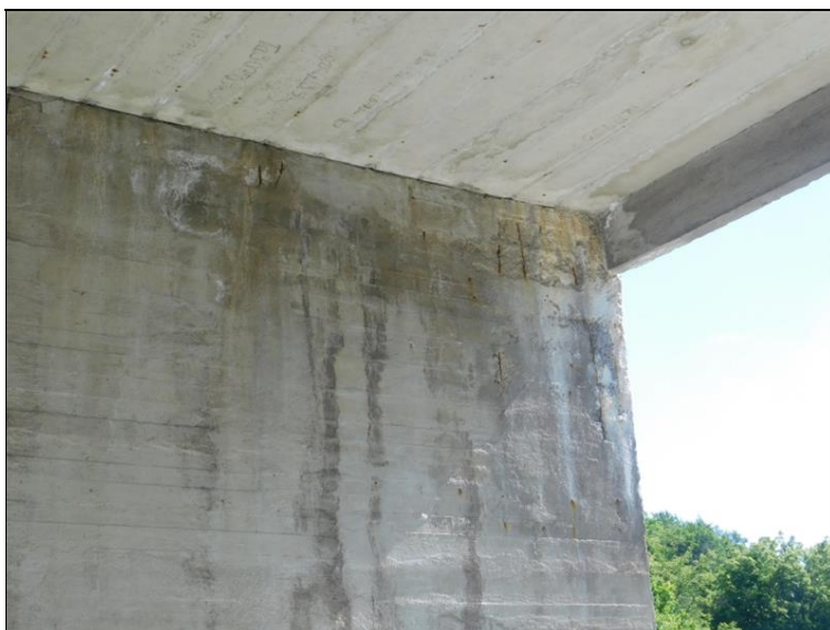
Pole 6 - silné průsaky s výluhy v místě úložné spáry
