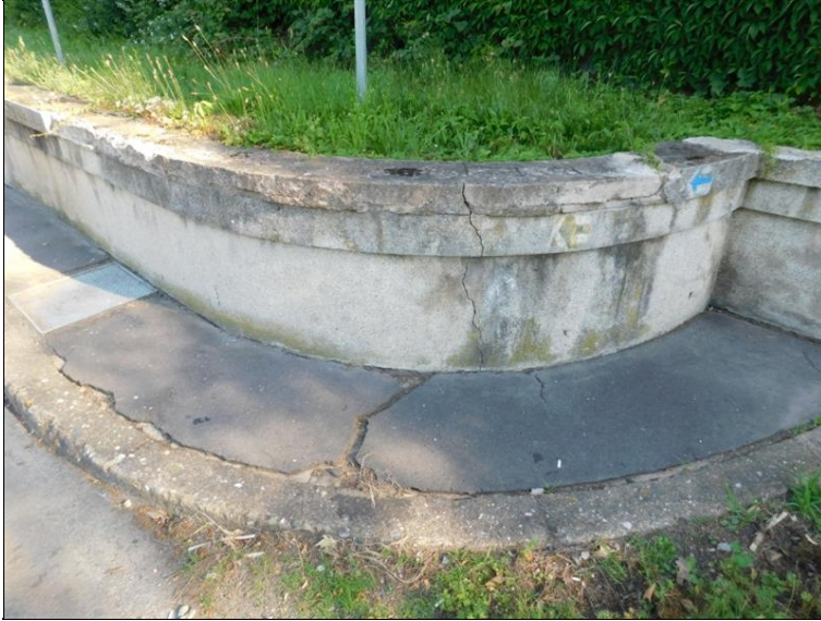
Trhlina ve zdi na předmostí u opěry OP1 š. 5 mm
