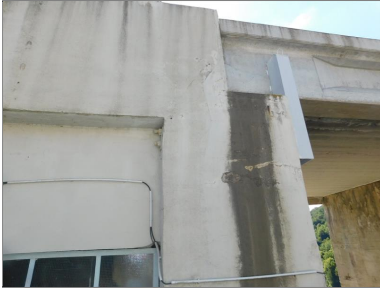
Pilíř P3 - stopy po silném zatékání na pravém boku pilíře
