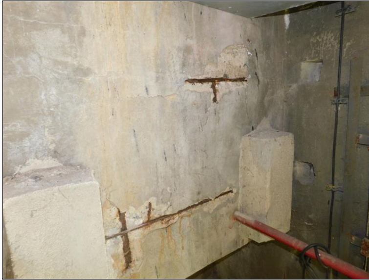
Strojovna 11b - degradace betonu, koroze betonářské výztuže
