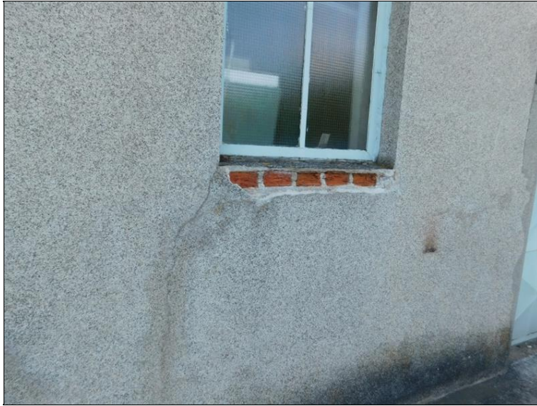
Pole 16 - uražená hrana omítky u okenního otvoru
