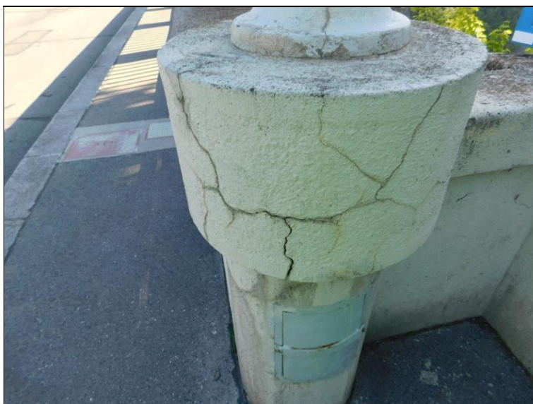
Síťové trhliny v sanaci madla zábradlí
