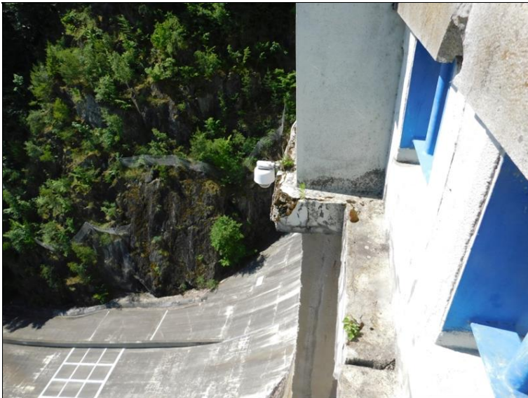
Rozpad hrany betonové římsy v místě kotevního bloku stožáru osvětlení
