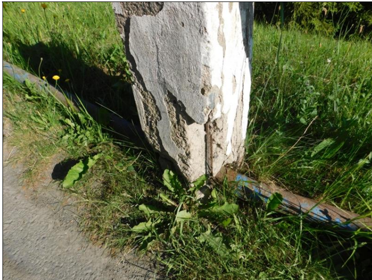
Detail hloubkové degradace sloupku na předmostí za opěrou OP18, koroze přerušena betonářská výztuž
