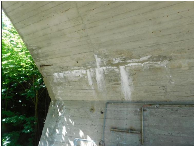
Pole 17 - silnější průsaky s výluhy ve větknutí klenby do opěry OP18
