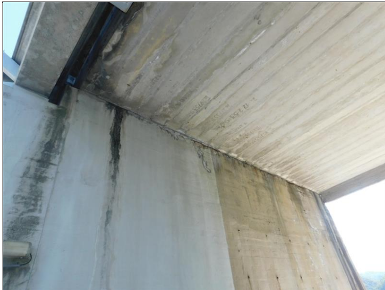
Piliř P11 - aktivní průsak do pole 11 na pravé straně úložného prahu
