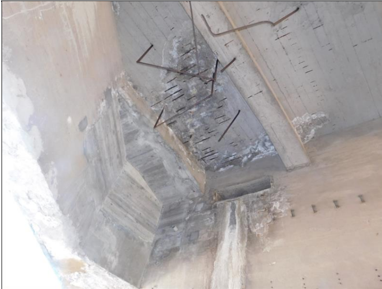
Pole 1 - silné průsaky na pravé straně nosné konstrukce, silná koroze betonářské výztuže
