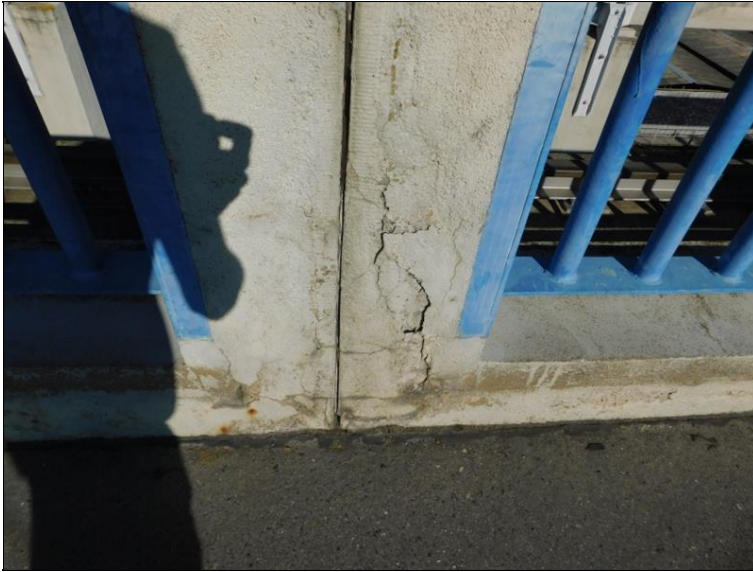
Povrchová degradace betonu stěn zábradlí
