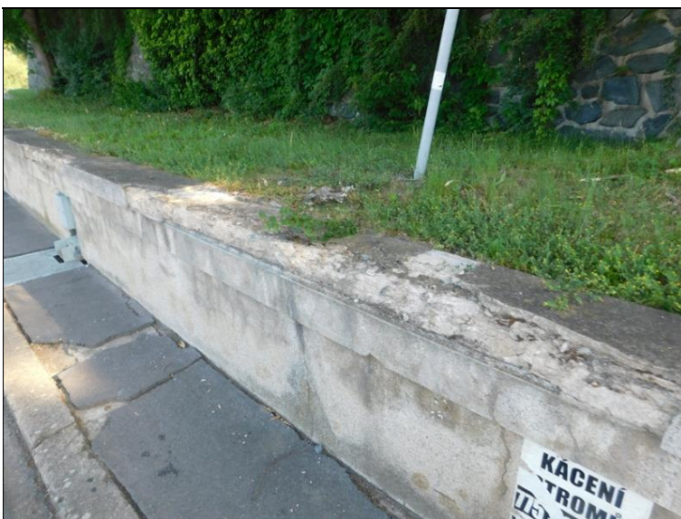
Rozpad horní části opěrné zdi na předmostí u opěry OP1
