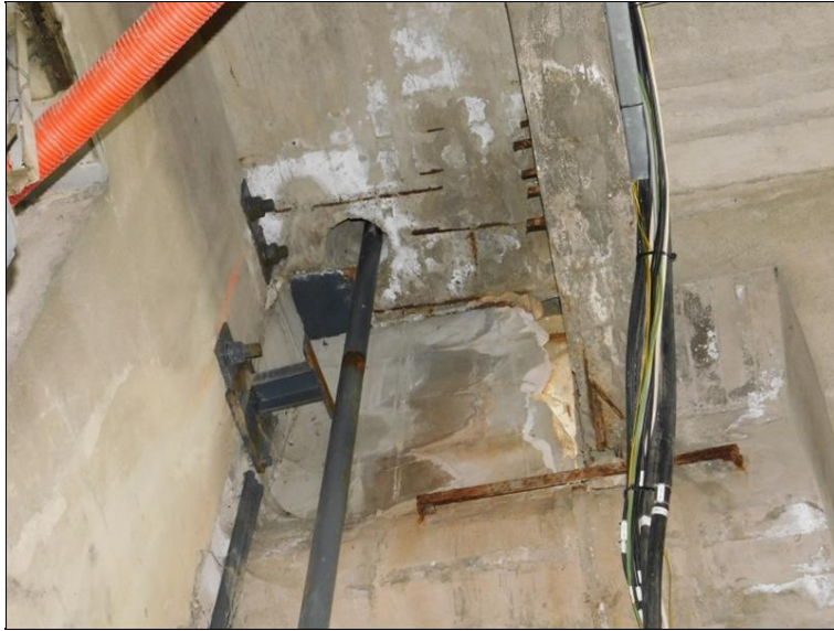
Strojovna 9b - silné průsaky a degradace betonu v místě průchodu pro transmisní tyče
