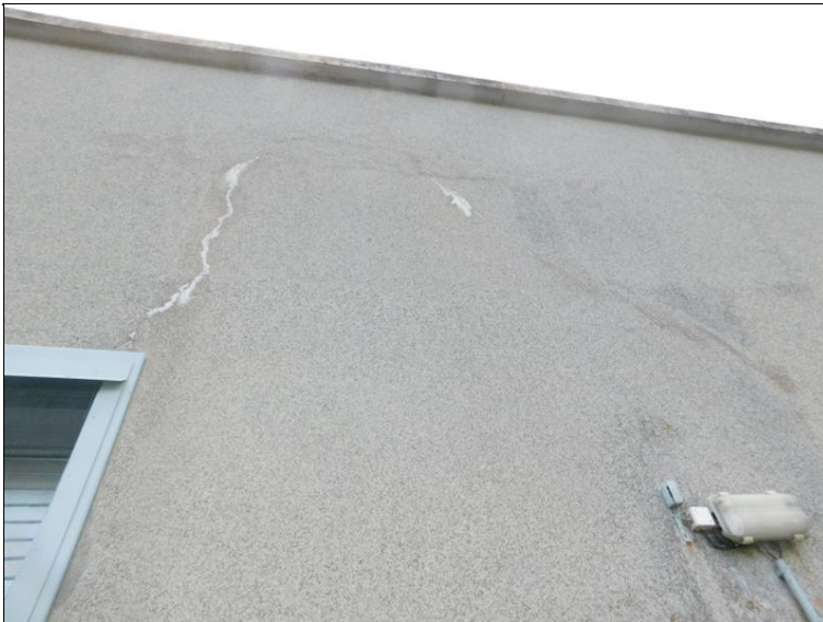
Pole 14 - šikmé trhliny se slabými výluhy na líci pravé vnější stěny
