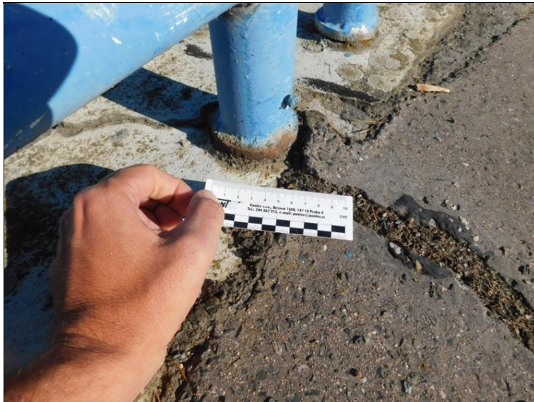
Koroze ocelového sloupku zábradlí v patě, pole 1, pravá strana
