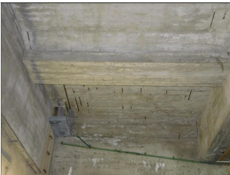
Pole 16 - plošně prokreslená betonářská výztuž na spodním líci horní desky
