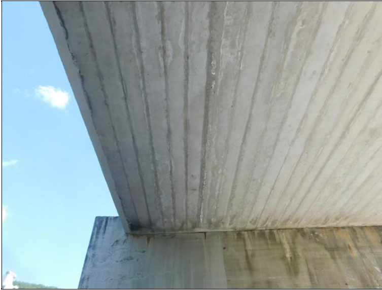
Pole 12 - spodní líc, místy slabé výluhy ve sparách mezi nosníky
