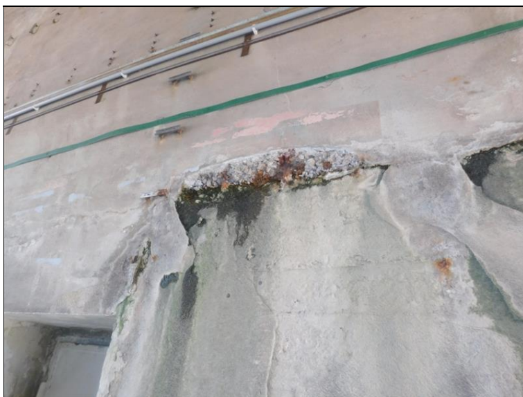
Opěra OP1 - silný průsaky v pracovní spáře opěry, degradace betonu, koroze betonářské výztuže
