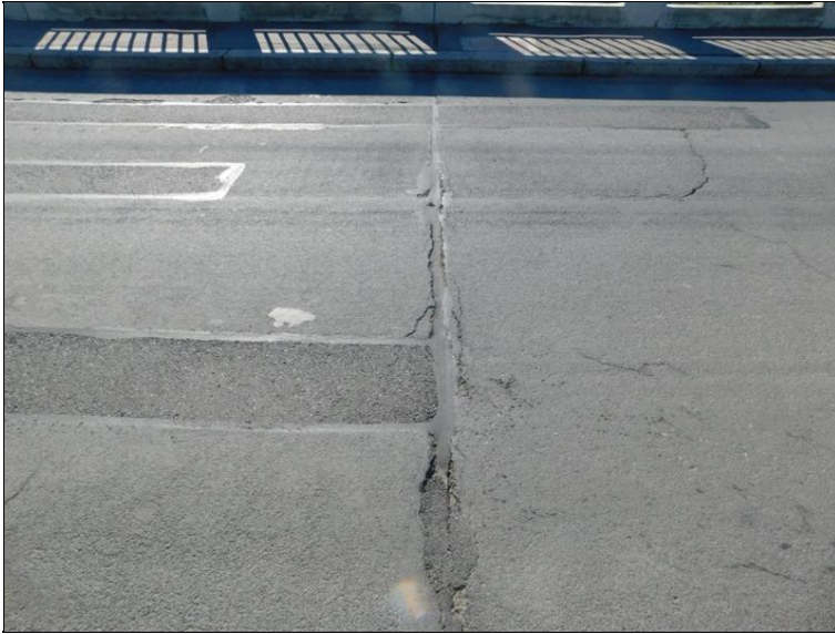
Příčné trhliny v živičném krytu vozovky
