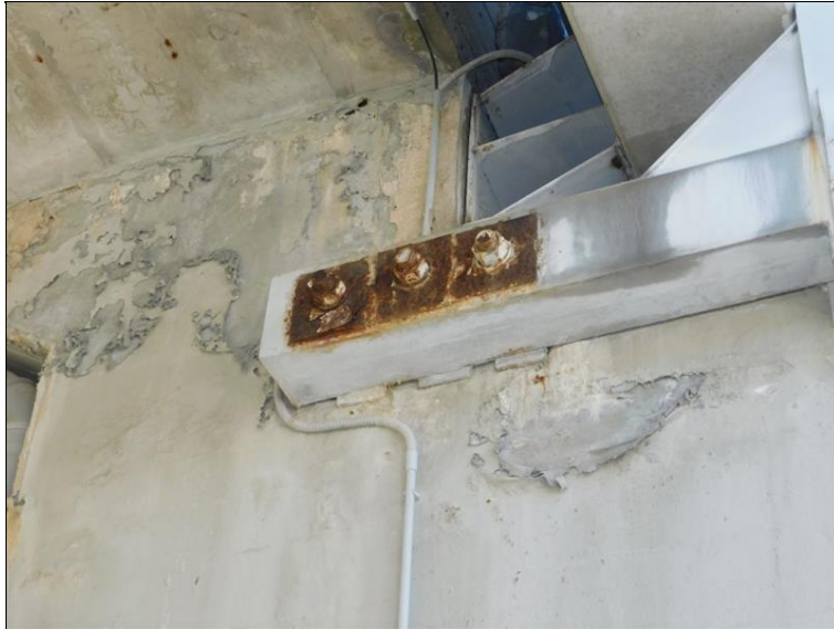
Pole 5 - silná koroze ocelového přípravku zajišťující stabilitu jeřábové dráhy
