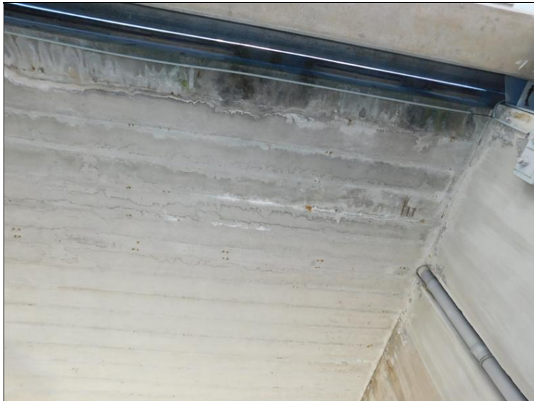
Pole 3 - silné průsaky s výluhy v krajní spáře na pravé straně nosné konstrukce
