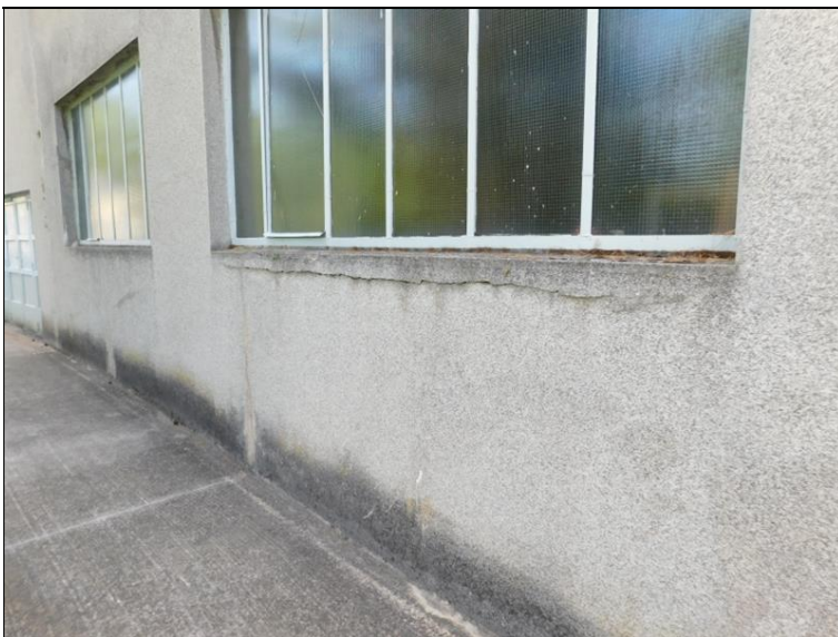
Degradace omítky v místě okenního otvoru
