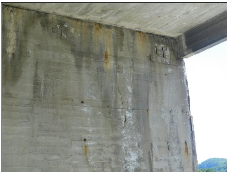
Piliř P12 - silné průsaky v místě úložné spáry, místy koroze obnažené betonářské výztuže
