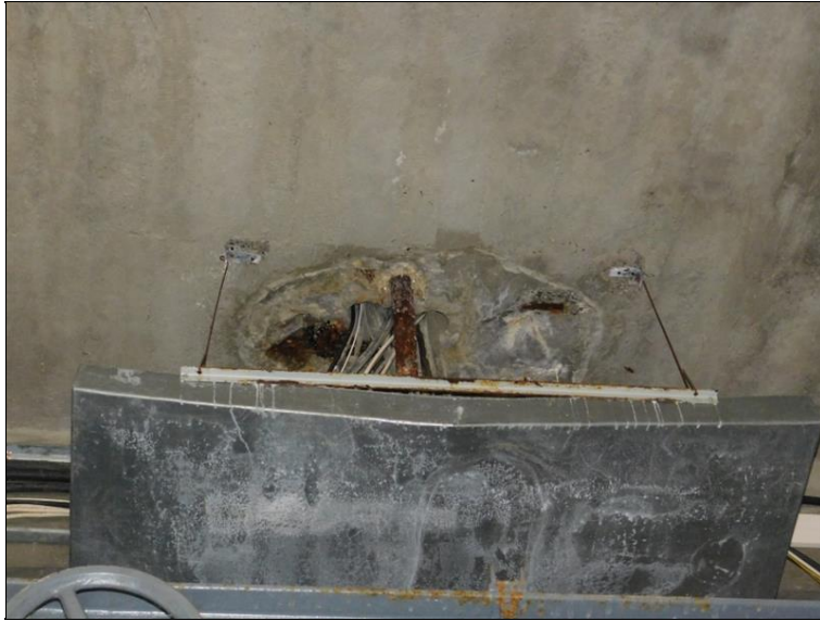
Strojovna 7b - průsaky v místě prostupu inženýrských sítí
