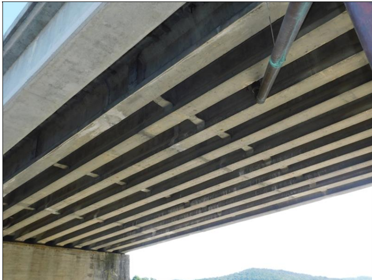
Pole 10 - stopy po průsacích v místě trhlin nosné konstrukce, trhliny kopírují vedení předpínací výztuže
