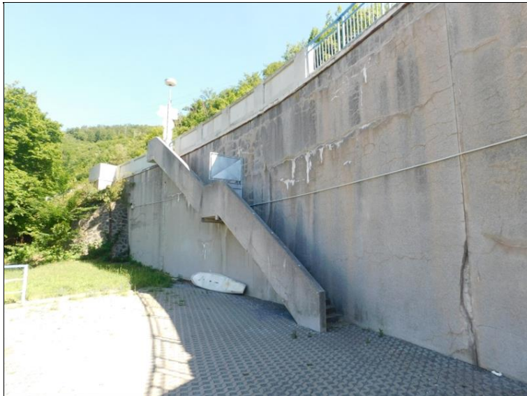
Opěra OP1 - pravé křídlo, plošné síťové trhliny, silný výluh ve vodorovné trhlíně
