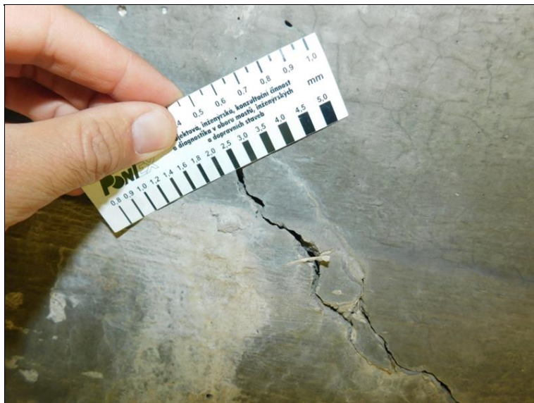
Strojovna 7b - šikmá trhliny na líci povodní stěny, detail šířky trhliny 2,5 mm
