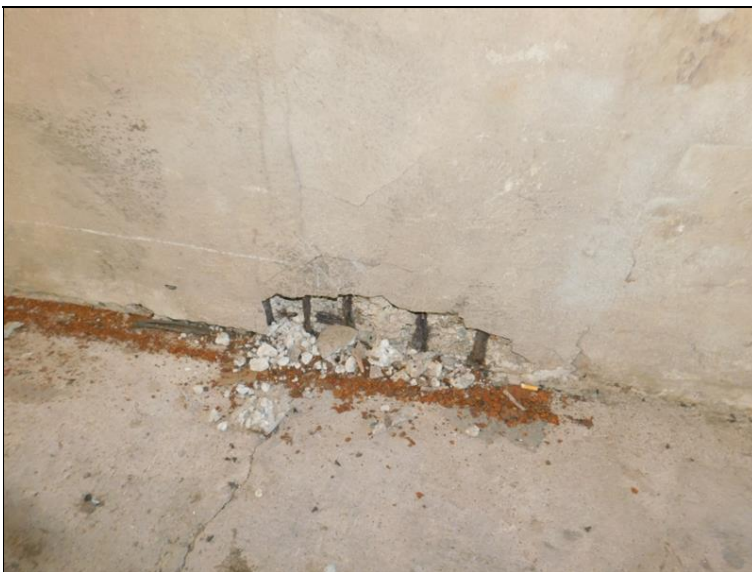
Pilíř P2 - koroze betonářské výztuže v patě
