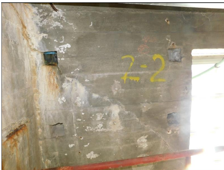
Strojovna 7b - šikmá trhliny na líci povodní stěny
