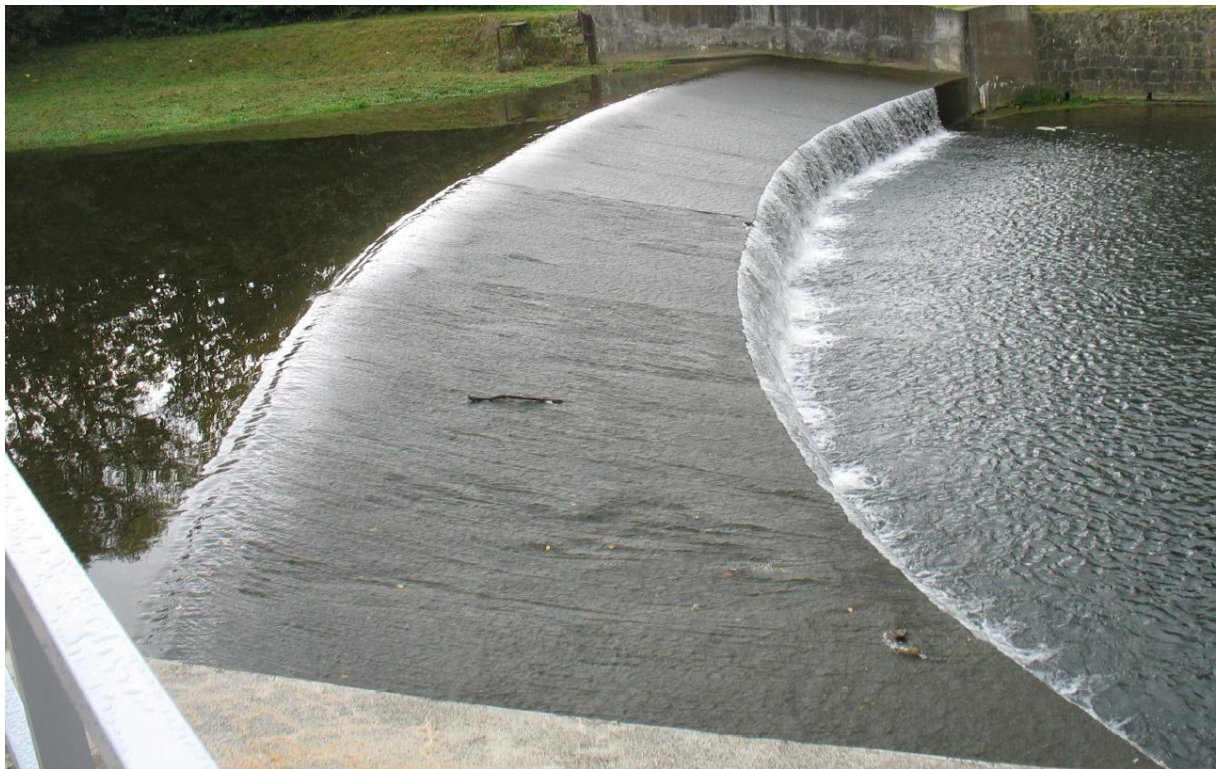
poškozená přelivná hrana
