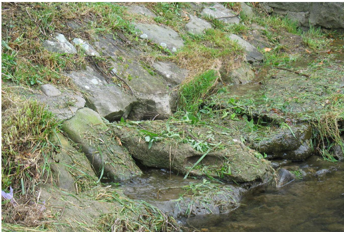
výron vody z dlažeb v podjezí na PB
