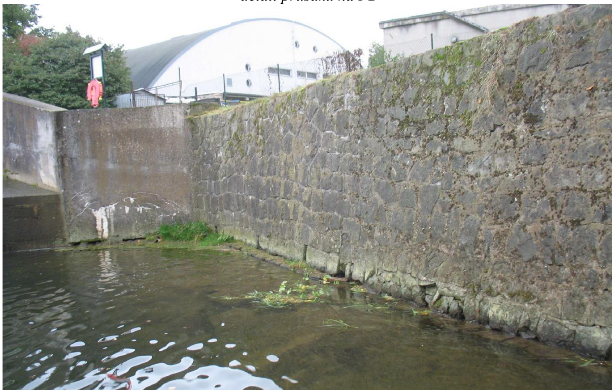
poškozené spárování na LB v podjezí
