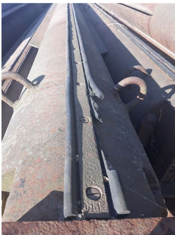
Foto č.2 – těsnící profil a přítlačná lišta
