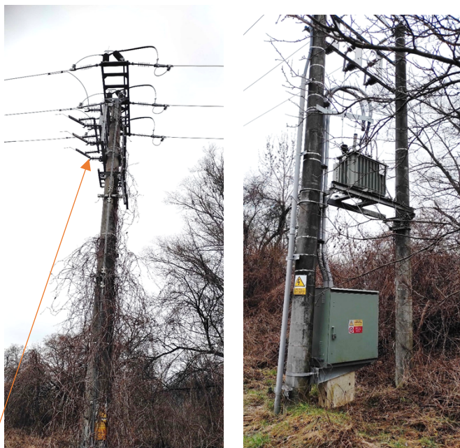
Svislý odpínač na stožáru pro napojení kabelové vn přípojky – stav 26.1.2023
