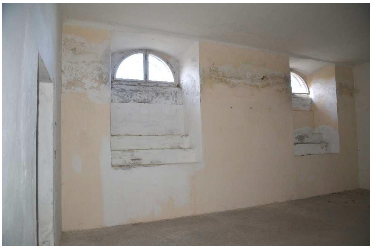
Obrázek 5 Budoucí expozice - nevyhovující suterénní prostory, vlhké zdivo
