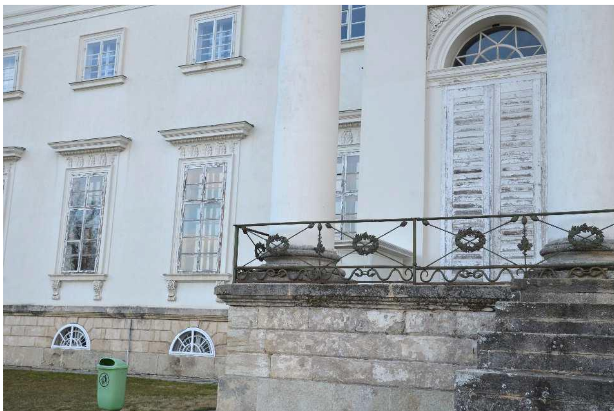
Obrázek 6 Nevyhovující stav oken v 1. PP (budou repasována), proveden okapový chodník
