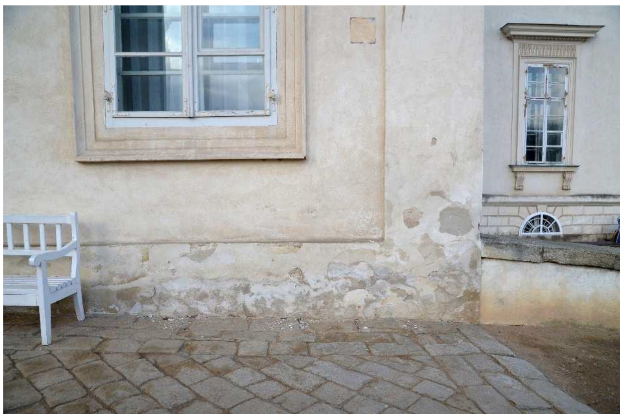
Obrázek 7 Nevyhovující stav soklové části fasády - omítky, hlavní budova zámku
