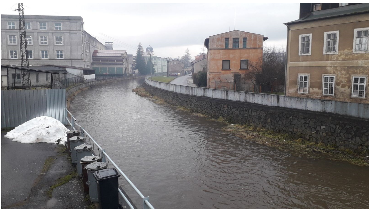
Poškozená ochranná zeď
