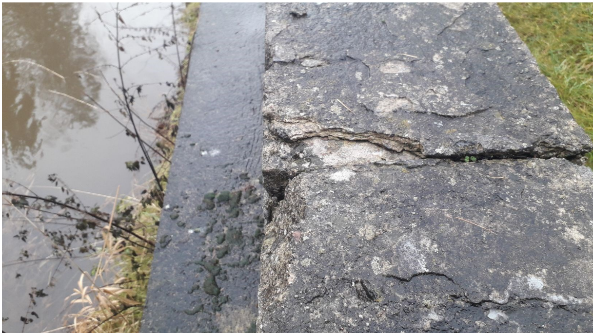
Poškození ochranné zdi
