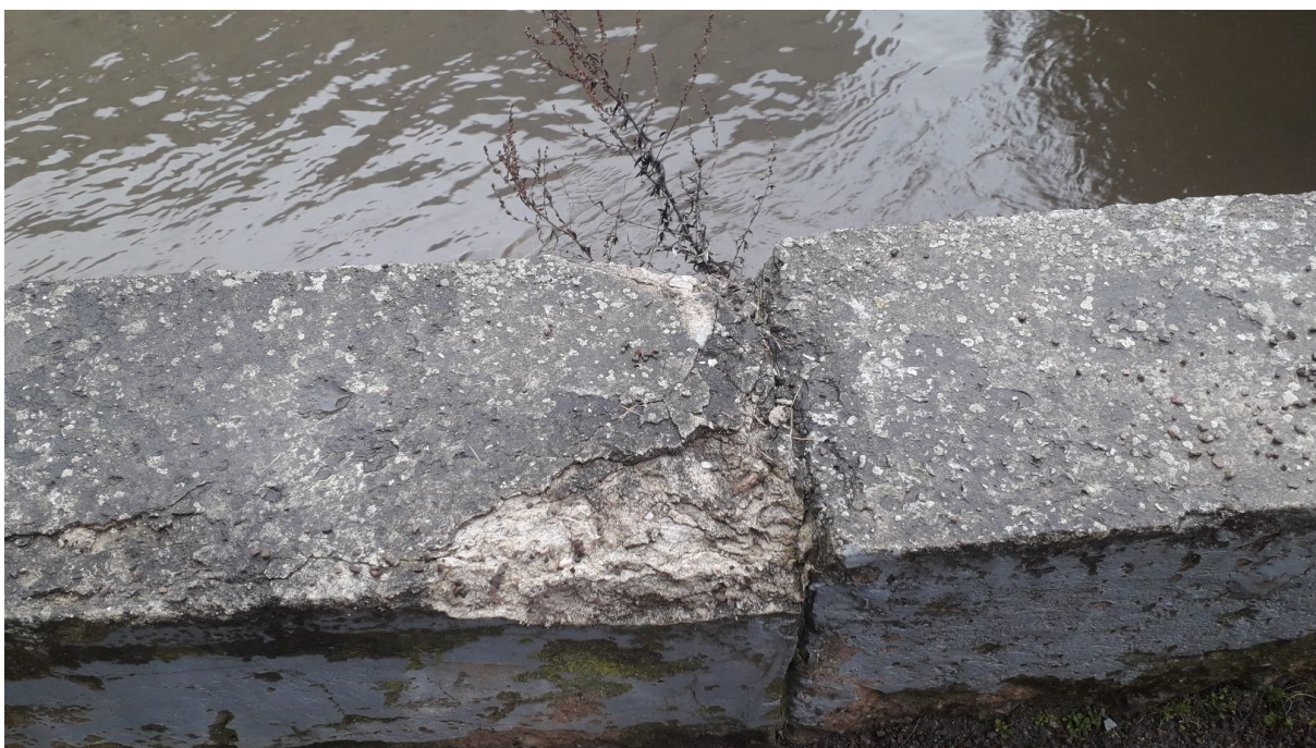
Poškození ochranné hrázky
