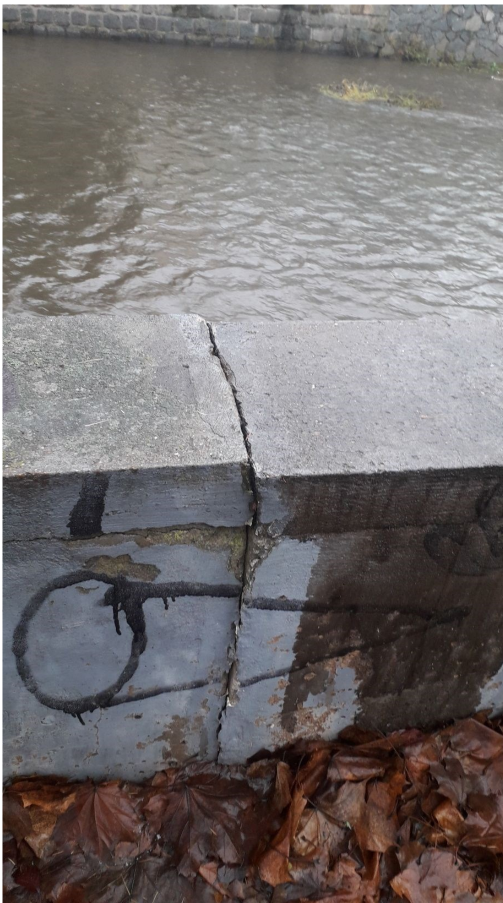
Poškození ochranné hrázky
