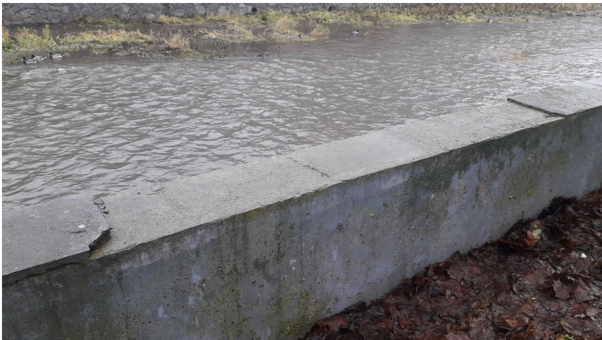
Poškození ochranné zdi
