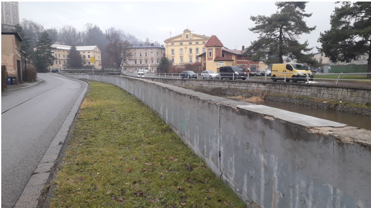
Poškození ochranné zdi
