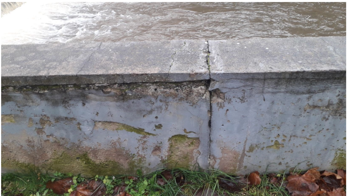
Poškození ochranné zdi
