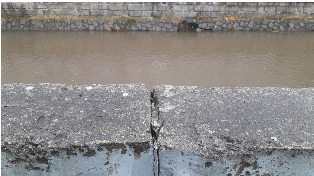
Poškození ochranné zdi
