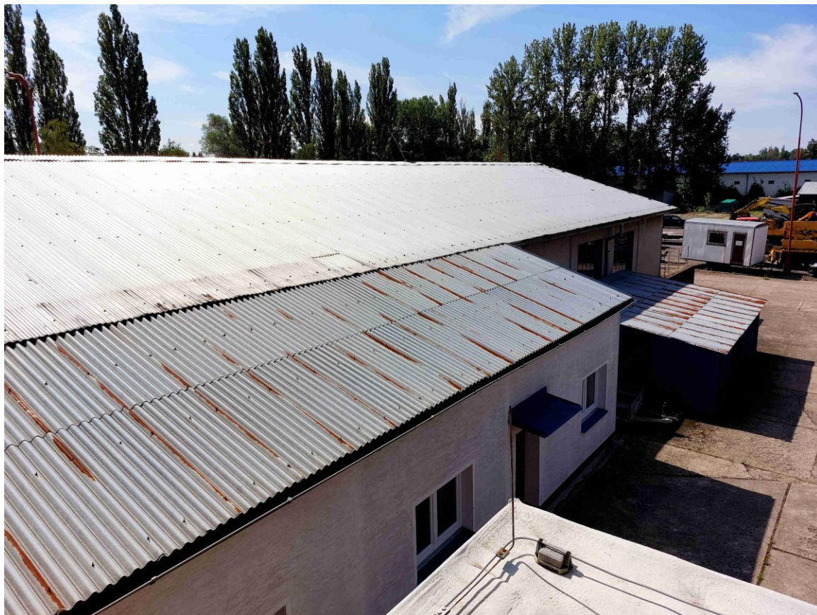
Celkový pohled na střechu s patrnými známkami rzi
