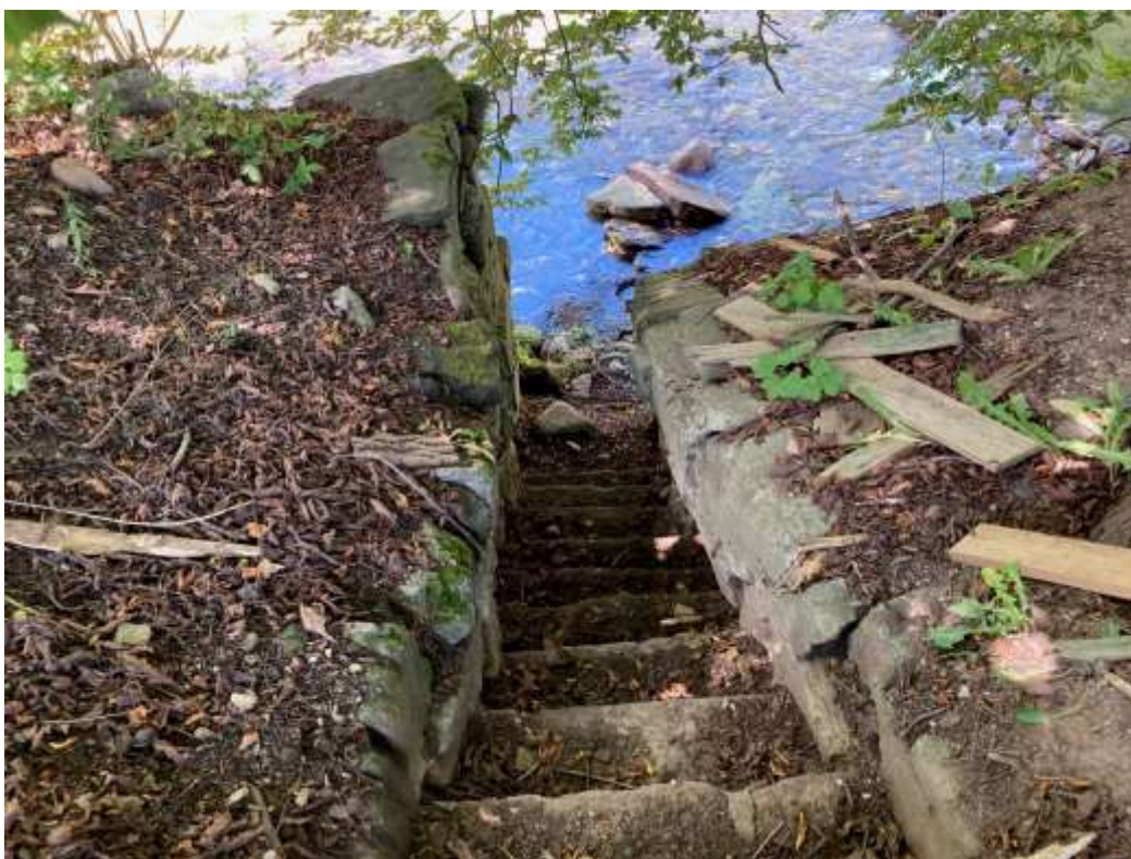
obrázek 4: poškozené schodiště v dolní části úseku LB zdi
