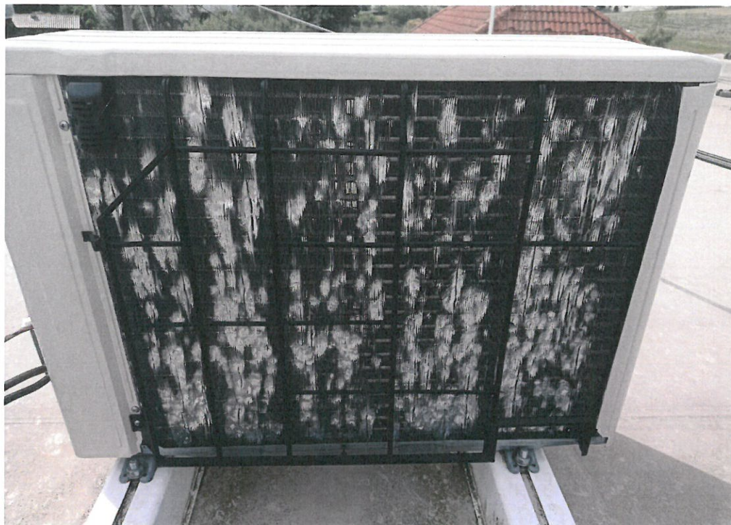
Venkovní jednotky poškozené krupobitím
