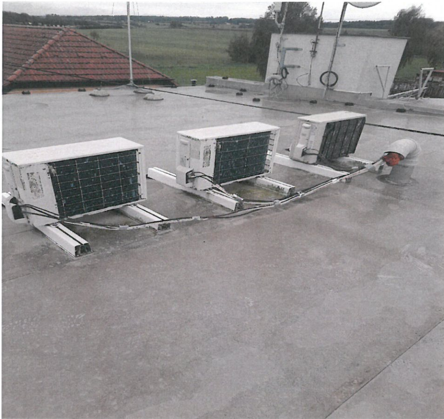
Poškozené jednotky Sinclair 2x a Mitsubishi MUZ-HR25VF
