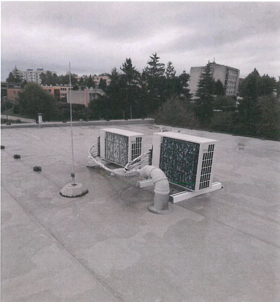
Poškozené jednotky Fujitsu General A0YG30LAT4 a A0YG25LAT3
