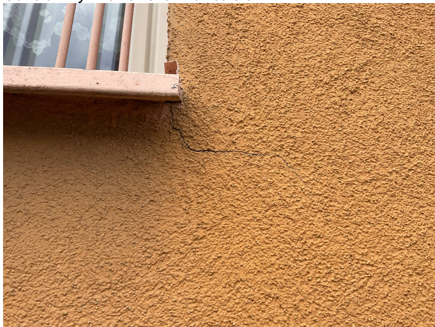
Obr.3-trhliny v úrovni parapetů
