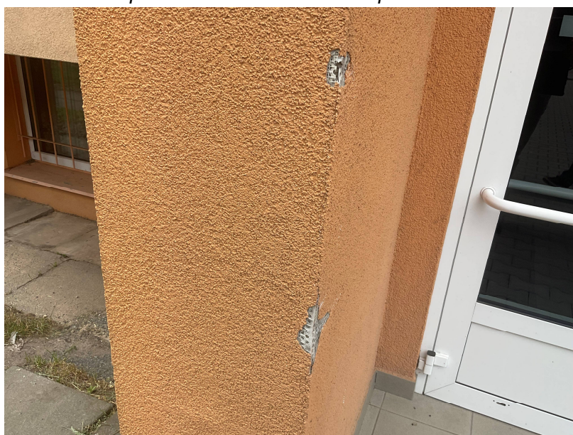
Obr.5-lokální poškození na nároží u vstupu
