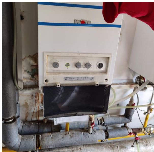
Kotle v podkroví
