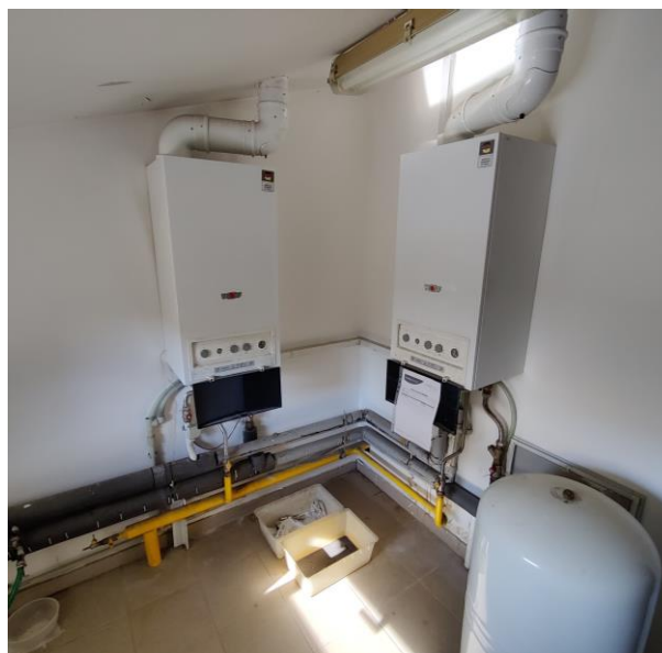
Kotle v podkroví
