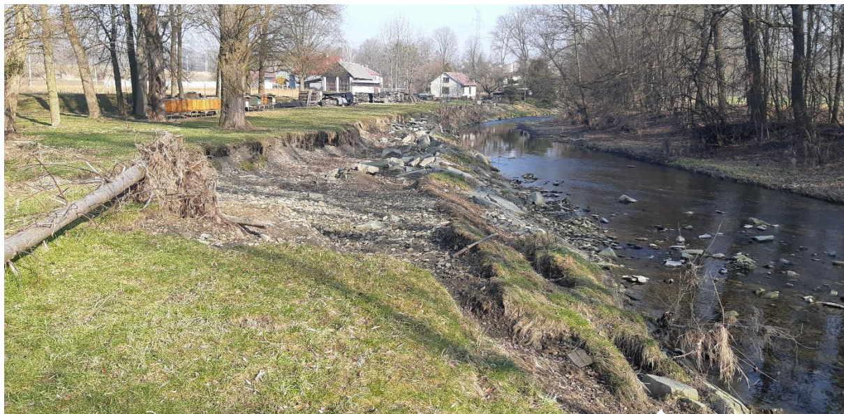
Pravobřežní břehová nátrž – pohled z PB proti vodě
