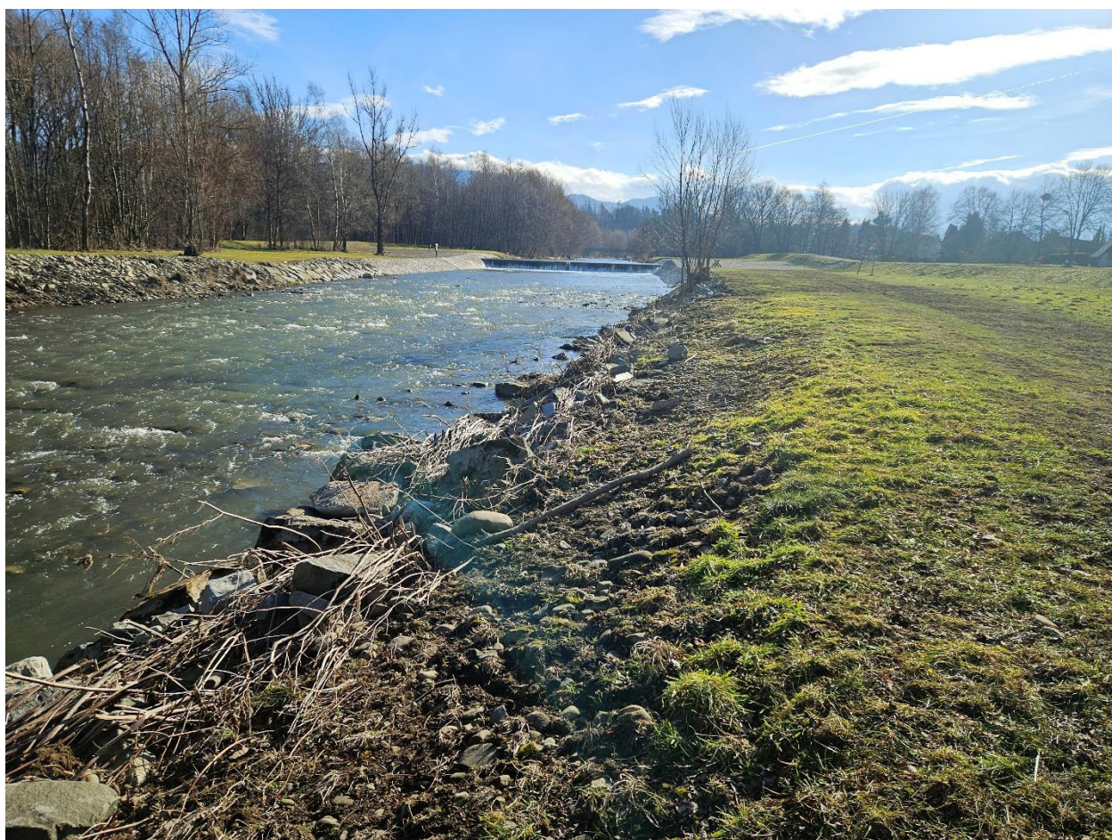
Ř. km. cca 33,900 – poškozený LB zához z lomového kamene + břehový LB výmol nad opevněním
