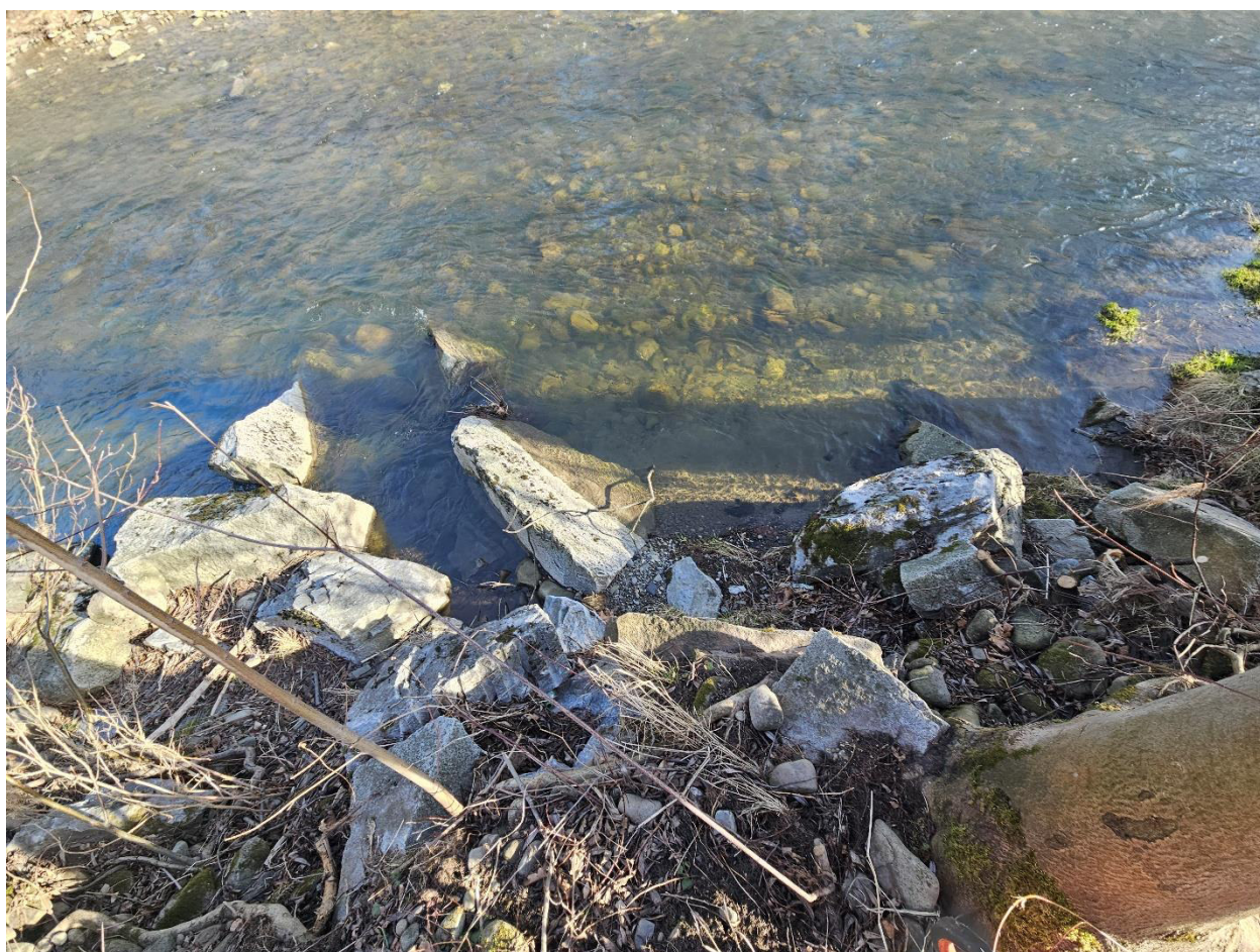
Ř. km. cca 33,800 – poškozený LB zához z lomového kamene
