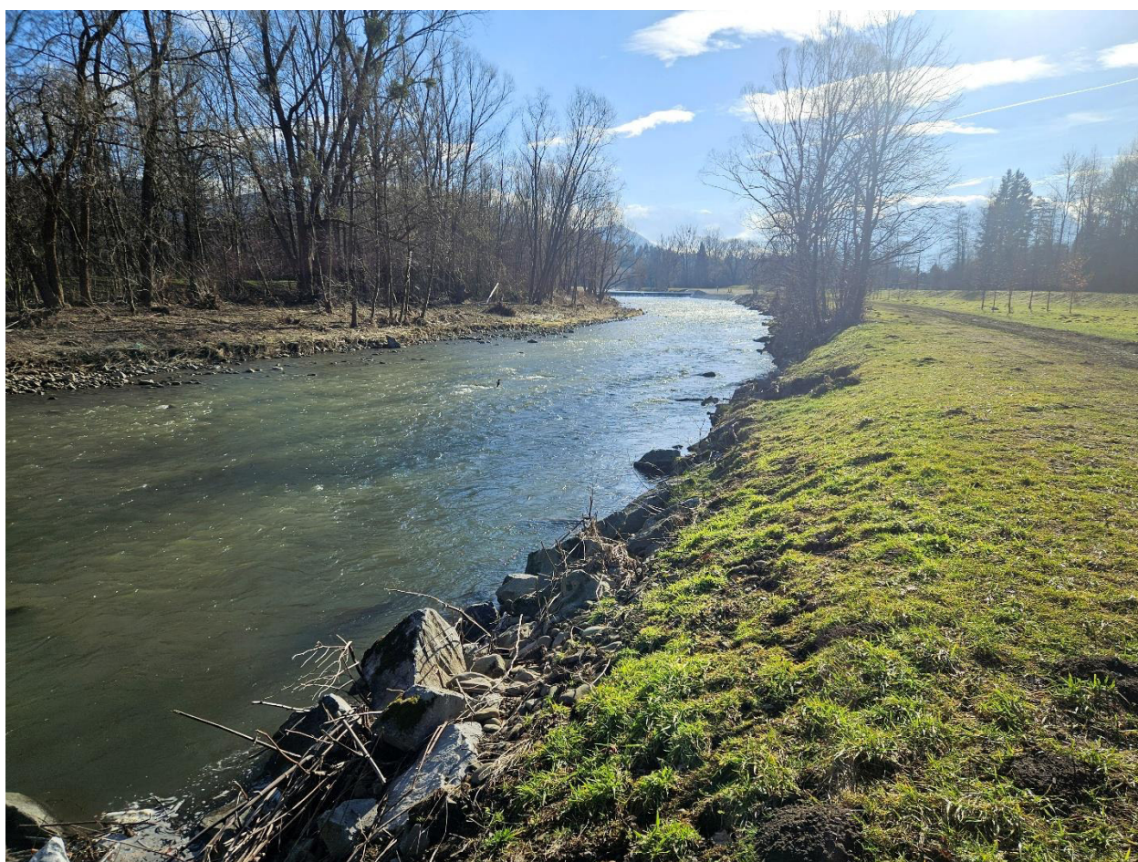
Ř. km. cca 33,750 – poškozený LB zához z lomového kamene
