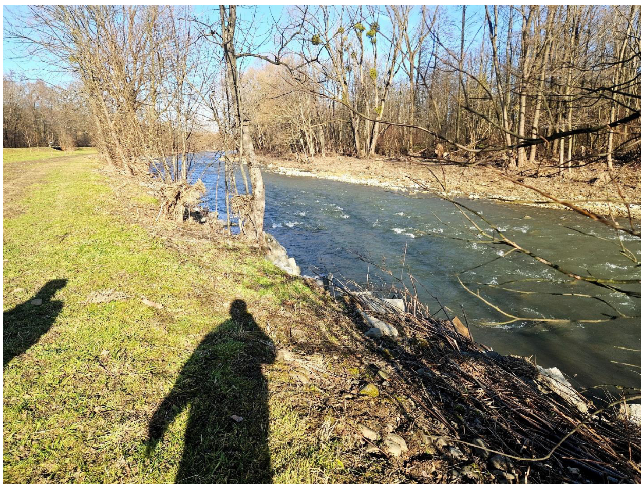
Ř. km. cca 33,875 – poškozený LB zához z lomového kamene
