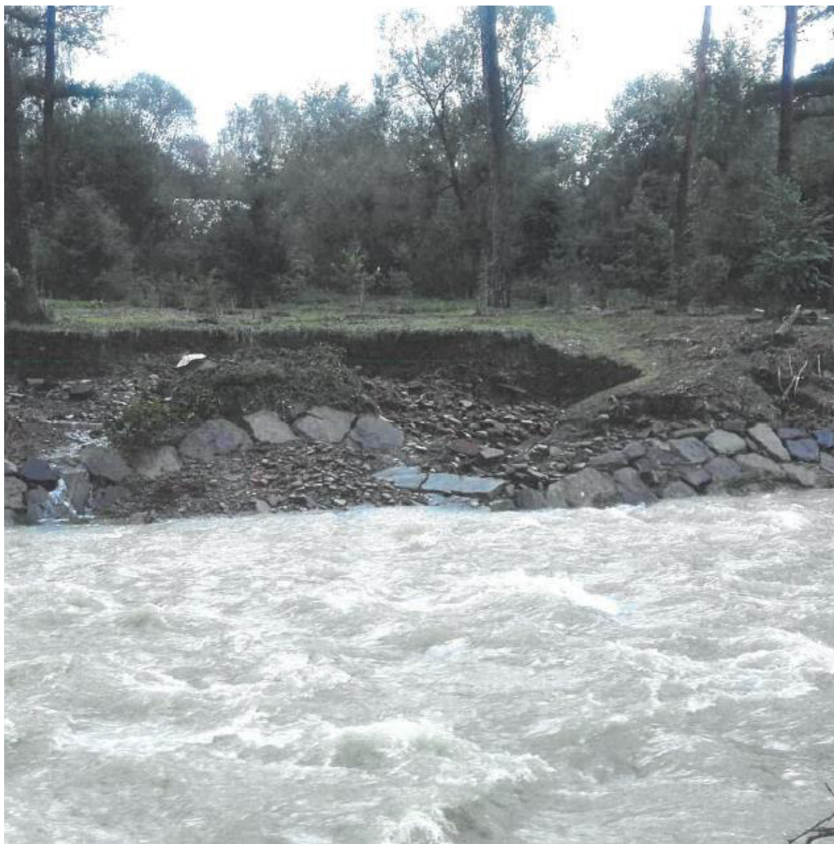
Obr.č.3 Poškozené opevnění
