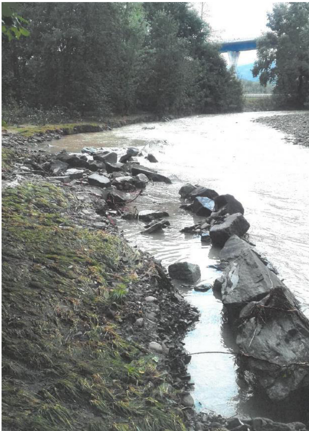
Obr.č.2 Výtrž na levém břehu a poškozené opevnění
