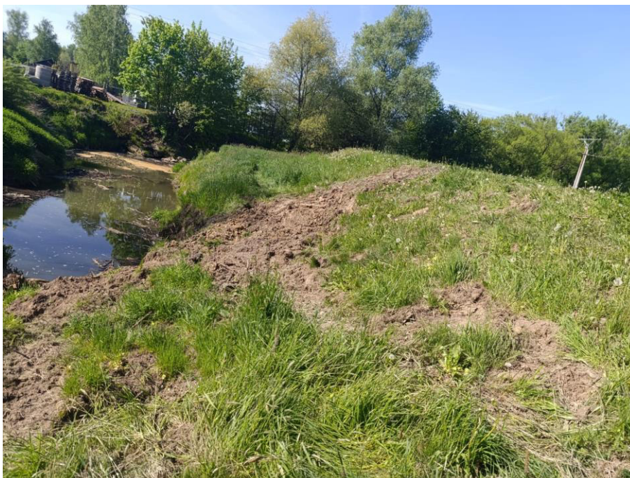
Pravobřežní břehová nátrž, poškozené meziprázky – pohled z PB po vodě
