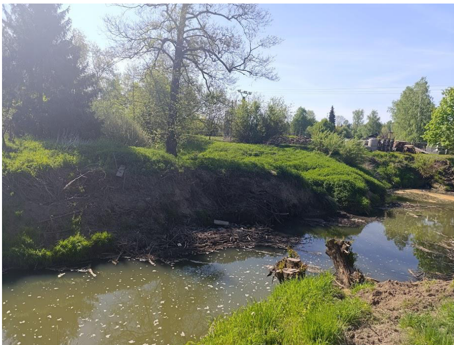
Levobřežní břehová nátrž – pohled z PB po vodě
