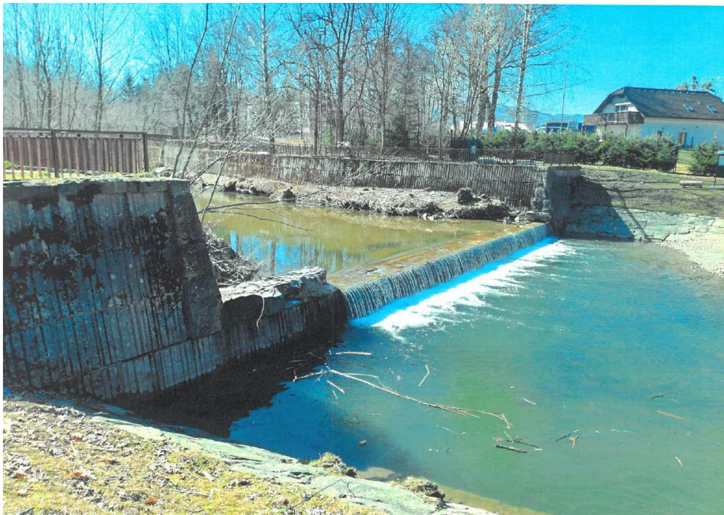
Pohled na poškozený přeliv z PB protivodně.
