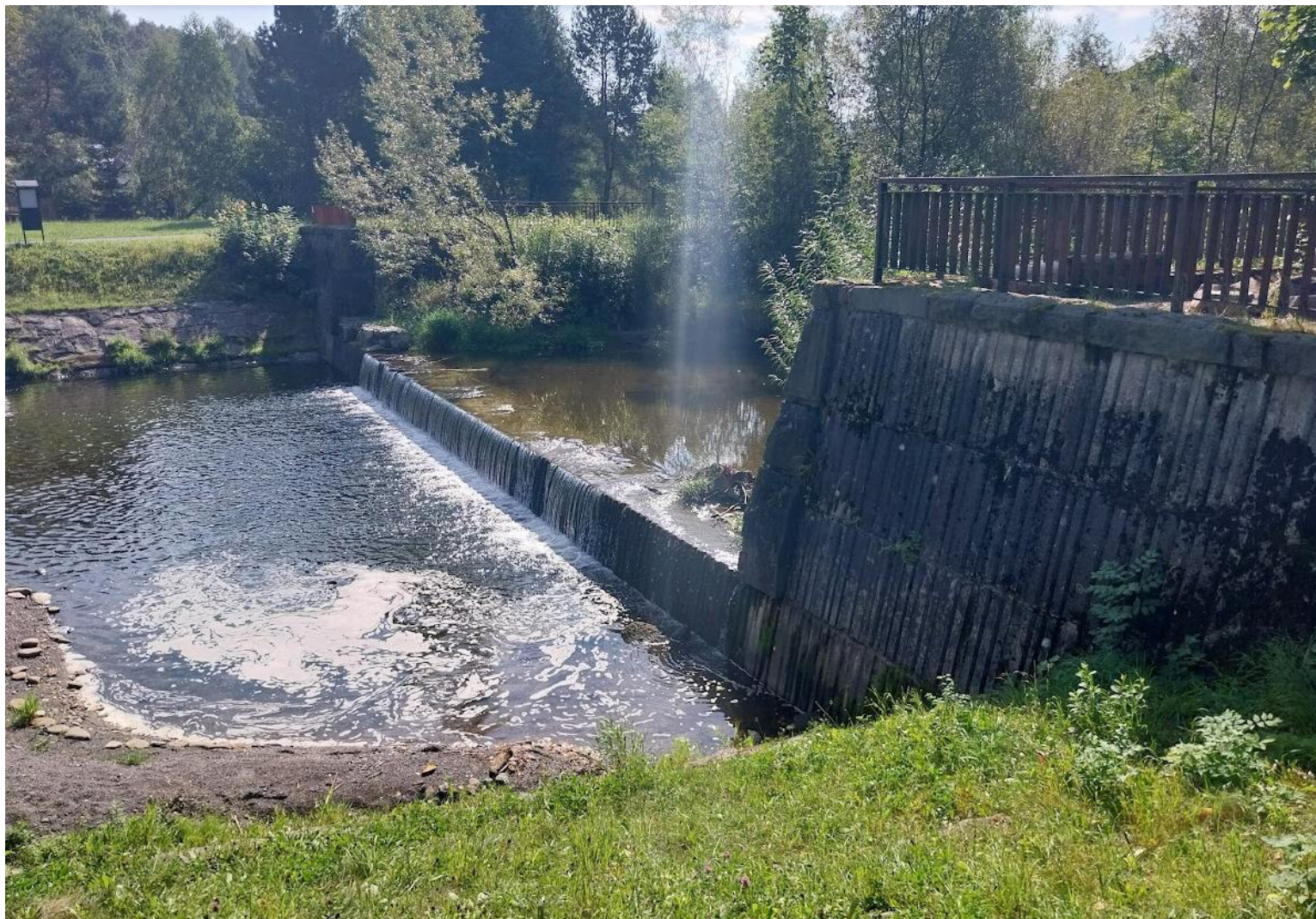
Pohled na poškozený přeliv z LB protivodně
