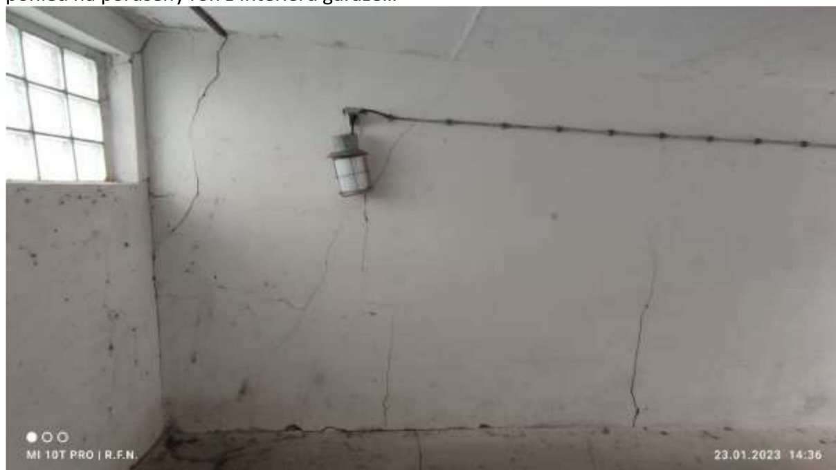
pohled na porušený roh z interiéru garáže...
