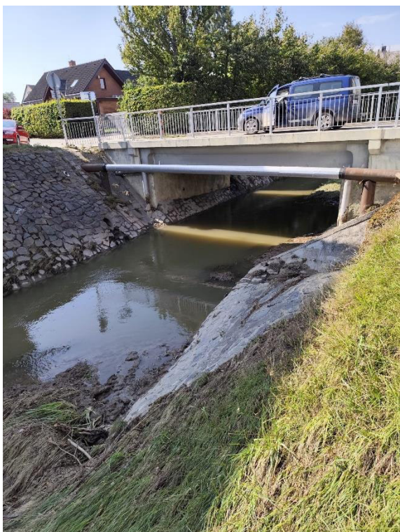
obrázek č. 3 – chybějící část manipulačního pásu a opevnění VT Porubka, k.ú. Poruba
