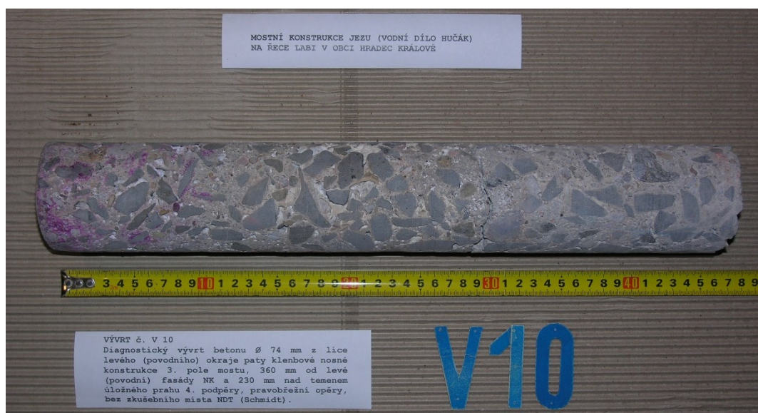
Obr. G86-110 VÝVRT č. V10. Diagnostický vývrt betonu Ø 74 mm z líce levého (povodního) okraje paty klenbové nosné konstrukce 3. pole mostu, 360 mm od levé (povodní) fasády NK a 230 mm nad temenem úložného prahu 4. podpěry, pravobřežní opěry, bez zkušebního místa NDT (Schmidt).
