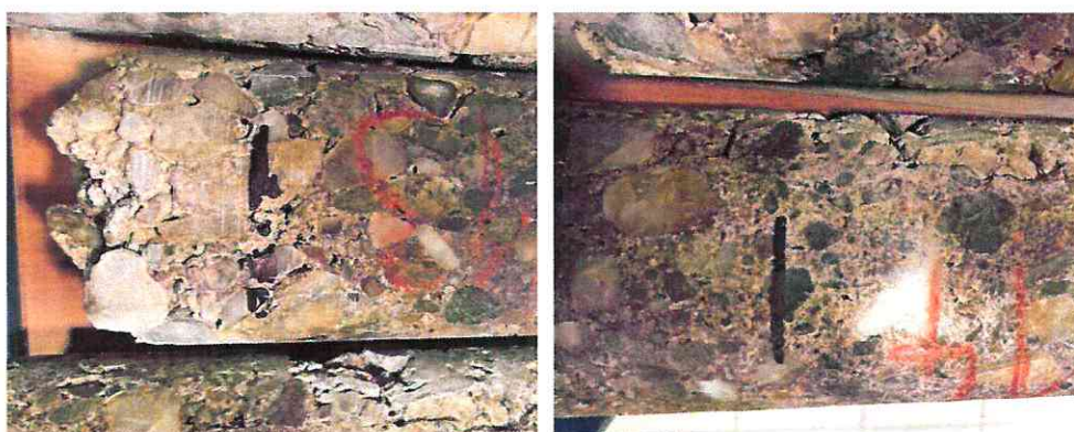
Obr. 3: Detailní pohled na části jádrových vývrtů odebraných z výklenků, ve kterých je beton v důsledku nedostatků při jeho ukládání (zejména nedostatečné hutnění) silně porézní.
