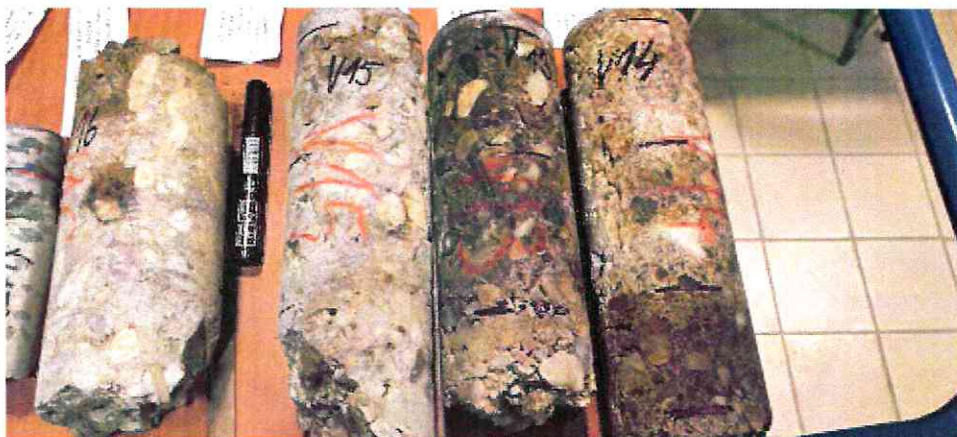
Obr. 2: Pohled na jádrové vývrtky V14 až V16. Vývrtky byly odebrány z výklenků podpěr. Beton je v některých částech vývrtů značně porézní. U některých vývrtů je patrná kontaminace betonu pravděpodobně ropnými látkami (oleji). Stanovení míry kontaminace betonu ropnými látkami nebylo součástí zadání tohoto posouzení.
