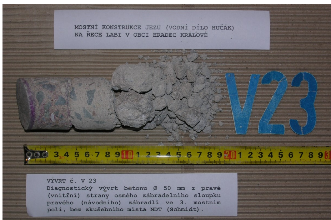
Obr. G86-123 VÝVRT č. V23. Diagnostický vývrt betonu Ø 50 mm z pravé (vnitřní) strany osmého zábradelního sloupku levého (návodního) zábradlí ve 3. mostním poli, bez zkušebního místa NDT (Schmidt).
