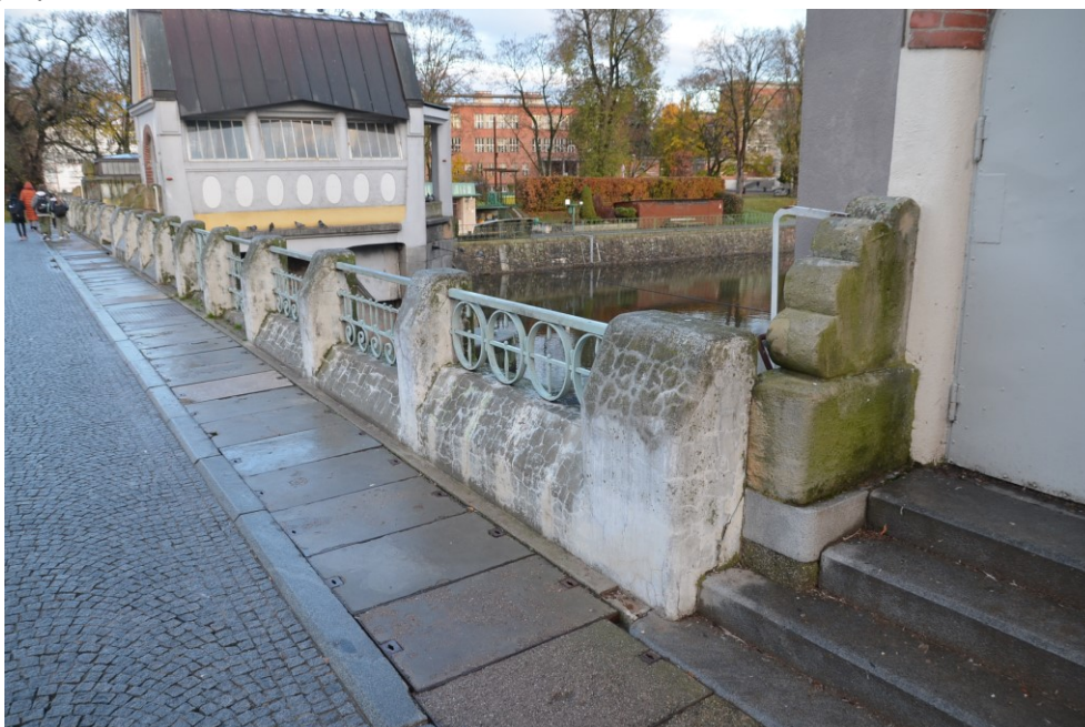
Obr.G86-34 Pravostranné mostní zábradlí druhého pole. Pohled zleva doprava (proti vodě) a ve směru staničení,
