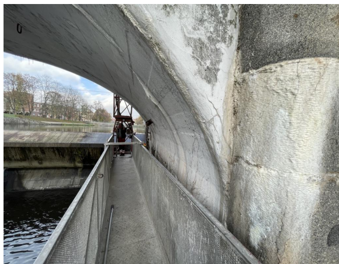
IMG_3879 - pole 2 - obecně se na sanovaném povrchu nosné konstrukce vyskytují množství nepravidelných thlin, četné výluhy, stopy po zatékání, povrchy spíše soudržné (na poklep nejsou duté)
