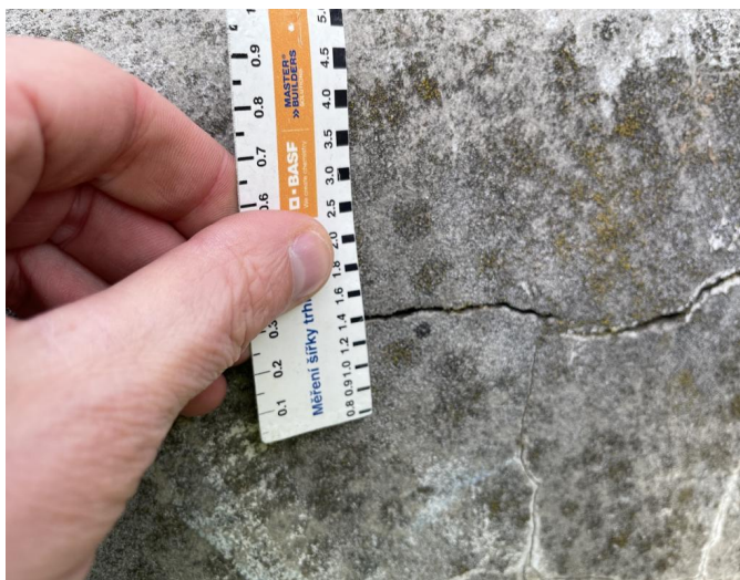
IMG_3996 - obecně se sanovaném povrchu zábradelních sloupků vyskytuje množství nepravidelných thlin, četné výluhy, stopy po zatékání, povrchy spíše soudržné (na poklep nejsou duté)
