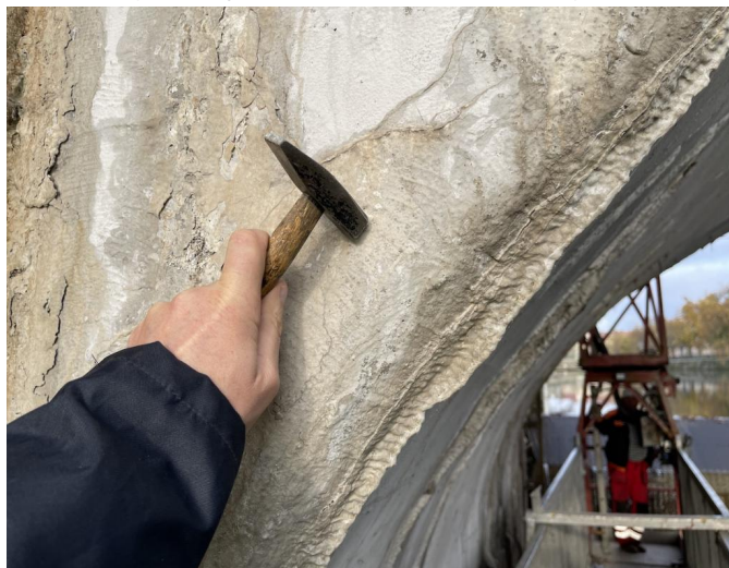
IMG_4045 - pole 3 - obecně se na sanovaném povrchu nosné konstrukce vyskytují množství nepravidelných thlin, četné výluhy, stopy po zatékání, povrchy spíše soudržné (na poklep nejsou duté)
