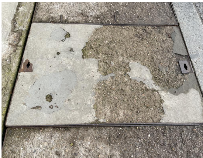
IMG_4003 - některé krycí desky kabelového kanálku vpravo degradují, trhliny
