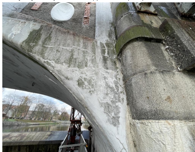
IMG_3878 - pole 2 - obecně se na sanovaném povrchu nosné konstrukce vyskytují množství nepravidelných tlín, četné výluhy, stopy po zatékání, povrchy spíše soudržné (na poklep nejsou duté)
