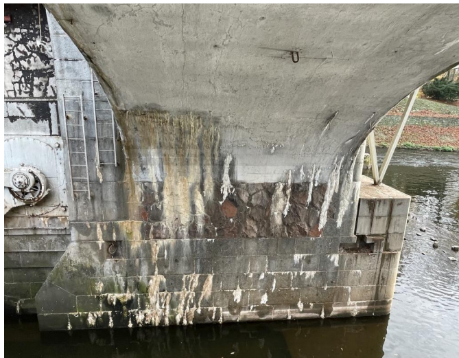
IMG_4016 - pilíř P3 - obecně se na spodní stavbě vyskytuje množství nepravidelných thlin, četné výluhy, stopy po zatékání, povrchy spíše soudržné (na poklep nejsou duté)
