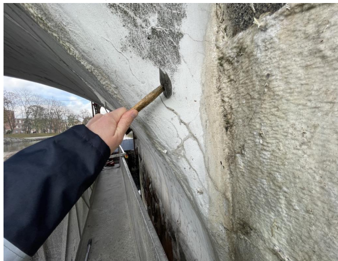
IMG_3881 - pole 2 - obecně se na sanovaném povrchu nosné konstrukce vyskytují množství nepravidelných thlin, četné výluhy, stopy po zatékání, povrchy spíše soudržné (na poklep nejsou duté)
