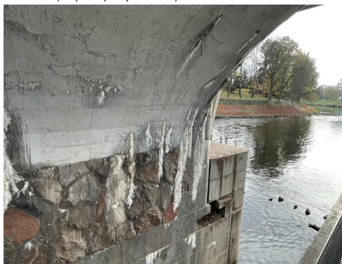
IMG_4019 - pole 3 - obecně se na sanovaném povrchu nosné konstrukce vyskytují množství nepravidelných thlin, četné výluhy, stopy po zatékání, povrchy spíše soudržné (na poklep nejsou duté)
