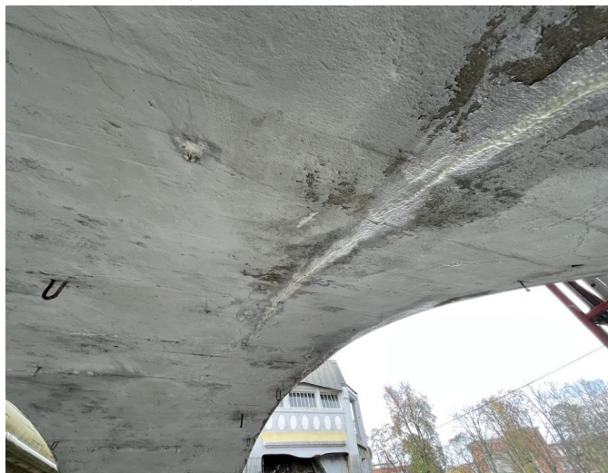
IMG_3899 - pole 2 - obecně se na sanovaném povrchu nosné konstrukce vyskytují množství nepravidelných thlin, četné výluhy, stopy po zatékání, povrchy spíše soudržné (na poklep nejsou duté)
