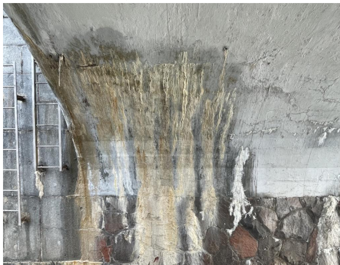
IMG_4018 - pole 3 - obecně se na sanovaném povrchu nosné konstrukce vyskytují množství nepravidelných thlin, četné výluhy, stopy po zatékání, povrchy spíše soudržné (na poklep nejsou duté)
