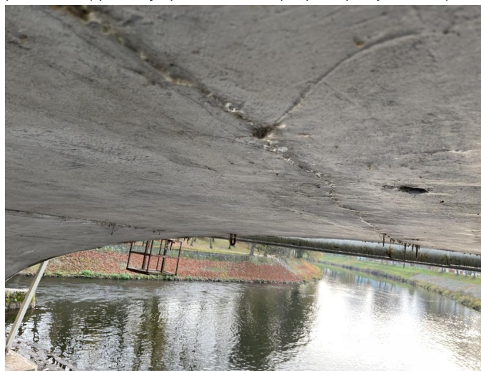
IMG_4058 - pole 3 - obecně se na sanovaném povrchu nosné konstrukce vyskytují množství nepravidelných thlin, četné výluhy, stopy po zatékání, povrchy spíše soudržné (na poklep nejsou duté)
