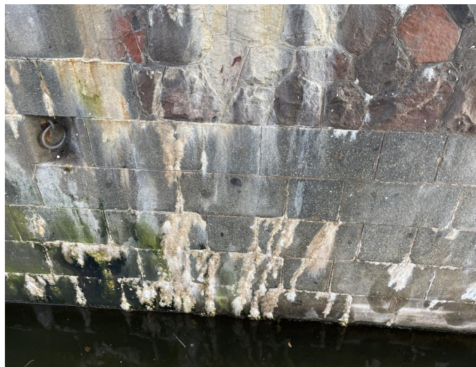
IMG_4017 - pilíř P3 - obecně se na spodní stavbě vyskytuje množství nepravidelných thlin, četné výluhy, stopy po zatékání, povrchy spíše soudržné (na poklep nejsou duté)
