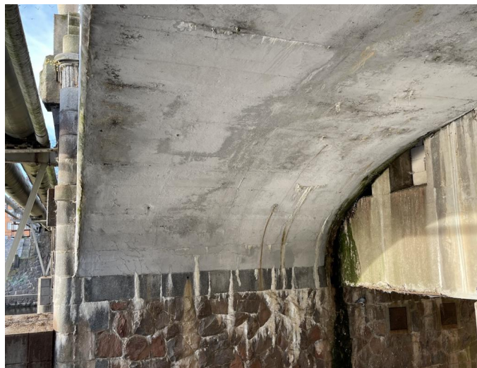
IMG_4083 - pilíř P2 - obecně se na spodní stavbě vyskytuje množství nepravidelných thlin, četné výluhy, stopy po zatékání, povrchy spíše soudržné (na poklep nejsou duté)
