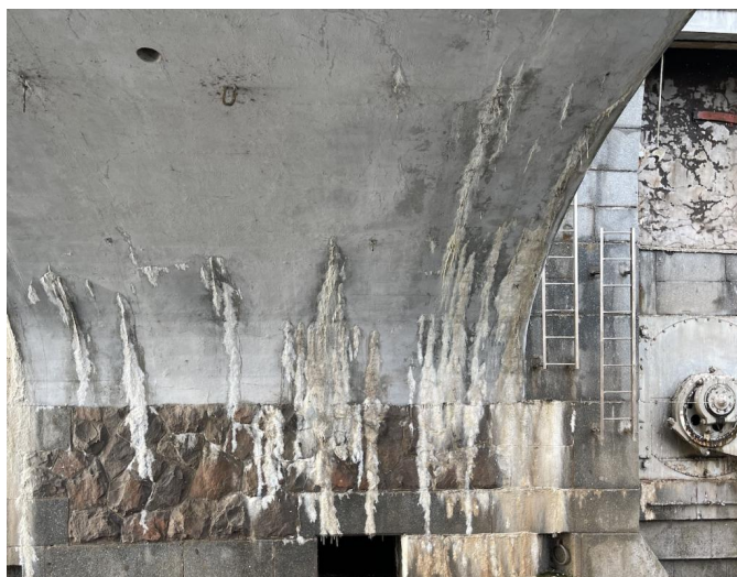
IMG_4042 - pole 3 - obecně se na sanovaném povrchu nosné konstrukce vyskytují množství nepravidelných thlin, četné výluhy, stopy po zatékání, povrchy spíše soudržné (na poklep nejsou duté)
