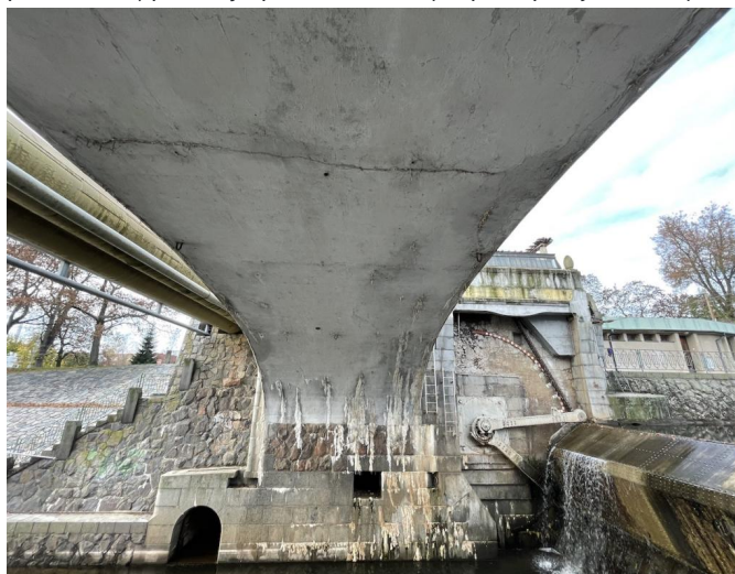
IMG_4040 - opěra O4 - obecně se na spodní stavbě vyskytuje množství nepravidelných thlin, četné výluhy, stopy po zatékání, povrchy spíše soudržné (na poklep nejsou duté)
