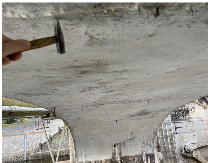
IMG_3908 - pole 2 - obecně se na sanovaném povrchu nosné konstrukce vyskytují množství nepravidelných thlin, četné výluhy, stopy po zatékání, povrchy spíše soudržné (na poklep nejsou duté)
