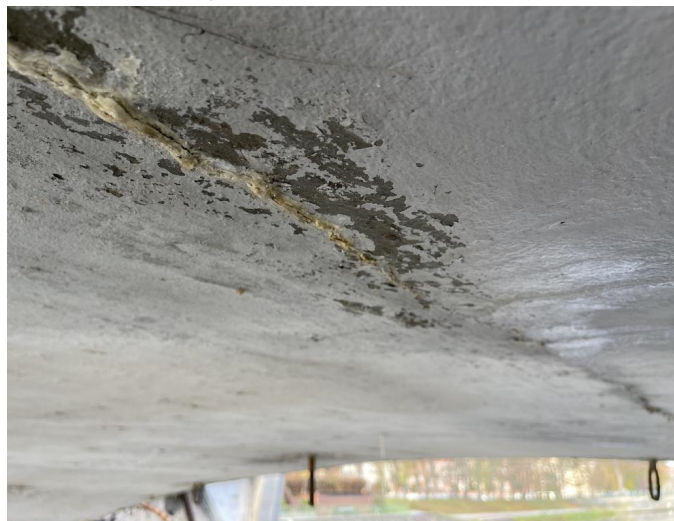
IMG_3909 - pole 2 - obecně se na sanovaném povrchu nosné konstrukce vyskytují množství nepravidelných thlin, četné výluhy, stopy po zatékání, povrchy spíše soudržné (na poklep nejsou duté)
