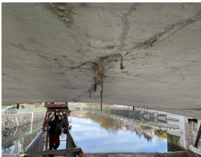
IMG_4064 - pole 3 - obecně se na sanovaném povrchu nosné konstrukce vyskytují množství nepravidelných thlin, četné výluhy, stopy po zatékání, povrchy spíše soudržné (na poklep nejsou duté)
