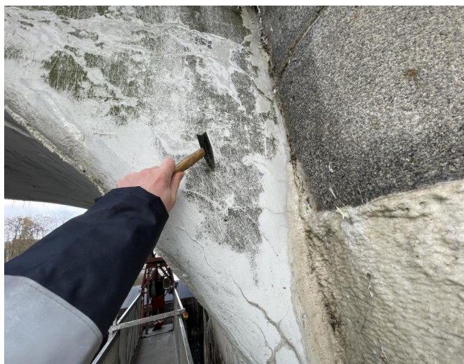
IMG_3880 - pole 2 - obecně se na sanovaném povrchu nosné konstrukce vyskytují množství nepravidelných thlin, četné výluhy, stopy po zatékání, povrchy spíše soudržné (na poklep nejsou duté)
