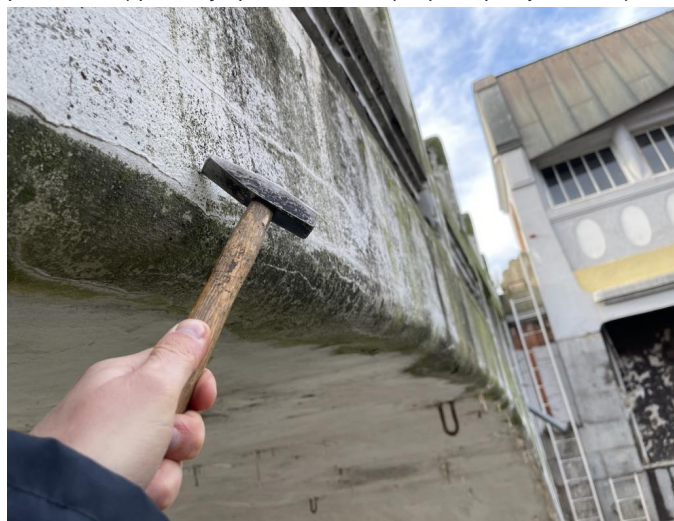
IMG_3916 - pole 2 - obecně se na sanovaném povrchu nosné konstrukce vyskytují množství nepravidelných thlin, četné výluhy, stopy po zatékání, povrchy spíše soudržné (na poklep nejsou duté)
