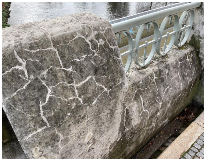
IMG_3971 - obecně se sanovaném povrchu zábradelních zídek vyskytuje množství nepravidelných thlin, četné výluhy, stopy po zatékání, povrchy spíše soudržné (na poklep nejsou duté)
