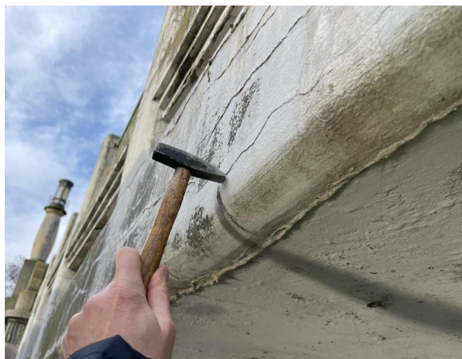
IMG_3918 - pole 2 - obecně se na sanovaném povrchu nosné konstrukce vyskytují množství nepravidelných thlin, četné výluhy, stopy po zatékání, povrchy spíše soudržné (na poklep nejsou duté)
