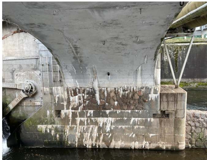
IMG_3926 - píliř P3 - obecně se na spodní stavbě vyskytuje množství nepravidelných thlin, četné výluhy, stopy po zatékání, povrchy spíše soudržné (na poklep nejsou duté)
