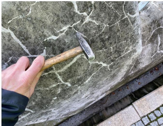
IMG_3972 - obecně se sanovaném povrchu zábradelních zídek vyskytuje množství nepravidelných thlin, četné výluhy, stopy po zatékání, povrchy spíše soudržné (na poklep nejsou duté)
