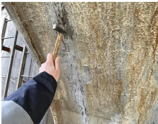
IMG_4022 - pole 3 - obecně se na sanovaném povrchu nosné konstrukce vyskytují množství nepravidelných thlin, četné výluhy, stopy po zatékání, povrchy spíše soudržné (na poklep nejsou duté)
