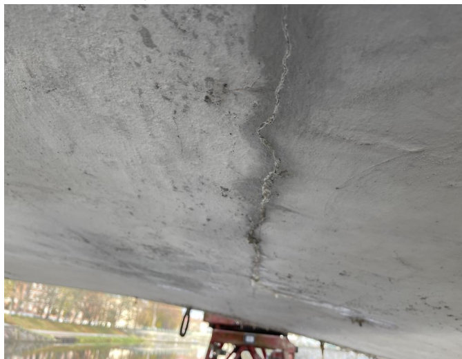
IMG_3910 - pole 2 - obecně se na sanovaném povrchu nosné konstrukce vyskytují množství nepravidelných thlin, četné výluhy, stopy po zatékání, povrchy spíše soudržné (na poklep nejsou duté)
