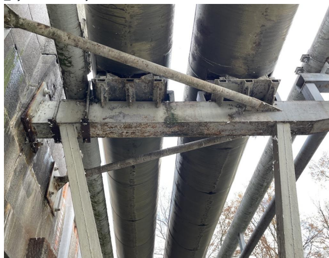
IMG_3876 - zejména na patních deskách konzol pro chráničky inženýrských sítí je dožilá PKO, prozatím spíše povrchová koroze
