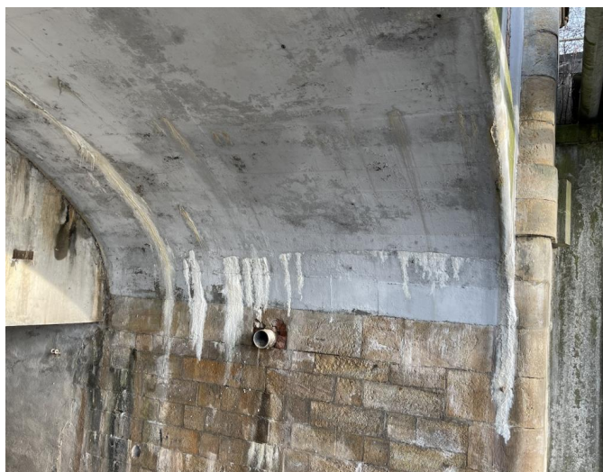
IMG_4082 - pole 1 - obecně se na sanovaném povrchu nosné konstrukce vyskytují množství nepravidelných thlin, četné výluhy, stopy po zatékání, povrchy spíše soudržné (na poklep nejsou duté)
