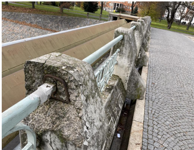
IMG_3987 - hloubková degradace jednoho slopku levého zábradlí nad polem 3, obnažená výztuž, povrchová koroze
