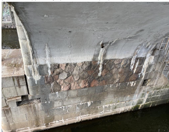
IMG_3925 - pole 2 - obecně se na sanovaném povrchu nosné konstrukce vyskytují množství nepravidelných thlin, četné výluhy, stopy po zatékání, povrchy spíše soudržné (na poklep nejsou duté)
