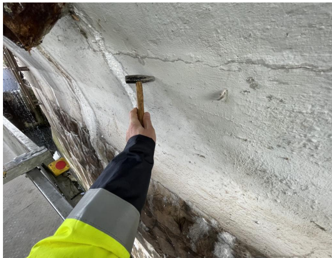
IMG_3887 - pole 2 - obecně se na sanovaném povrchu nosné konstrukce vyskytují množství nepravidelných thlin, četné výluhy, stopy po zatékání, povrchy spíše soudržné (na poklep nejsou duté)
