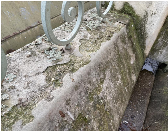
IMG_3973 - obecně se sanovaném povrchu zábradelních zídek vyskytuje množství nepravidelných thlin, četné výluhy, stopy po zatékání, povrchy spíše soudržné (na poklep nejsou duté)
