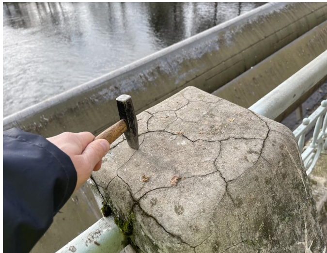
IMG_3979 - obecně se sanovaném povrchu zábradelních sloupků vyskytuje množství nepravidelných thlin, četné výluhy, stopy po zatékání, povrchy spíše soudržné (na poklep nejsou duté)
