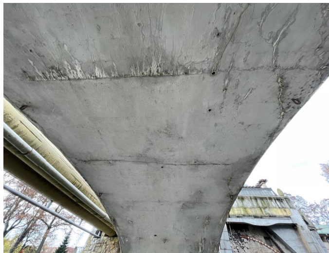
IMG_4037 - pole 3 - obecně se na sanovaném povrchu nosné konstrukce vyskytují množství nepravidelných thlin, četné výluhy, stopy po zatékání, povrchy spíše soudržné (na poklep nejsou duté)
