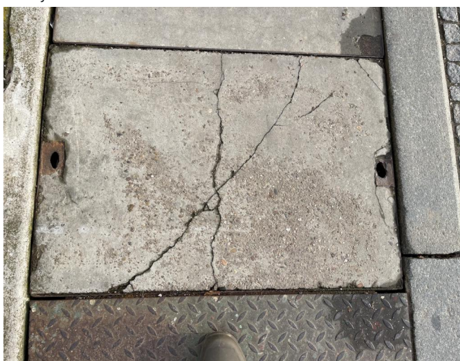
IMG_4007 - některé krycí desky kabelového kanálku vpravo degradují, trhliny
