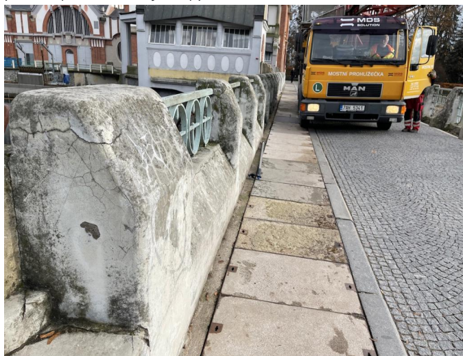
IMG_3993 - obecně se sanovaném povrchu zábradelních sloupků vyskytuje množství nepravidelných thlin, četné výluhy, stopy po zatékání, povrchy spíše soudržné (na poklep nejsou duté)
