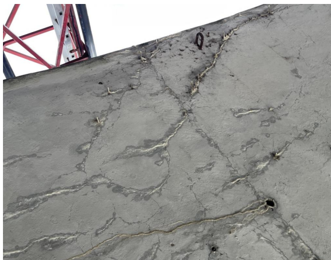
IMG_4036 - pole 3 - obecně se na sanovaném povrchu nosné konstrukce vyskytují množství nepravidelných thlin, četné výluhy, stopy po zatékání, povrchy spíše soudržné (na poklep nejsou duté)
