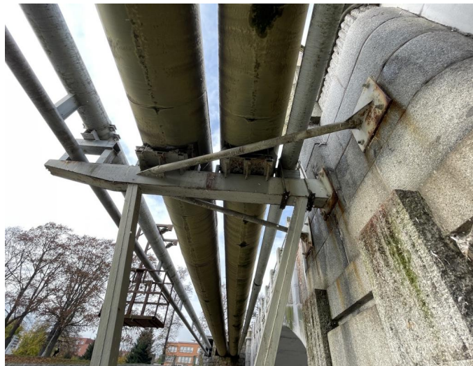
IMG_3936 - zejména na patních deskách konzol pro chráničky inženýrských sítí je dožilaá PKO, prozatím spíše povrchová koruze
