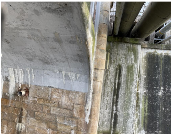
IMG_4076 - pole 1 - obecně se na sanovaném povrchu nosné konstrukce vyskytují množství nepravidelných thlin, četné výluhy, stopy po zatékání, povrchy spíše soudržné (na poklep nejsou duté)
