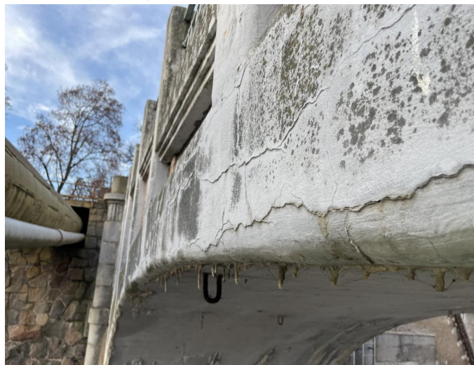
IMG_4065 - pole 3 - obecně se na sanovaném povrchu nosné konstrukce vyskytují množství nepravidelných thlin, četné výluhy, stopy po zatékání, povrchy spíše soudržné (na poklep nejsou duté)
