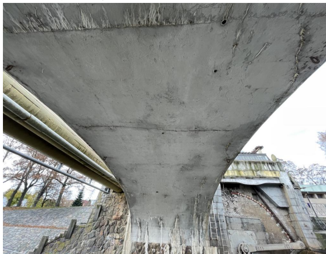
IMG_4038 - pole 3 - obecně se na sanovaném povrchu nosné konstrukce vyskytují množství nepravidelných thlin, četné výluhy, stopy po zatékání, povrchy spíše soudržné (na poklep nejsou duté)
