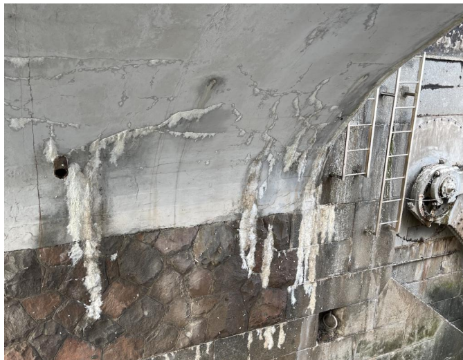
IMG_3927 - pole 2 - obecně se na sanovaném povrchu nosné konstrukce vyskytují množství nepravidelných thlin, četné výluhy, stopy po zatékání, povrchy spíše soudržné (na poklep nejsou duté)
