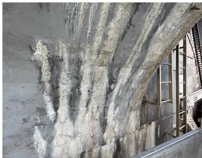
IMG_4052 - pole 3 - obecně se na sanovaném povrchu nosné konstrukce vyskytují množství nepravidelných thlin, četné výluhy, stopy po zatékání, povrchy spíše soudržné (na poklep nejsou duté)
