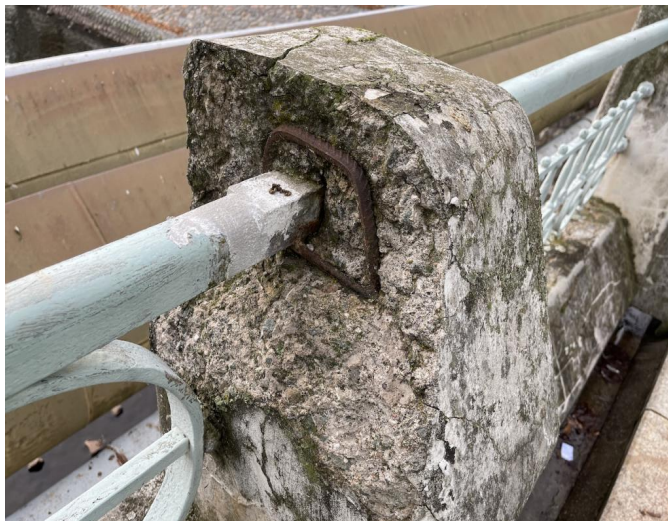
IMG_3988 - hloubková degradace jednoho slopku levého zábradlí nad polem 3, obnažená výztuž, povrchová koroze
