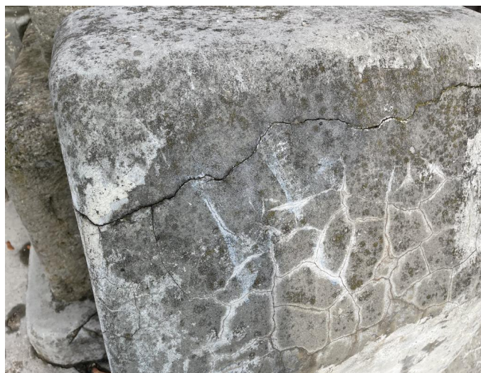
IMG_3995 - obecně se sanovaném povrchu zábradelních sloupků vyskytuje množství nepravidelných thlin, četné výluhy, stopy po zatékání, povrchy spíše soudržné (na poklep nejsou duté)
