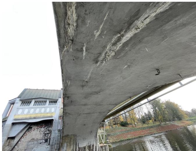
IMG_4054 - pole 3 - obecně se na sanovaném povrchu nosné konstrukce vyskytují množství nepravidelných thlin, četné výluhy, stopy po zatékání, povrchy spíše soudržné (na poklep nejsou duté)
