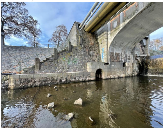
_ Levé křídlo na konci mostu (K3)
