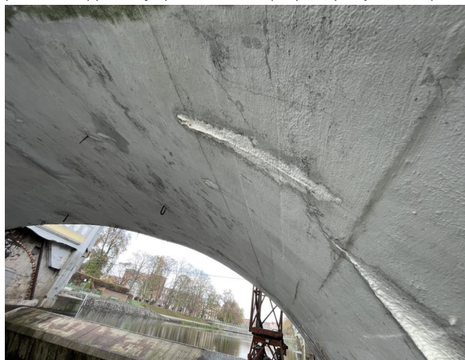
IMG_3883 - pole 2 - obecně se na sanovaném povrchu nosné konstrukce vyskytují množství nepravidelných thlin, četné výluhy, stopy po zatékání, povrchy spíše soudržné (na poklep nejsou duté)
