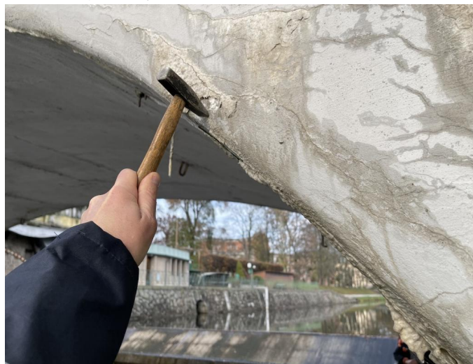
IMG_4026 - pole 3 - obecně se na sanovaném povrchu nosné konstrukce vyskytují množství nepravidelných thlin, četné výluhy, stopy po zatékání, povrchy spíše soudržné (na poklep nejsou duté)
