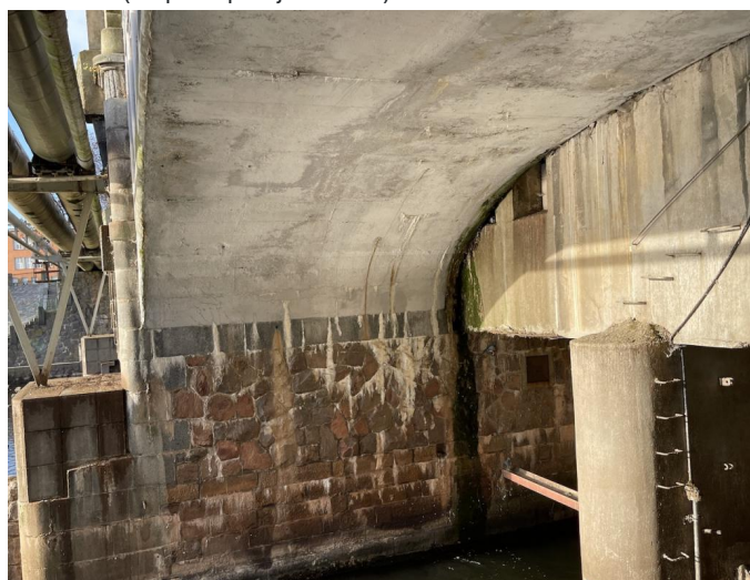
IMG_4089 - pilíř P2 - obecně se na spodní stavbě vyskytuje množství nepravidelných thlin, četné výluhy, stopy po zatékání, povrchy spíše soudržné (na poklep nejsou duté)
