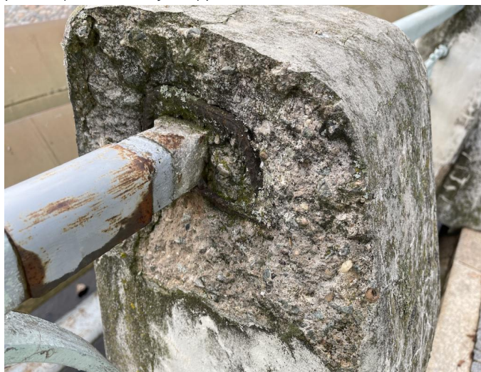
IMG_3989 - hloubková degradace jednoho slopku levého zábradlí nad polem 3, obnažená výztuž, povrchová koroze
