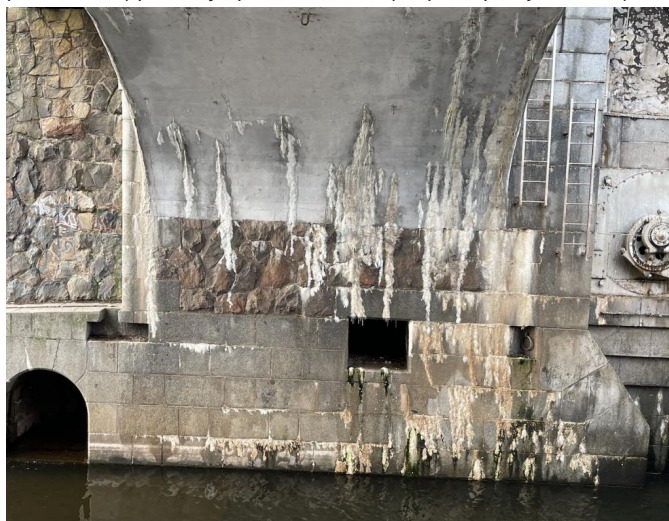
IMG_4034 - pole 3 - obecně se na sanovaném povrchu nosné konstrukce vyskytují množství nepravidelných thlin, četné výluhy, stopy po zatékání, povrchy spíše soudržné (na poklep nejsou duté)
