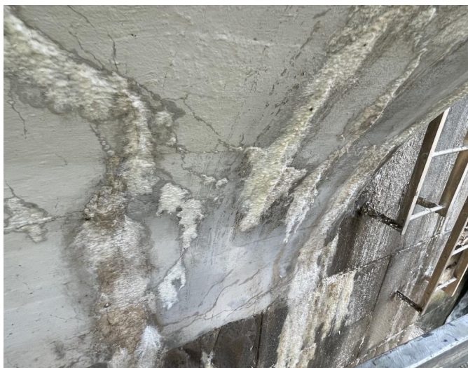
IMG_3943 - pole 2 - obecně se na sanovaném povrchu nosné konstrukce vyskytují množství nepravidelných thlin, četné výluhy, stopy po zatékání, povrchy spíše soudržné (na poklep nejsou duté)
