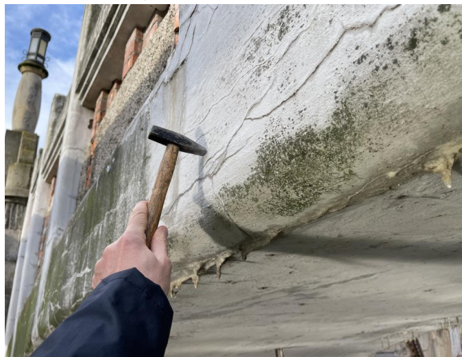
IMG_3922 - pole 2 - obecně se na sanovaném povrchu nosné konstrukce vyskytují množství nepravidelných thlin, četné výluhy, stopy po zatékání, povrchy spíše soudržné (na poklep nejsou duté)
