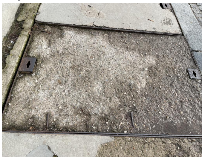
IMG_4004 - některé krycí desky kabelového kanálku vpravo degradují, trhliny
