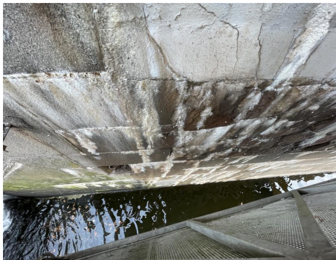
IMG_3898 - pilíř P2 - obecně se na spodní stavbě vyskytuje množství nepravidelných thlin, četné výluhy, stopy po zatékání, povrchy spíše soudržné (na poklep nejsou duté)
