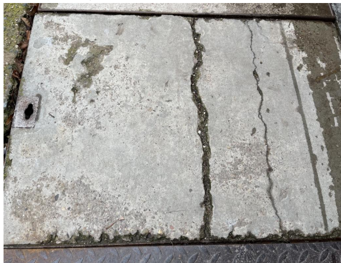
IMG_3999 - některé krycí desky kabelového kanálku vpravo degradují, trhliny
