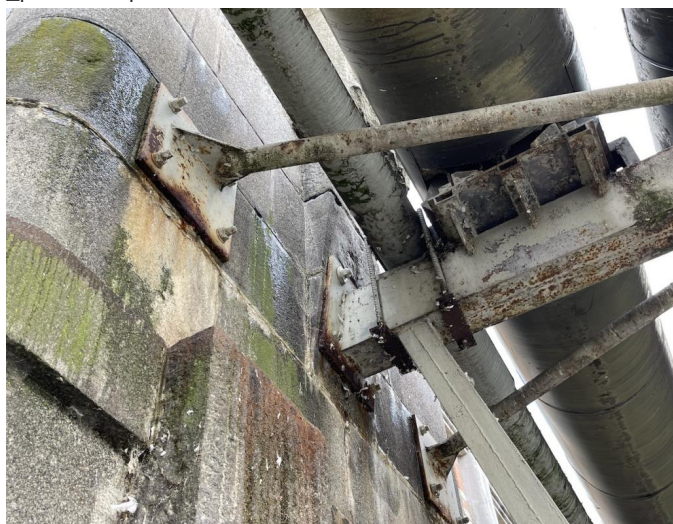
IMG_3875 - zejména na patních deskách konzol pro chráničky inženýrských sítí je dožilá PKO, prozatím spíše povrchová koroze
