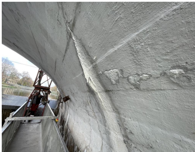
IMG_3882 - pole 2 - obecně se na sanovaném povrchu nosné konstrukce vyskytují množství nepravidelných thlin, četné výluhy, stopy po zatékání, povrchy spíše soudržné (na poklep nejsou duté)
