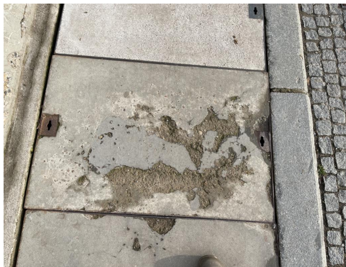
IMG_4008 - některé krycí desky kabelového kanálu vpravo degradují, trhliny
