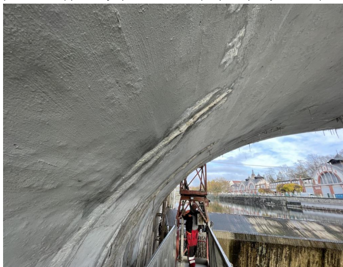
IMG_4048 - pole 3 - obecně se na sanovaném povrchu nosné konstrukce vyskytují množství nepravidelných thlin, četné výluhy, stopy po zatékání, povrchy spíše soudržné (na poklep nejsou duté)
