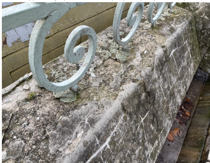
IMG_3982 - místy je sanovaný povrch zábradlí zcela odpadlý, otevřená struktura betonu
