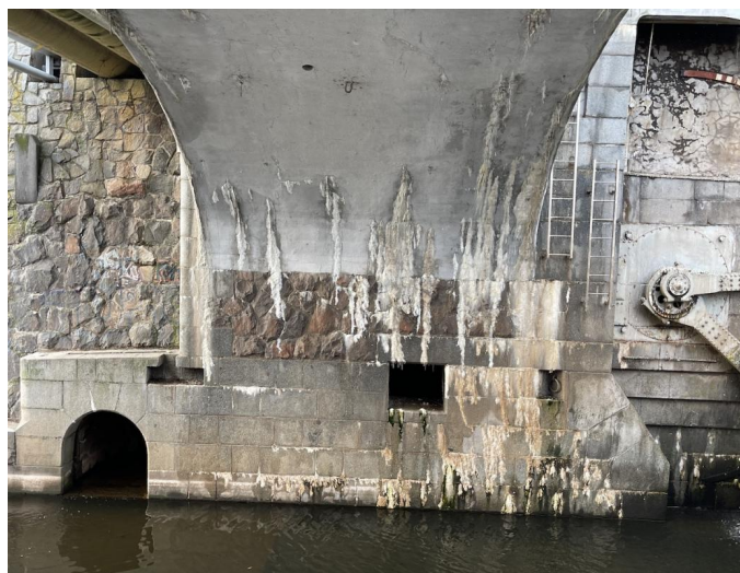
IMG_4035 - opěra O4 - obecně se na spodní stavbě vyskytuje množství nepravidelných thlin, četné výluhy, stopy po zatékání, povrchy spíše soudržné (na poklep nejsou duté)
