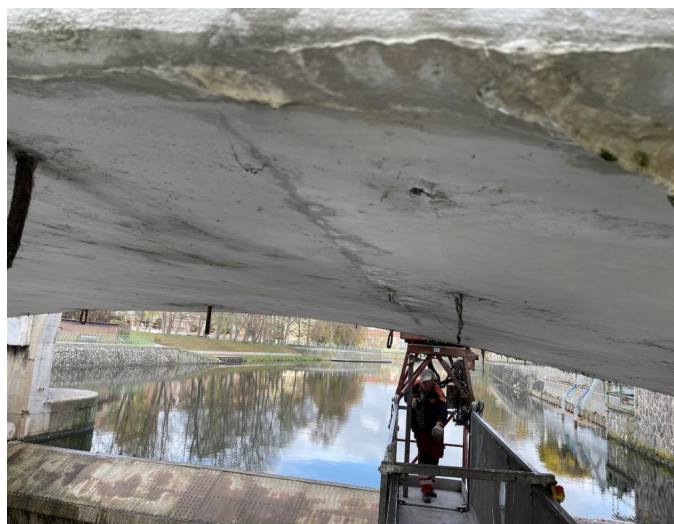
IMG_3907 - pole 2 - obecně se na sanovaném povrchu nosné konstrukce vyskytují množství nepravidelných thlin, četné výluhy, stopy po zatékání, povrchy spíše soudržné (na poklep nejsou duté)
