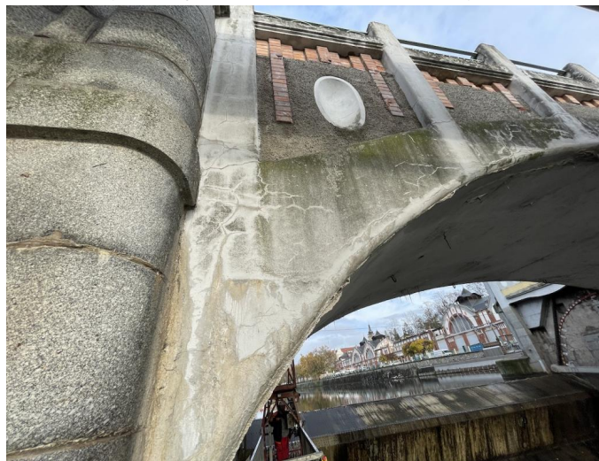
IMG_4044 - pole 3 - obecně se na sanovaném povrchu nosné konstrukce vyskytují množství nepravidelných thlin, četné výluhy, stopy po zatékání, povrchy spíše soudržné (na poklep nejsou duté)
