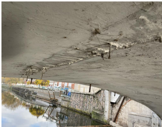
IMG_3923 - pole 2 - obecně se na sanovaném povrchu nosné konstrukce vyskytují množství nepravidelných thlin, četné výluhy, stopy po zatékání, povrchy spíše soudržné (na poklep nejsou duté)
