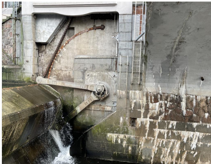
IMG_3953 - pilíř P2 - obecně se na spodní stavbě vyskytuje množství nepravidelných thlin, četné výluhy, stopy po zatékání, povrchy spíše soudržné (na poklep nejsou duté)
