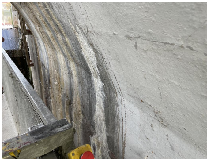
IMG_4030 - pole 3 - obecně se na sanovaném povrchu nosné konstrukce vyskytují množství nepravidelných thlin, četné výluhy, stopy po zatékání, povrchy spíše soudržné (na poklep nejsou duté)
