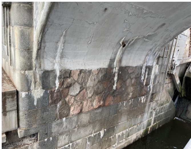
IMG_3931 - píliř P3 - obecně se na spodní stavbě vyskytuje množství nepravidelných thlin, četné výluhy, stopy po zatékání, povrchy spíše soudržné (na poklep nejsou duté)
