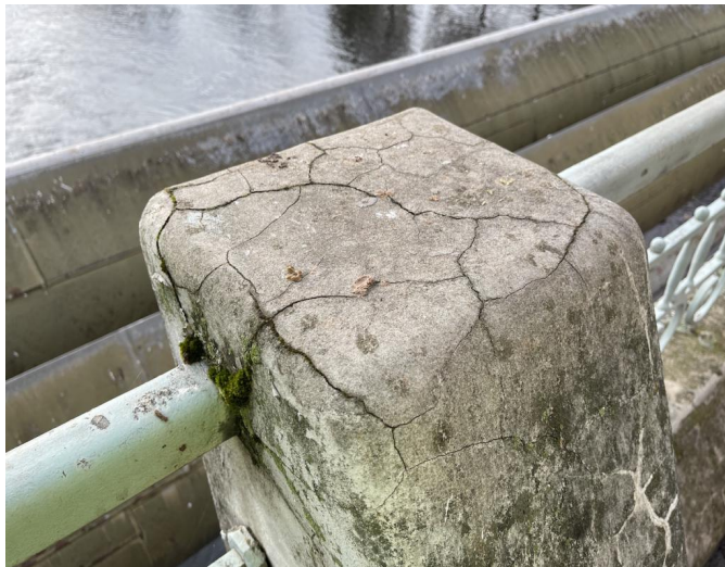
IMG_3980 - obecně se sanovaném povrchu zábradelních sloupků vyskytuje množství nepravidelných thlin, četné výluhy, stopy po zatékání, povrchy spíše soudržné (na poklep nejsou duté)
