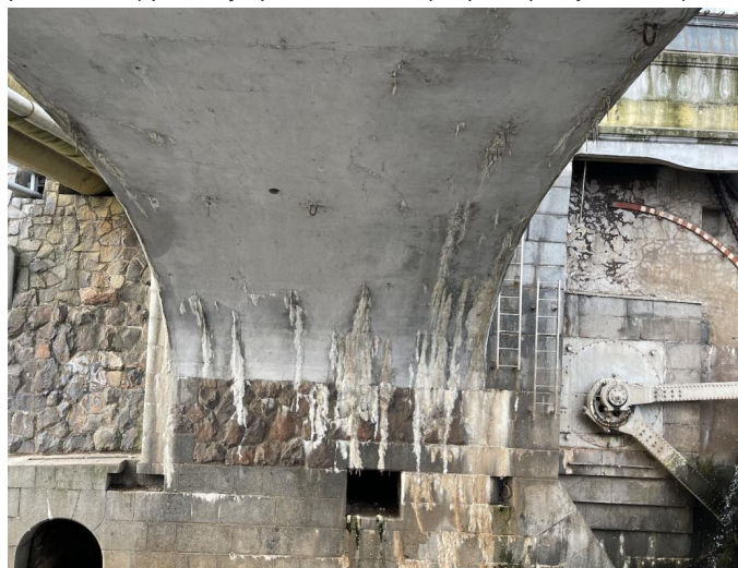
IMG_4039 - pole 3 - obecně se na sanovaném povrchu nosné konstrukce vyskytují množství nepravidelných thlin, četné výluhy, stopy po zatékání, povrchy spíše soudržné (na poklep nejsou duté)
