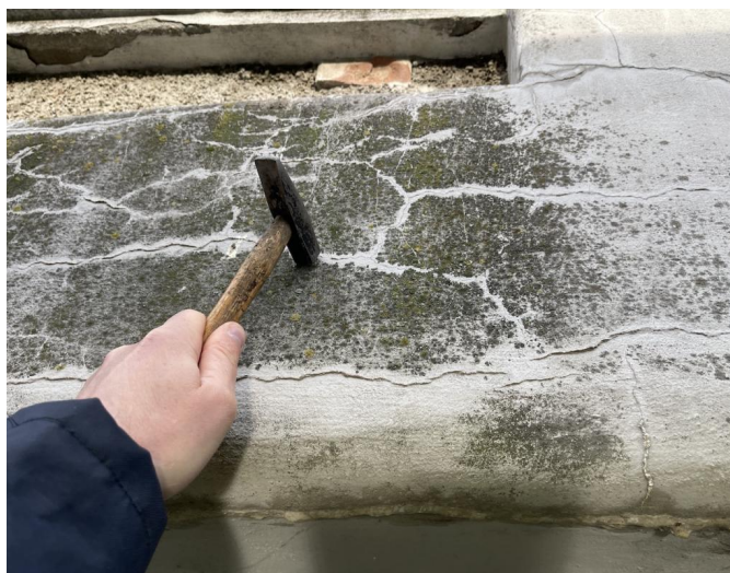
IMG_3920 - pole 2 - obecně se na sanovaném povrchu nosné konstrukce vyskytují množství nepravidelných thlin, četné výluhy, stopy po zatékání, povrchy spíše soudržné (na poklep nejsou duté)
