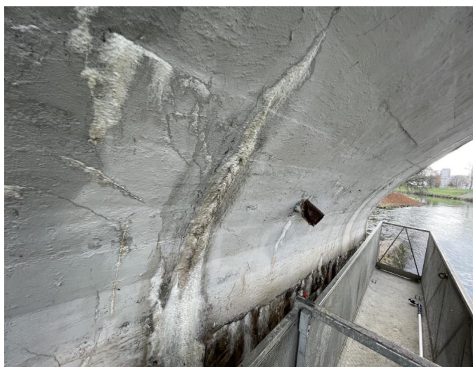
IMG_3892 - pole 2 - obecně se na sanovaném povrchu nosné konstrukce vyskytují množství nepravidelných thlin, četné výluhy, stopy po zatékání, povrchy spíše soudržné (na poklep nejsou duté)
