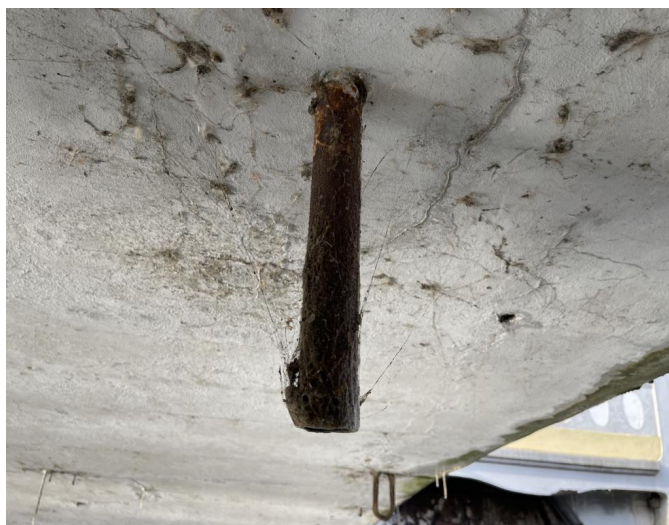
IMG_3917 - silná koroze svodů i vyústění odvodňovačů
