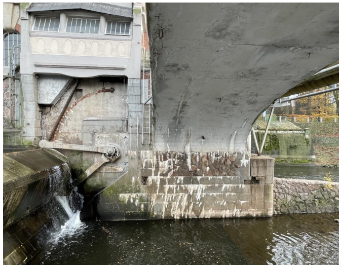
IMG_3954 - pilíř P2 - obecně se na spodní stavbě vyskytuje množství nepravidelných thlin, četné výluhy, stopy po zatékání, povrchy spíše soudržné (na poklep nejsou duté)
