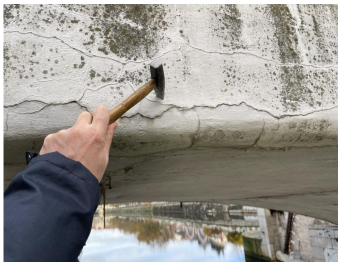
IMG_4063 - pole 3 - obecně se na sanovaném povrchu nosné konstrukce vyskytují množství nepravidelných thlin, četné výluhy, stopy po zatékání, povrchy spíše soudržné (na poklep nejsou duté)
