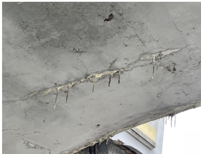
IMG_3928 - pole 2 - obecně se na sanovaném povrchu nosné konstrukce vyskytují množství nepravidelných thlin, četné výluhy, stopy po zatékání, povrchy spíše soudržné (na poklep nejsou duté)
