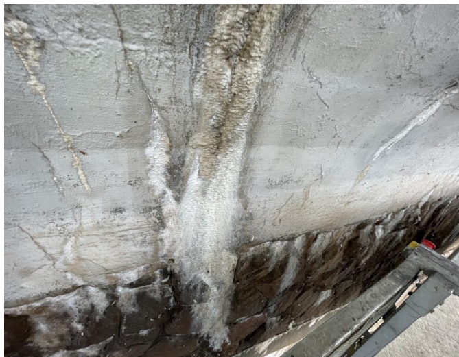
IMG_3891 - pole 2 - obecně se na sanovaném povrchu nosné konstrukce vyskytují množství nepravidelných thlin, četné výluhy, stopy po zatékání, povrchy spíše soudržné (na poklep nejsou duté)
