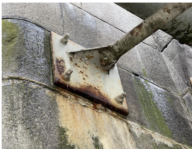
IMG_3877 - zejména na patních deskách konzol pro chráničky inženýrských sítí je dožilá PKO, prozatím spíše povrchová koroze
