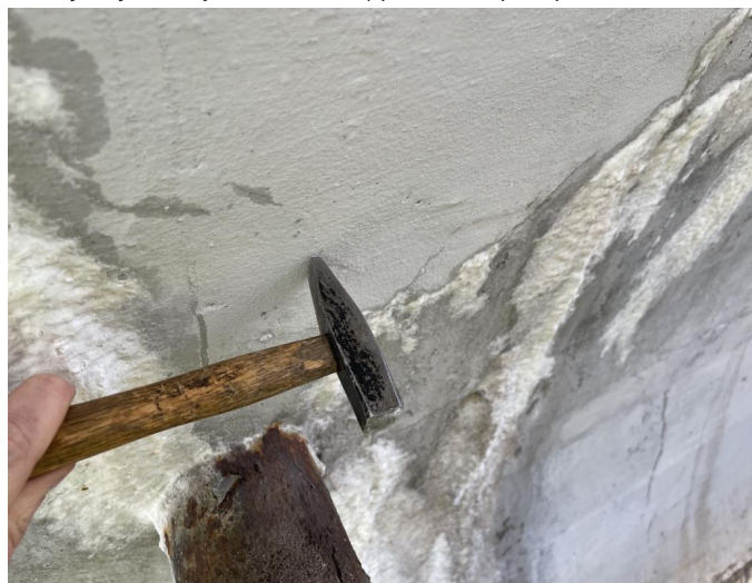
IMG_3940 - pole 2 - obecně se na sanovaném povrchu nosné konstrukce vyskytují množství nepravidelných thlin, četné výluhy, stopy po zatékání, povrchy spíše soudržné (na poklep nejsou duté)
