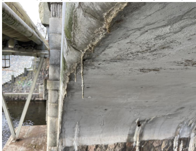
IMG_3924 - pole 2 - obecně se na sanovaném povrchu nosné konstrukce vyskytují množství nepravidelných thlin, četné výluhy, stopy po zatékání, povrchy spíše soudržné (na poklep nejsou duté)
