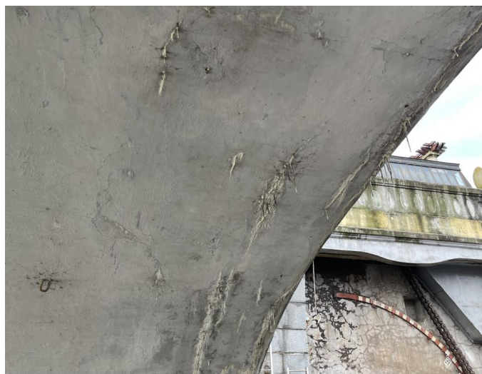
IMG_4041 - pole 3 - obecně se na sanovaném povrchu nosné konstrukce vyskytují množství nepravidelných thlin, četné výluhy, stopy po zatékání, povrchy spíše soudržné (na poklep nejsou duté)
