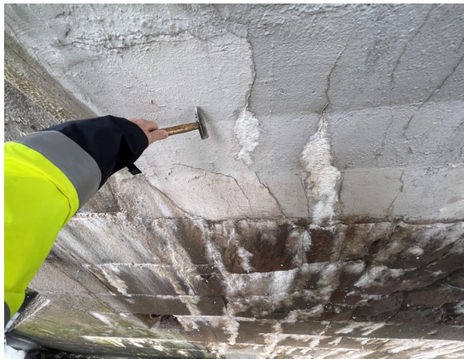
IMG_3895 - pole 2 - obecně se na sanovaném povrchu nosné konstrukce vyskytují množství nepravidelných thlin, četné výluhy, stopy po zatékání, povrchy spíše soudržné (na poklep nejsou duté)
