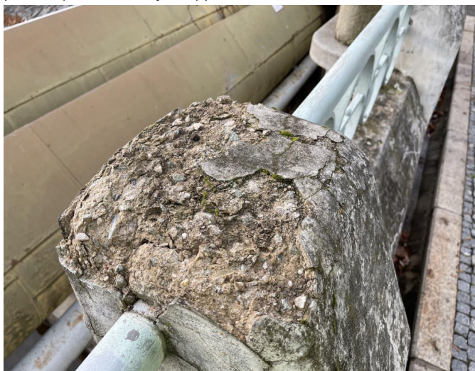
IMG_3990 - hloubková degradace jednoho slopku levého zábradlí nad polem 3, obnažená výztuž, povrchová koroze
