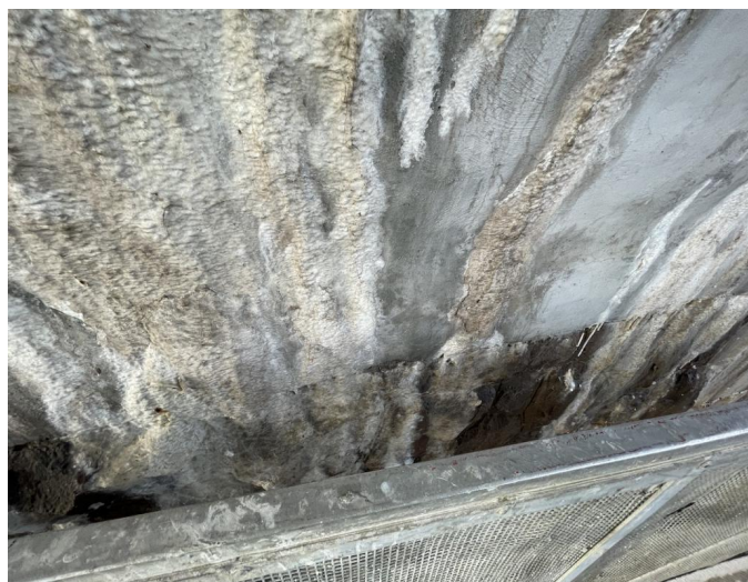
IMG_4051 - pole 3 - obecně se na sanovaném povrchu nosné konstrukce vyskytují množství nepravidelných thlin, četné výluhy, stopy po zatékání, povrchy spíše soudržné (na poklep nejsou duté)
