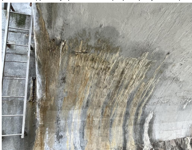
IMG_4020 - pole 3 - obecně se na sanovaném povrchu nosné konstrukce vyskytují množství nepravidelných thlin, četné výluhy, stopy po zatékání, povrchy spíše soudržné (na poklep nejsou duté)
