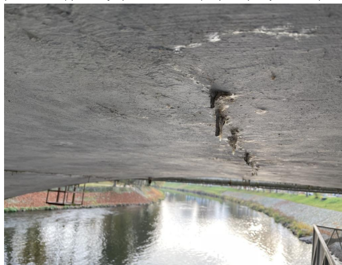
IMG_4062 - pole 3 - obecně se na sanovaném povrchu nosné konstrukce vyskytují množství nepravidelných thlin, četné výluhy, stopy po zatékání, povrchy spíše soudržné (na poklep nejsou duté)
