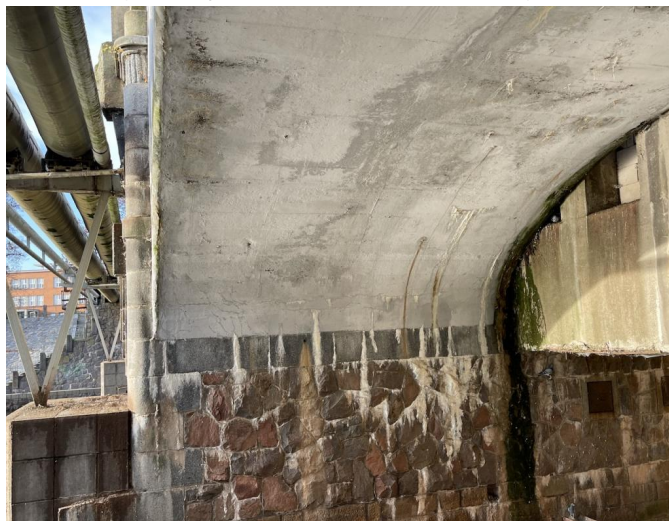
IMG_4087 - pilíř P2 - obecně se na spodní stavbě vyskytuje množství nepravidelných thlin, četné výluhy, stopy po zatékání, povrchy spíše soudržné (na poklep nejsou duté)
