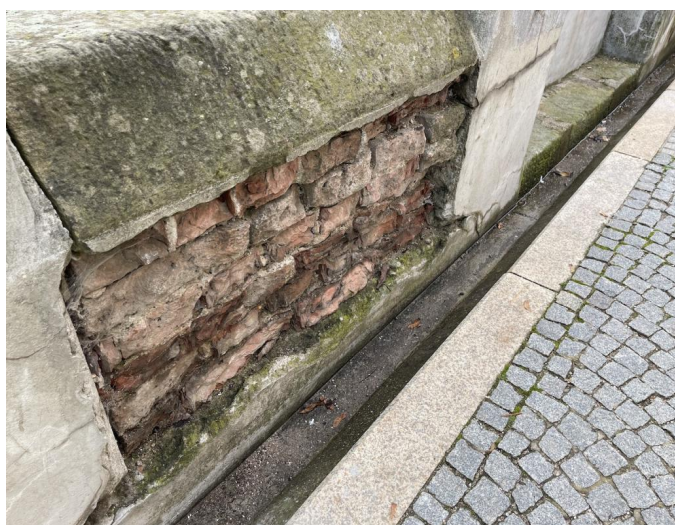
IMG_3970 - degradující zdivo tvořící dozdivky polí zábradlí
