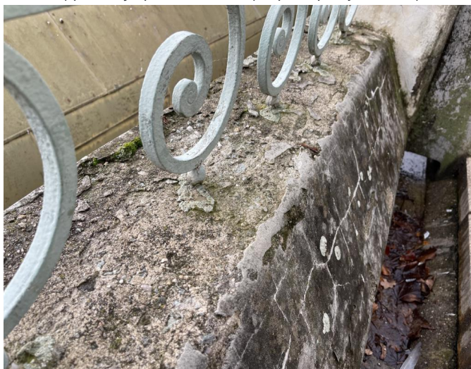
IMG_3985 - místy je sanovaný povrch zábradlí zcela odpadlý, otevřená struktura betonu
