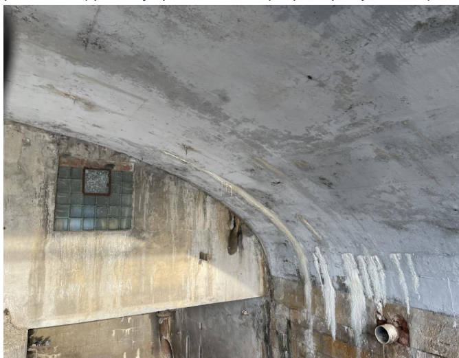
IMG_4078 - pole 1 - obecně se na sanovaném povrchu nosné konstrukce vyskytují množství nepravidelných thlin, četné výluhy, stopy po zatékání, povrchy spíše soudržné (na poklep nejsou duté)
