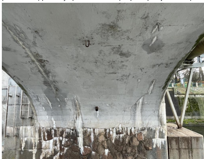
IMG_3904 - pole 2 - obecně se na sanovaném povrchu nosné konstrukce vyskytují množství nepravidelných thlin, četné výluhy, stopy po zatékání, povrchy spíše soudržné (na poklep nejsou duté)
