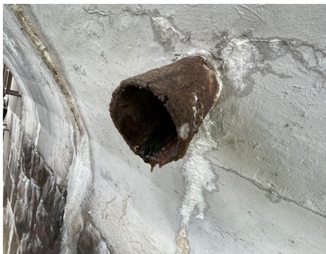
IMG_3890 - silná koroze svodů i vyústění odvodňovačů
