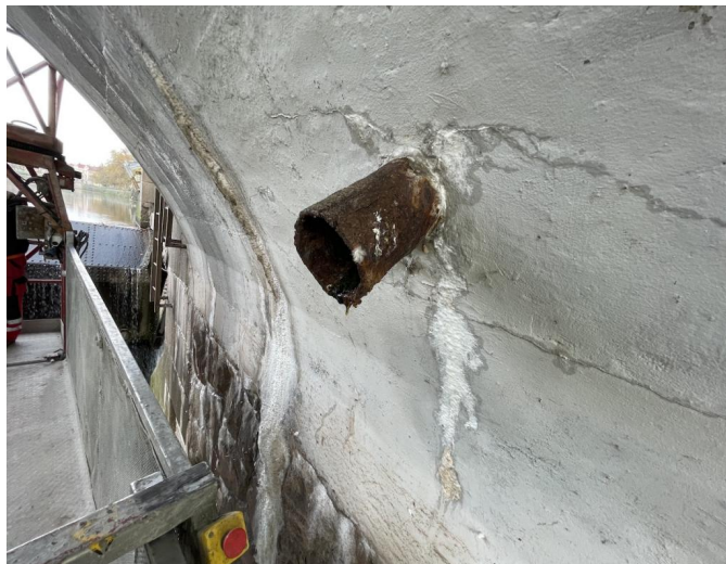
IMG_3889 - silná koroze svodů i vyústění odvodňovačů
