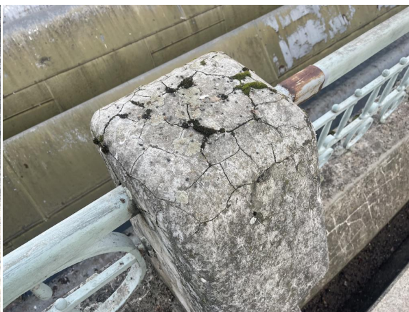
_stav levého záchytného systému v roce 2024,,
