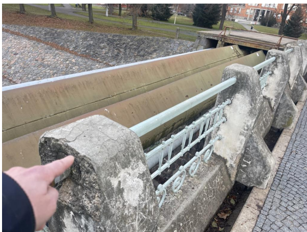
_stav levého záchytného systému v roce 2024
