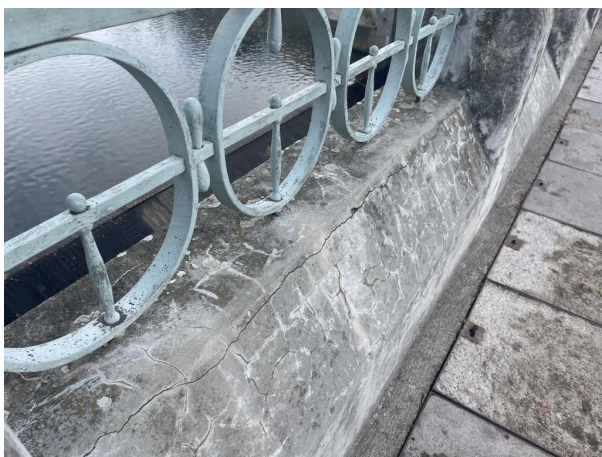
_stav pravého záchytného systému v roce 2024.
