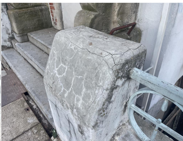
_stav pravého záchytného systému v roce 2024..
