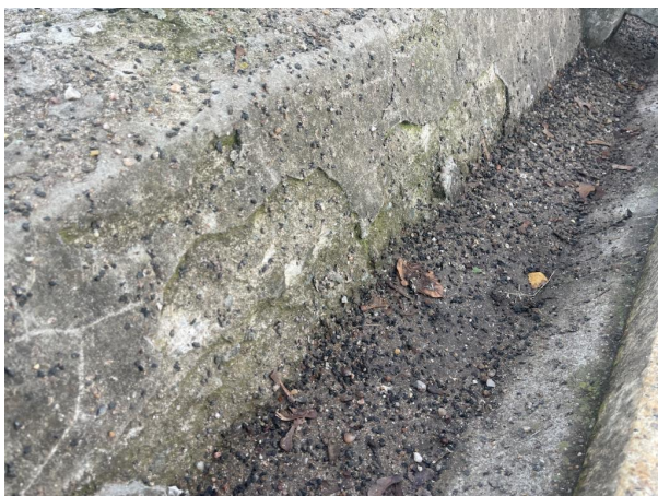
_stav levého záchytného systému v roce 2024,,
