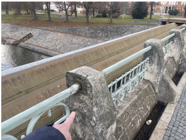
_stav levého záchytného systému v roce 2024..
