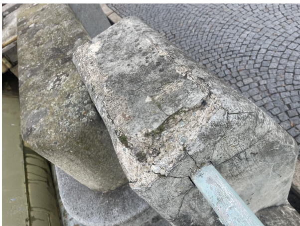
_stav levého záchytného systému v roce 2024
