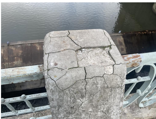
_stav pravého záchytného systému v roce 2024,
