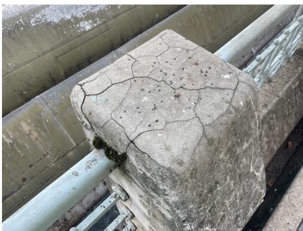
_stav levého záchytného systému v roce 2024..
