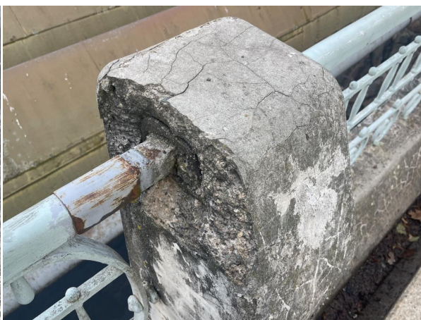
_stav levého záchytného systému v roce 2024.
