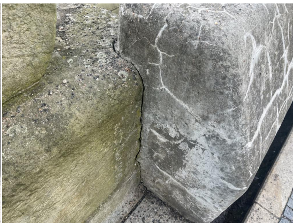
_stav levého záchytného systému v roce 2024,
