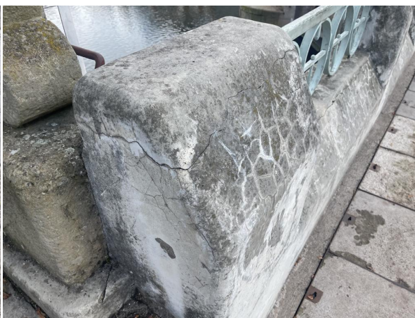
_stav pravého záchytného systému v roce 2024
