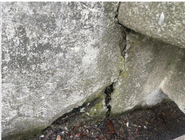
_stav levého záchytného systému v roce 2024.
