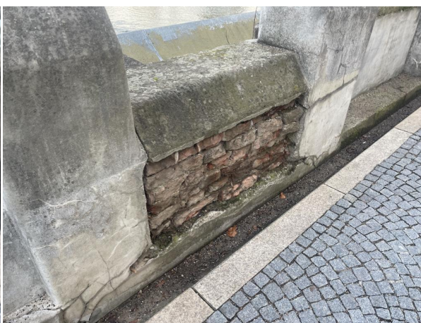
_stav levého záchytného systému v roce 2024
