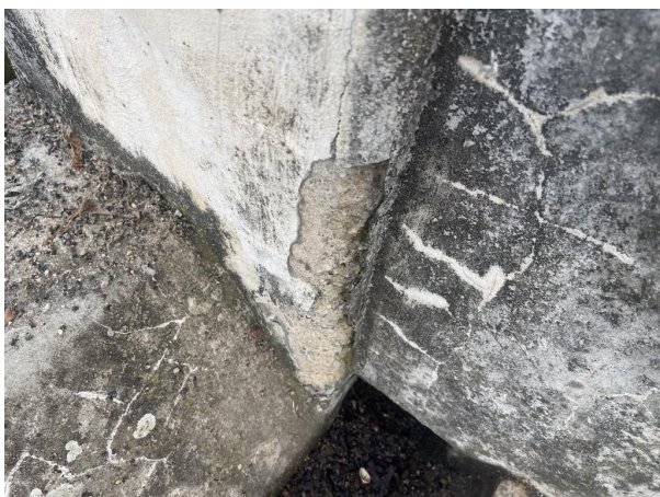
_stav levého záchytného systému v roce 2024..
