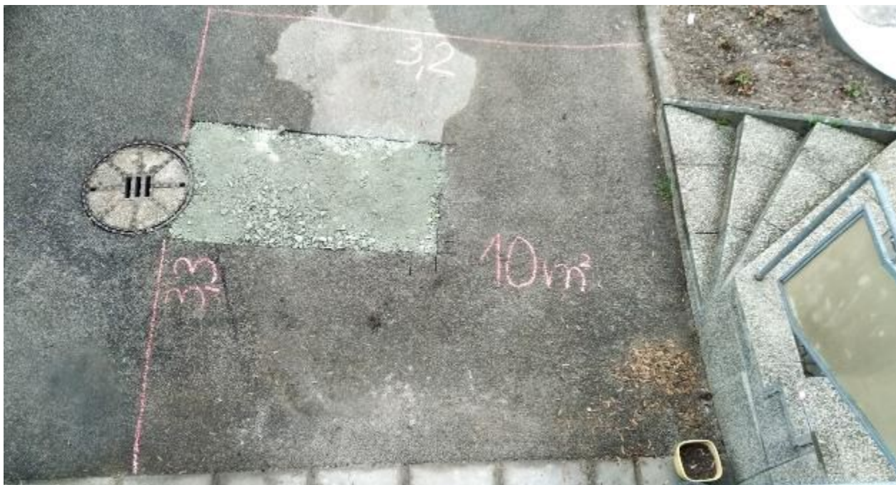
S03 – Oprava propadlé plochy (před provozním objektem)
