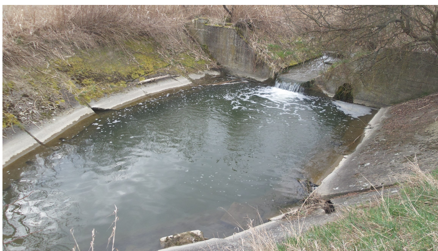
Foto č.18 – Pohled proti vodě na vývar a přepadový práh stupně v km 10,065 (porušené betonové opevnění vývaru a naplavené bet. desky)
