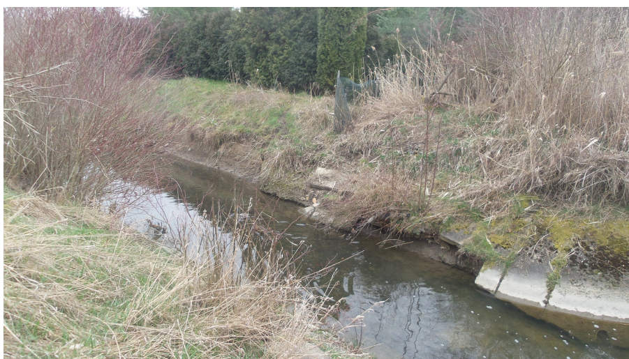
Foto č.17 – Detailní pohled po vodě na vzniklou nátrž (podemletý pravý břeh v konci zaplaceného pozemku – živý plot z thůjí) pod zajišťovacím betonovým prahem stupně v km 10,055
