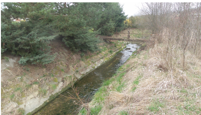
Foto č.12 – Pohled proti vodě na koryto pod lávkou v km 9,921 (lokálně rozpadlé bet. desky, naplaveniny v korytě)
