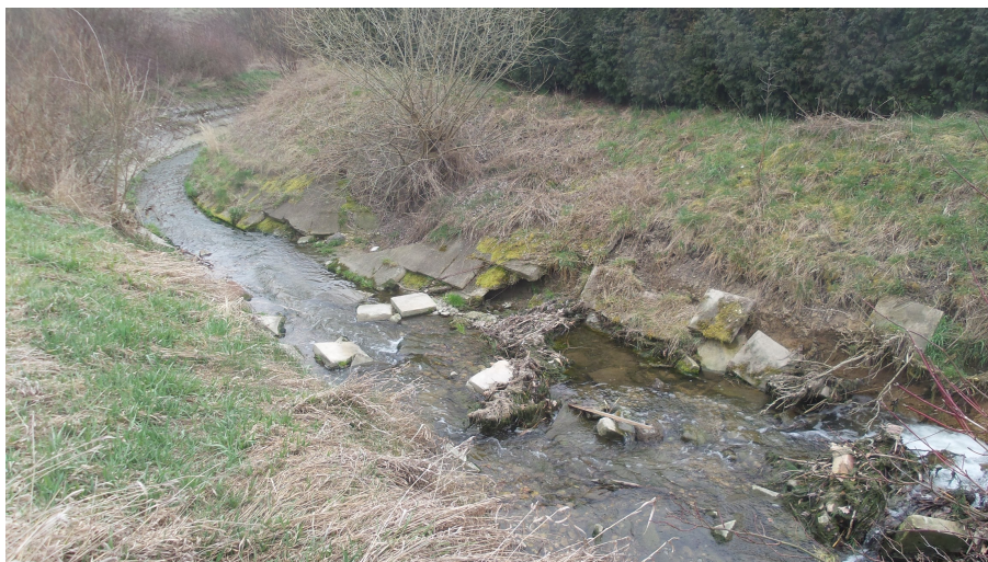
Foto č.16 – Pohled po vodě na pokračující destrukci koryta nad pravostranným obloukem koryta od km 1,020 až k vývaru výše ležícího stupně
