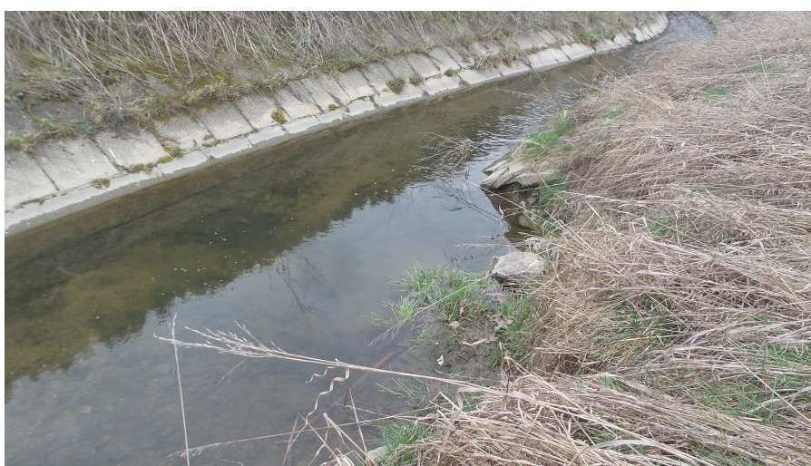
Foto č.15 – Detailní pohled na nátrž levého břehu v km 9,980-10,000
