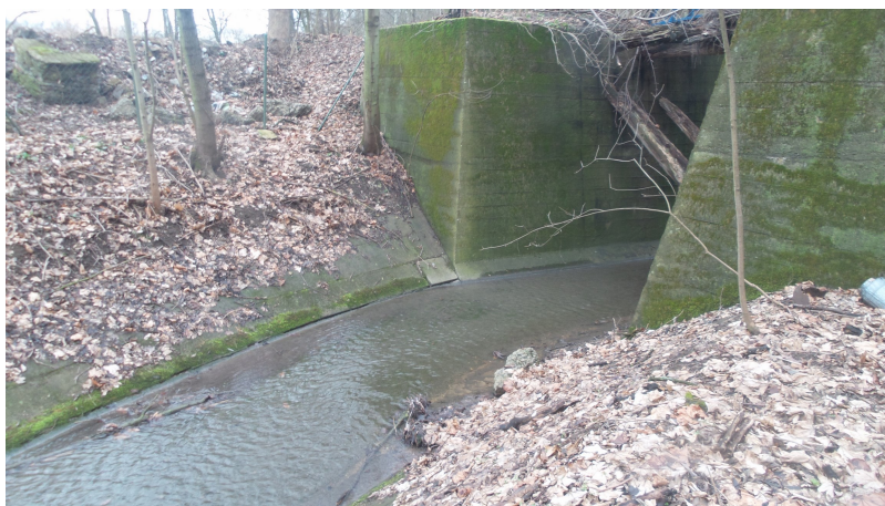
Foto č.1 – Pohled na začátek opravovaného úseku nad vtokem do cestního mostku v km 9,276
