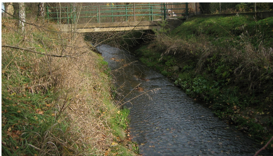
Foto č.47- Pohled po vodě na km 12,262-12,300 nad cestním mostkem (částečně porušené betonové opevnění svahů i dna, pomístně nátrže)
