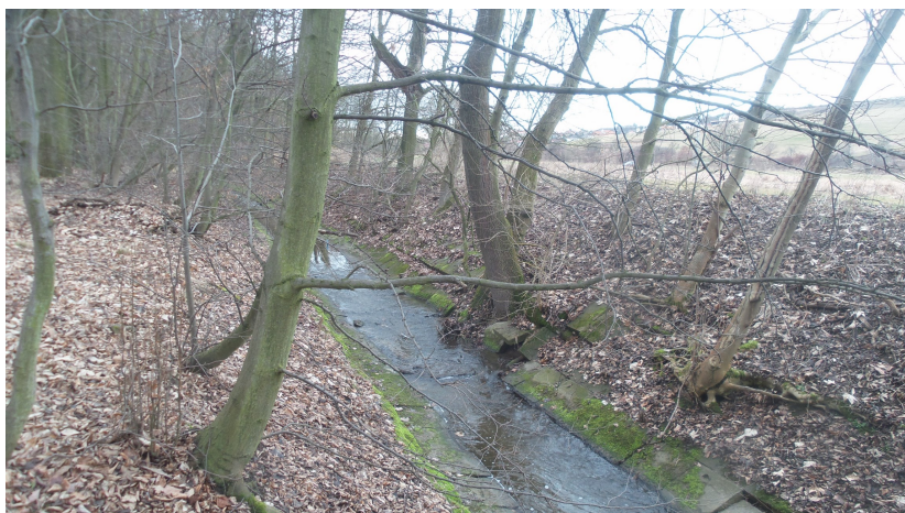
Foto č.4 – Pohled proti vodě na náletový porost v průtočném profilu Únětického potoka, jehož kořeny přispívají k rozpadání bet. opevnění a vzniku nátrží v tělese hráze Tuchoměřického poldru (km 9,400-9,500)
