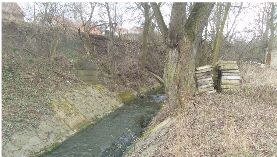
Foto č.28 – Pohled proti vodě na konec opraveného úseku v km 11,685 (k.ú. Kněžívka), při levém břehu narovnané vyplavené betonové desky z horního úseku (vlevo v pozadí bet. šachta v konci úpravy a napouštěcí objekt Mlýnského náhonu)
