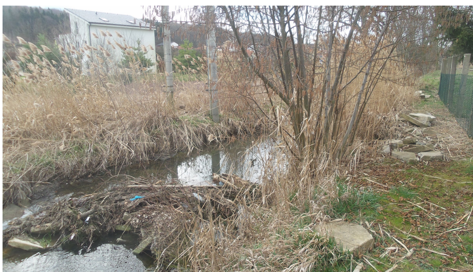
Foto č.21 – Pohled proti vodě na konec nátrže v km 10,180 před koncem levostranného oplocení.
