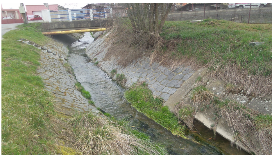
Foto č.27 – Detailní pohled proti vodě na porušené bet. opevnění v návaznosti na opravený úsek realizovaný v roce 2008 (km 10,578-11,685) – zde končí navržená oprava v k.ú.Tuchoměřice
