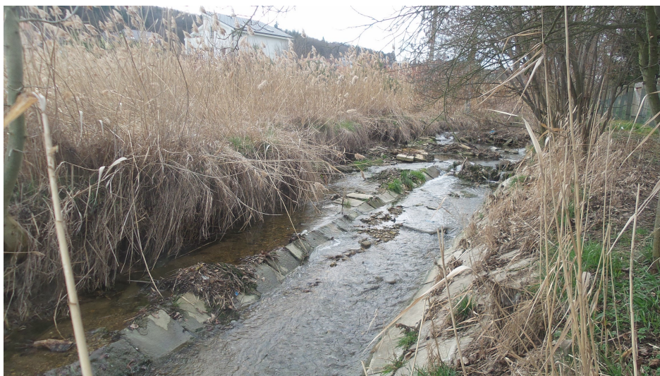
Foto č.19 – Pohled proti vodě na úsek nad stupněm v km 10,100-10,180, kde došlo k úplné destrukci koryta.
