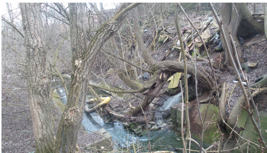
Foto č.33 – Pohled po vodě z výtokové části cestního mostku v km 11,727 na devastující koryto, do kterého zasahuje pravobřežní divoká skládka s komunálním odpadem i popadanými stromy
