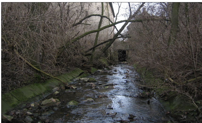
Foto č.41 – Pohled po vodě na úsek Únětického potoka v km 11,984-12,020 (rozpadlé opevnění, naplaveniny, nálet a popadané stromy v korytě toku) – zahlužený úsek koryta
