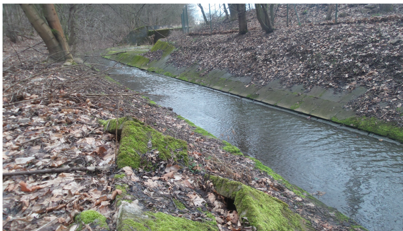
Foto č.2 - Pohled proti vodě na rozpadlé opevnění a vyplavené betonové desky v úseku km 9,276-9,300 pod funkčním objektem Tuchoměřického poldru
