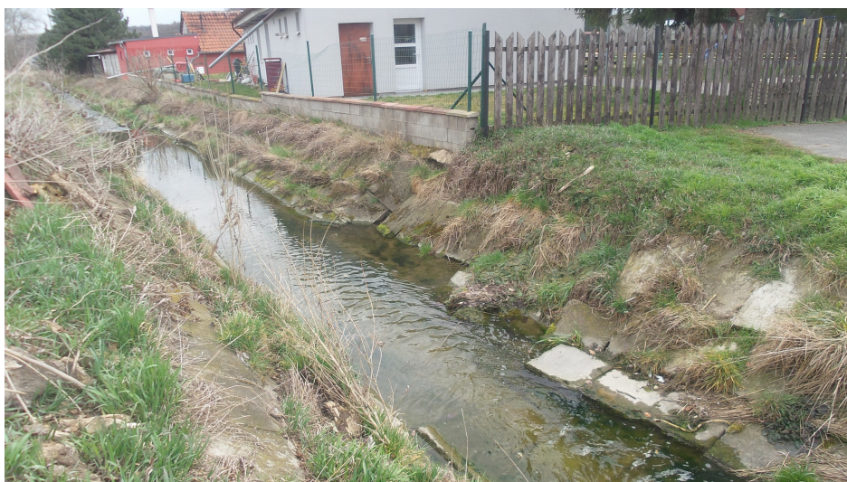
Foto č.26 – Detailní pohled po vodě na pravostrannou nátrž v km 10,450 u konci zaplaceného areálu fotbalového hřiště v Tuchoměřicích
