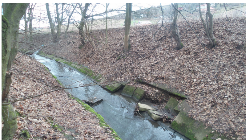
Foto č.3 – Pohled proti vodě charakteristický úsek podél boční hráze Tuchoměřického poldru (v popředí rozpadlé betonové opevnění levého břehu, v pozadí výtokový objekt rekonstruované ČOV Tuchoměřice v km 9,390)
