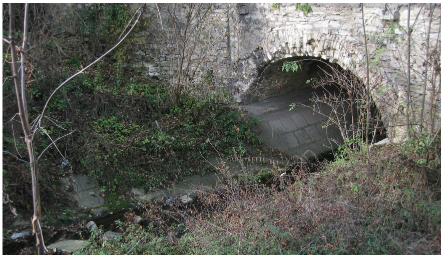
Foto č.43 – Detailní pohled na vtokovou část klenbového cestního mostku v km 12,125 s rozpadlým betonovým opevněním a naplaveninami v korytě potoka
