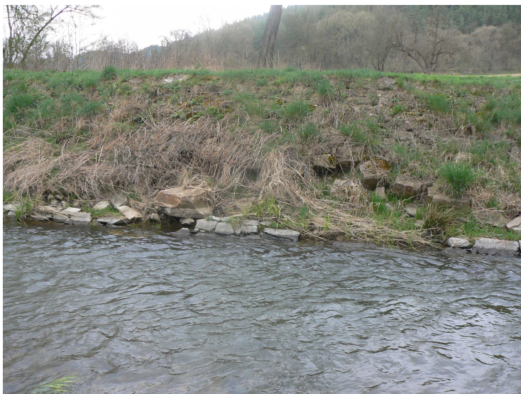
Foto č. 29 Pohled na levý břeh, poruchu opevnění, v ř. km 6,570
