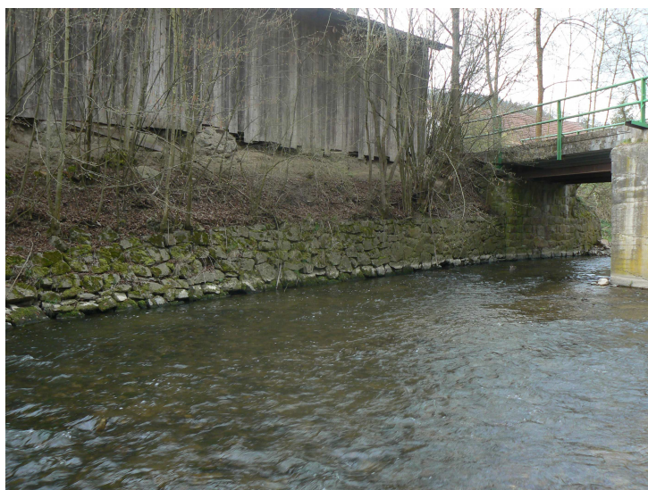
Foto č. 16 Protipravní pohled na opevnění pravého břehu určeného k přesárování, v ř. km 6,888
