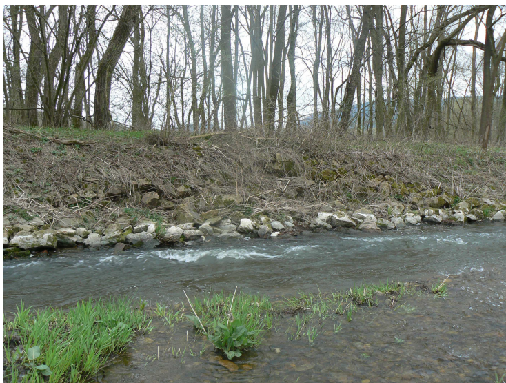
Foto č. 35 Pohled na poruchu opevnění na levém břehu, v ř. km 6,472
