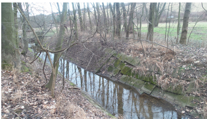
Foto č.6 – Pohled proti vodě na úsek pod stavidlem poldru v km 9,600-9,700 (při levém břehu v konci boční hráze narušené opevnění z bet. desek hrozící sesuvem a vznikem nátrže v hrázi Tuchoměřického poldru), kde končí stavební objekt SO 01.
