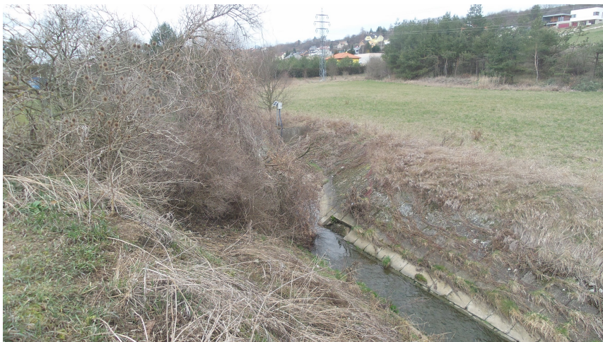
Foto č.10 – Pohled proti vodě ze silničního mostku na úsek v km 9,840-9,870 (pravostranný nálet v průtočném profilu, porušené betonové opevnění ve dně)
