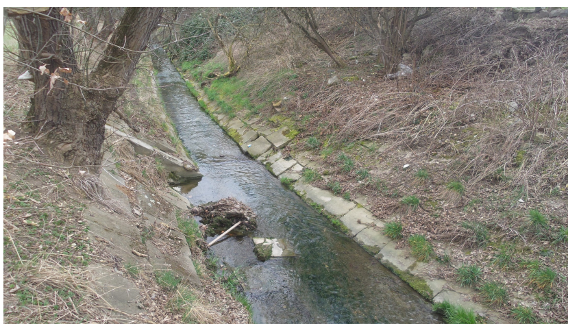
Foto č.8 – Pohled po vodě na úsek koryta nad RO Tuchoměřického poldru (levostranně došlo k odplavení desek v patě svahu a vzniku nátrže)
