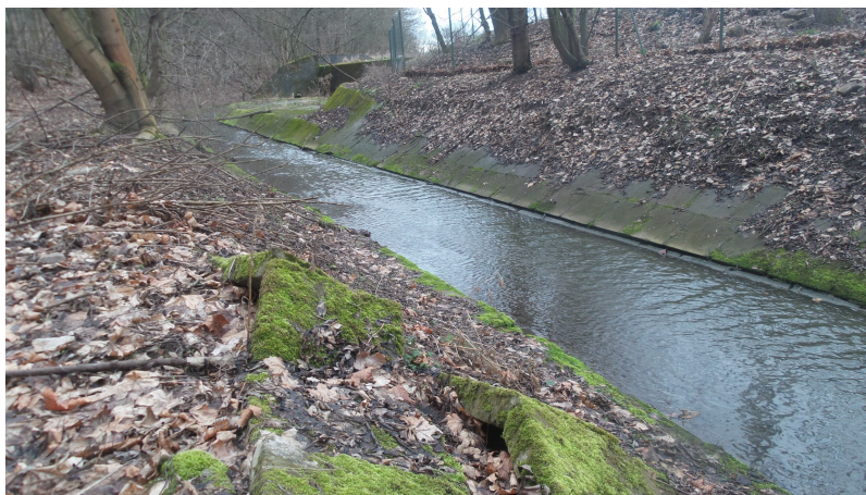
Foto č.2 - Pohled proti vodě na rozpadlé opevnění a vyplavené betonové desky v úseku km 9,276-9,300 pod funkčním objektem Tuchoměřického poldru
