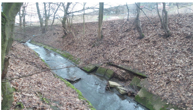
Foto č.3 – Pohled proti vodě charakteristický úsek podél boční hráze Tuchoměřického poldru (v popředí rozpadlé betonové opevnění levého břehu, v pozadí výtokový objekt rekonstruované ČOV Tuchoměřice v km 9,390)
