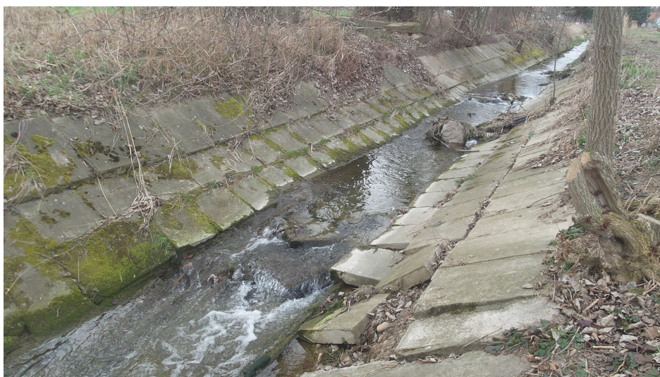
Foto č.23 – Pohled na navazující úsek v km 1,215-10,250 (rozpadlé betonové opevnění, v pozadí nátrž levého břehu v délce 12m), pravostranně hodnotný doprovodný porost nutno zachovat
