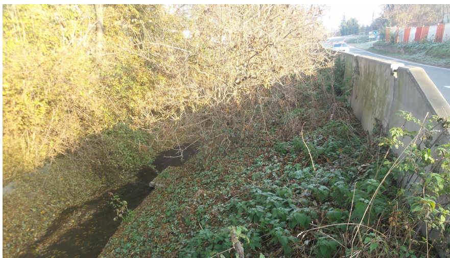
Foto č.44 – Pohled po vodě na silně zahloubený úsek pod plánovanou opravou silnice Kněžves-Tachlovice (součástí akce je náhrada rozpadlého bet. opevnění koryta korytem z kam. dlažby) mezi cestními mostky v km 12,125-12,208
