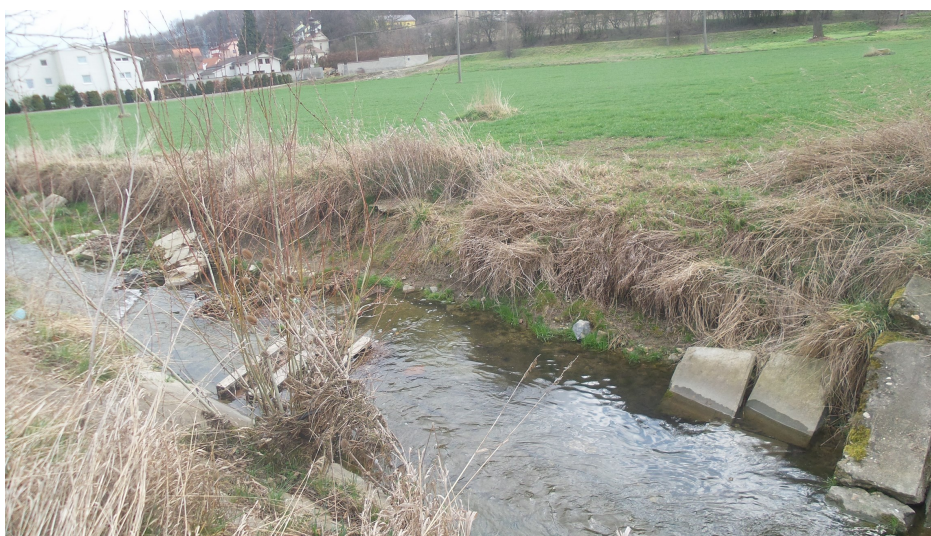
Foto č.24 – Detailní pohled po vodě na destrukci pravého břehu koryta pod fotbalovým hřištěm v km 10,300-10,340
