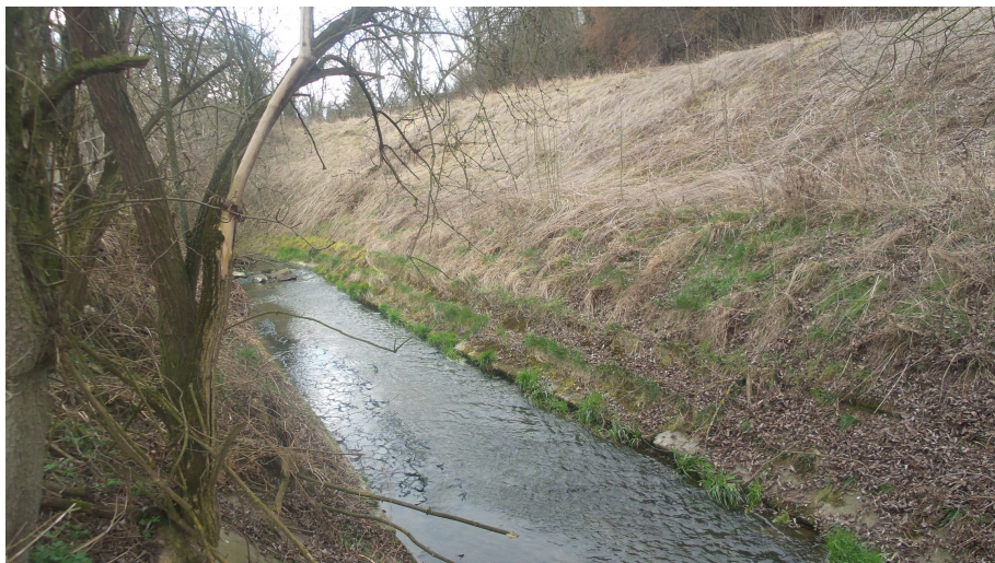
Foto č.37 – Pohled proti vodě na zahloubené špatně přístupné koryto v km 11,770-11,790 s množstvím naplavených bet. desek ve dně koryta (v pozadí)
