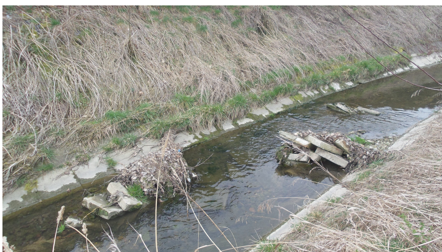
Foto č.14 – Pohled na opevněné koryto s množstvím naplavenin podél levobřežní zaplacené nemovitosti s živým plotem z thůjí (v km 9,90-10,05) – přístup pouze z levého břehu
