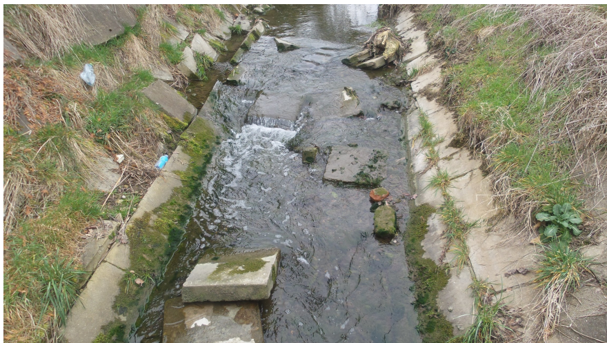
Foto č.13 – Detailní pohled na naplavené bet. desky ve dně nad lávkou v km 9,921
