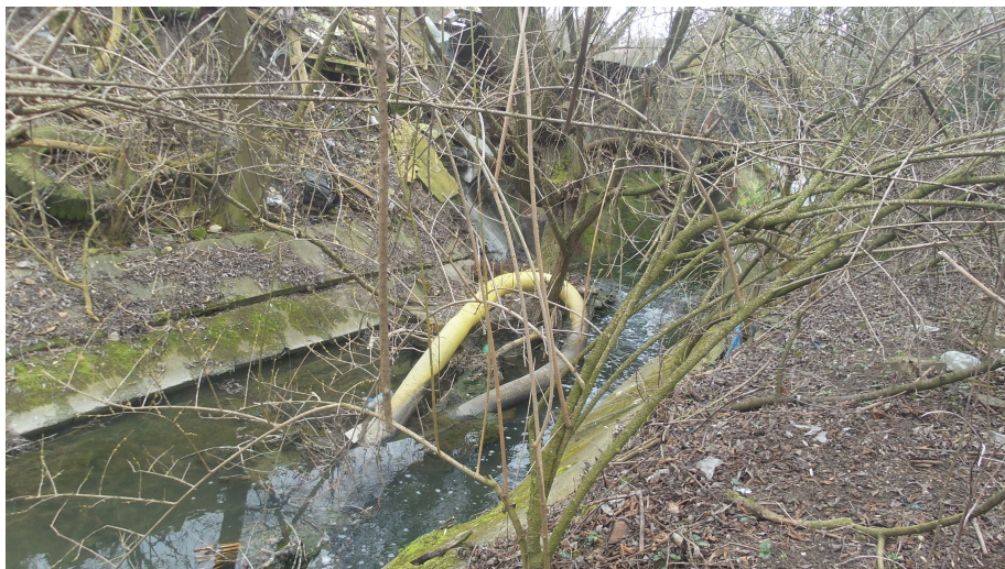
Foto č.31 – Pohled proti vodě v km 11,710-11,720 na rozpadlé opevnění dna, popadané stromy, naplaveniny a nevhodné předměty v průtočném profilu Únětického potoka
