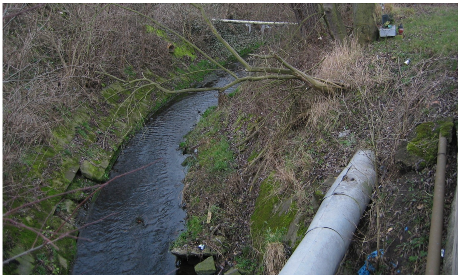
Foto č.46 – Pohled proti vodě na koryto Únětického potoka nad vtokem do silničního mostku (km 12,218-12,250), oboustranně rozpadlé opevnění břehů i dna
