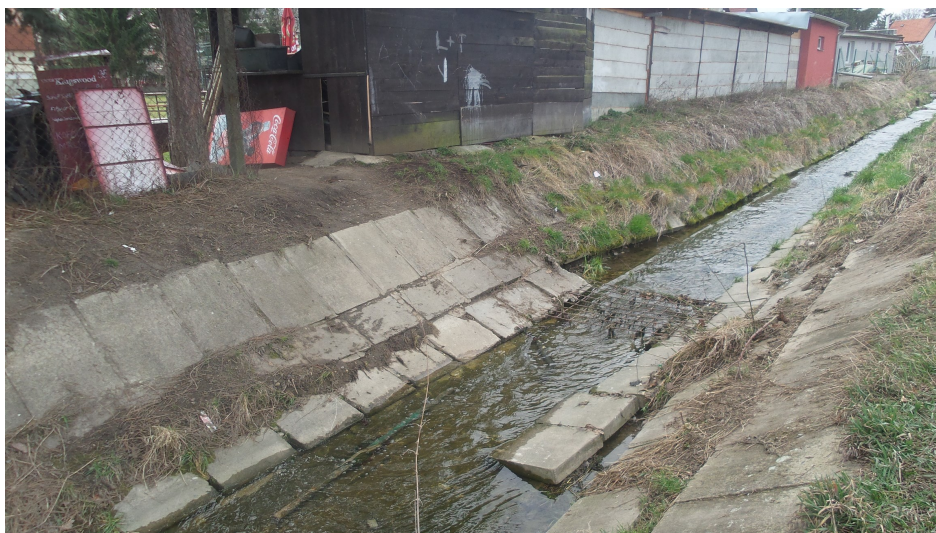
Foto č.25 – Pohled proti vodě na úsek koryta podél fotbalového hřiště v Tuchoměřicích v km 10,340-10,440 (podemletý pravý břeh koryta, rozpadlé betonové opevnění)
