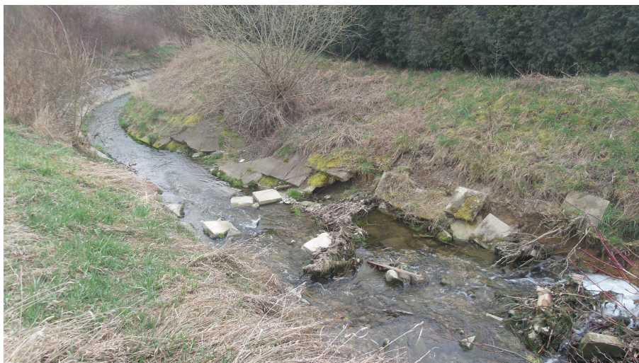
Foto č.16 – Pohled po vodě na pokračující destrukci koryta nad pravostranným obloukem koryta od km 1,020 až k vývaru výše ležícího stupně
