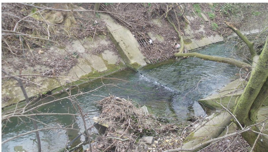
Foto č.29 – Detailní pohled proti vodě na naplaveniny pod napouštěcím objektem Mlýnského náhonu v km 11,700
