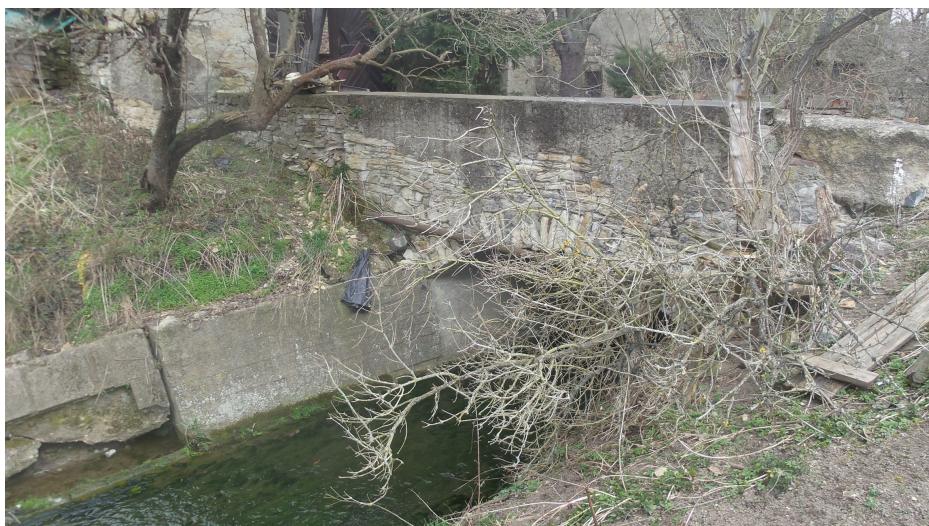
Foto č.34 – Pohled po vodě na vtokovou část klenbového mostku v km 11,733 (vlevo před betonovými opěrami mostku vznikající nátrž levého břehu)
