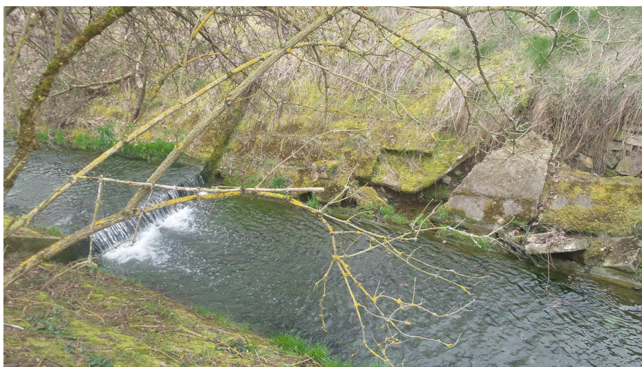
Foto č.35 – Pohled proti vodě na rozvalené bet. opevnění levého břehu pod stupněm v km 11,745
