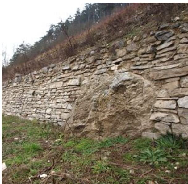
Obr. 4.3 - Uvolněné kameny v koruně zdi
