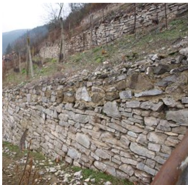
Obr. 4.4 - Vysprávka a uvolněné kameny
