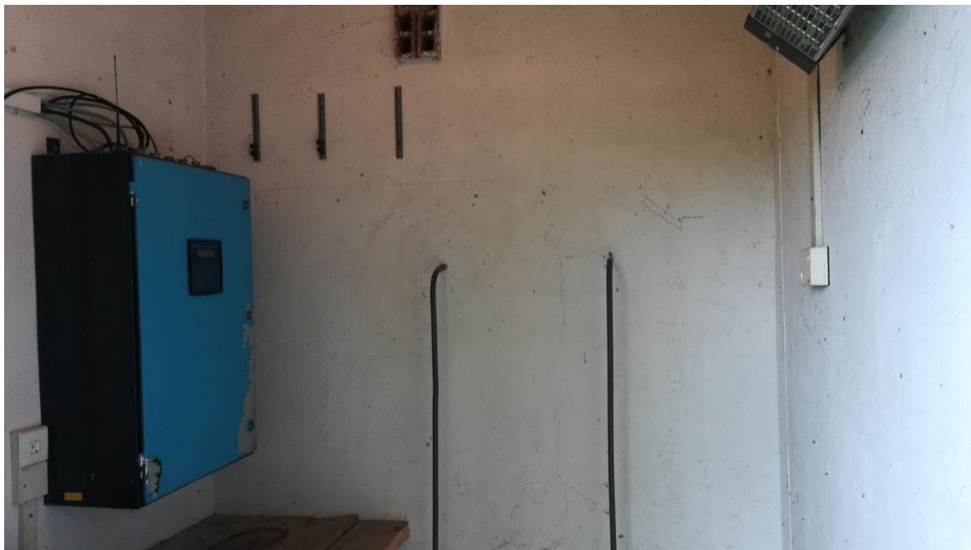
Obr.5 – Objekt měřicí stanice - vnitřek
