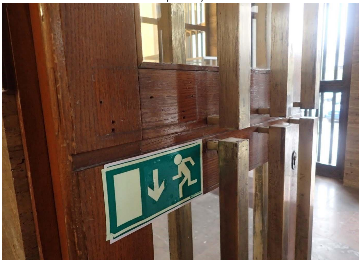
Povrchová úprava a poškození dírkami
