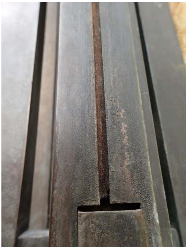
Detail koroze povrchu
