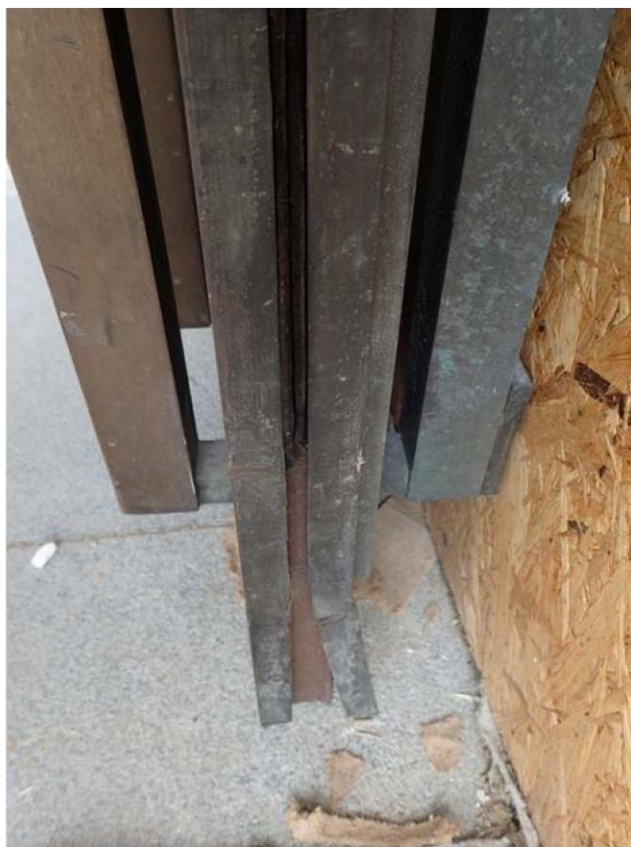
detail poškození obložených plechů
