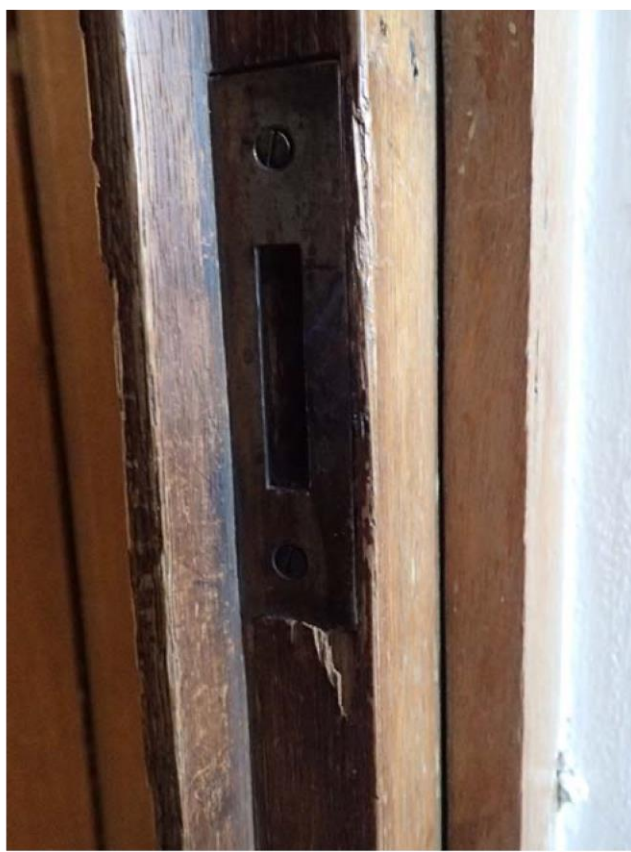
poškození kolem zámku
