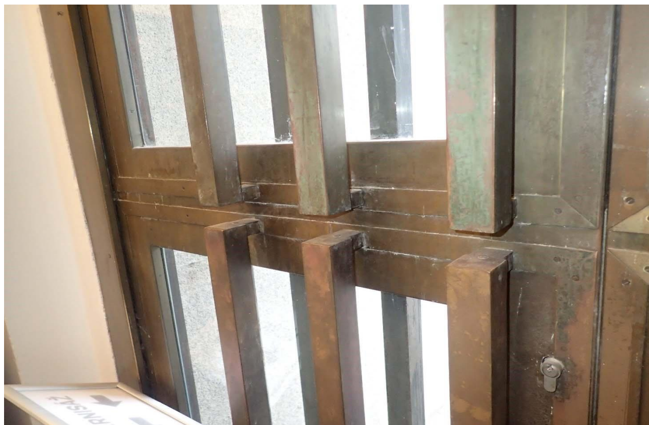
Krajní pravé dveře – pohled z interiéru – detail – chybějící madlo
