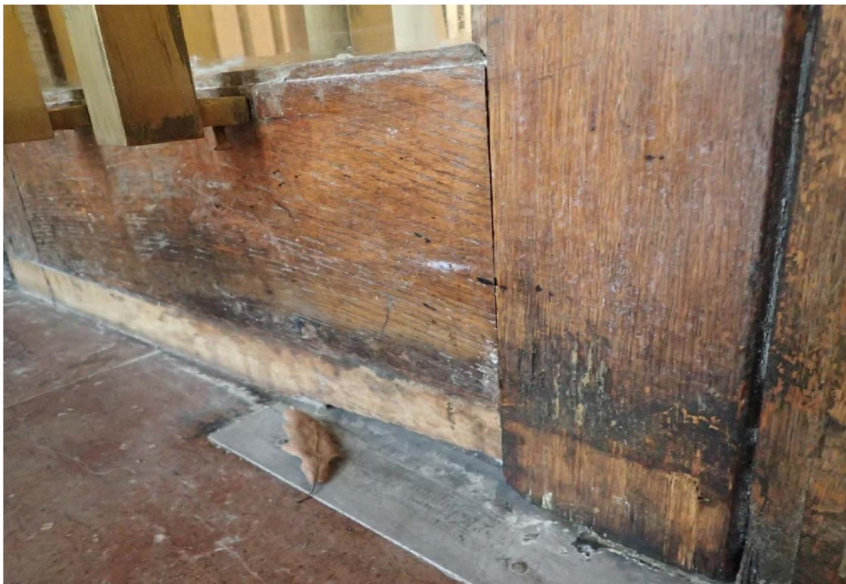
Chybějící oplechování na krajních levých dveřích
