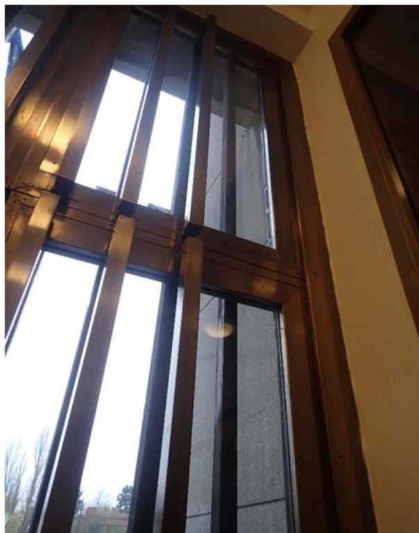
detail chybějících madel
