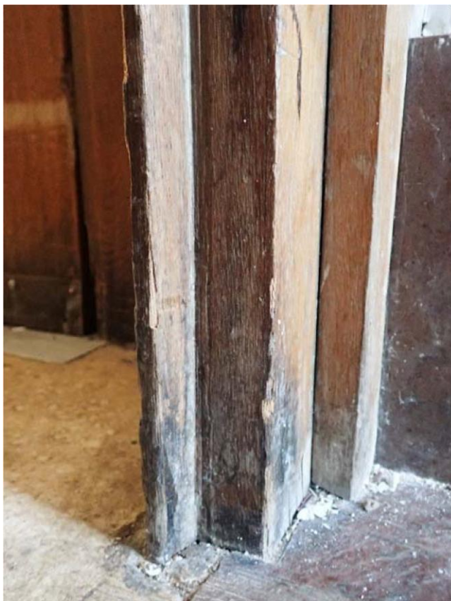
Dveře do šatny – poškozený rám
