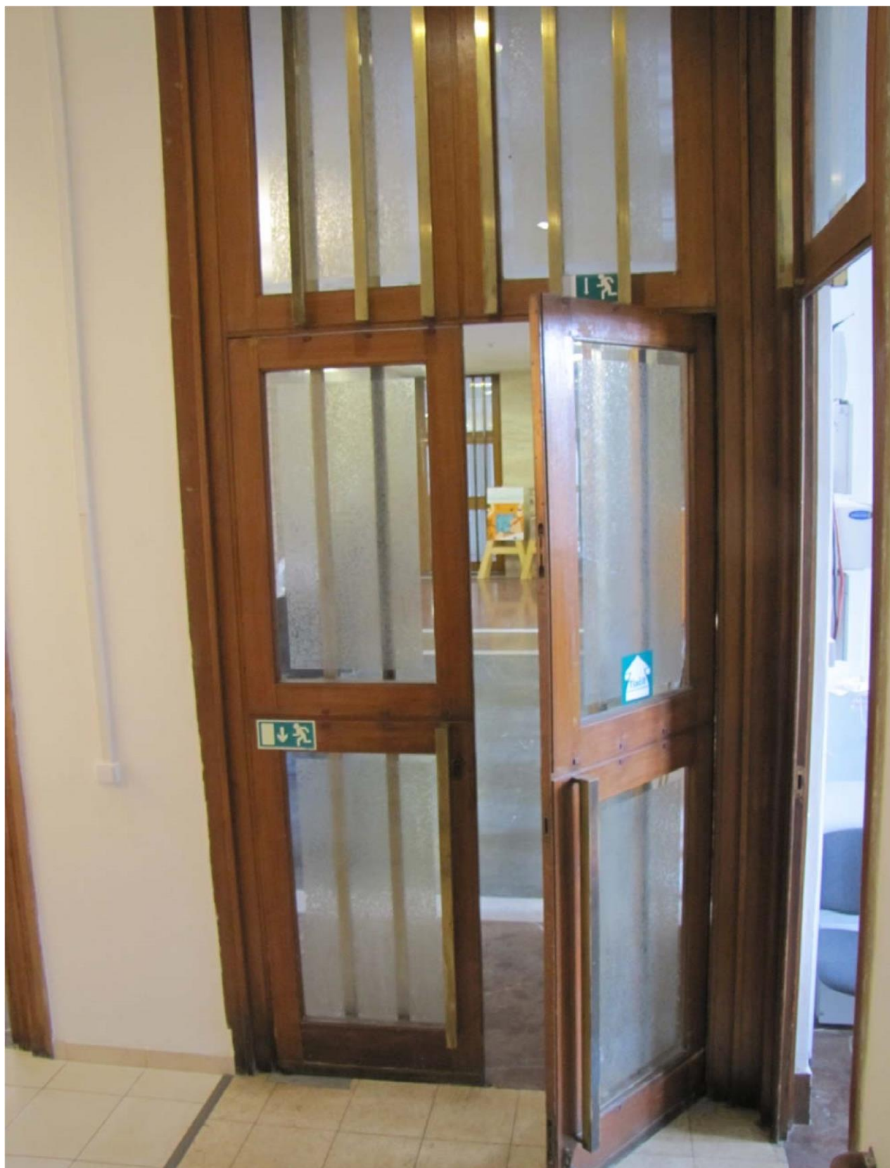
Dveře na levé straně vestibulu – vstup do vedlejších prostor Pohled z vnitřní strany - chybějící madla
