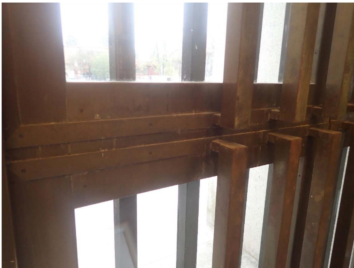
Krajní pravé dveře – pohled z interiéru – detail – chybějící madlo
