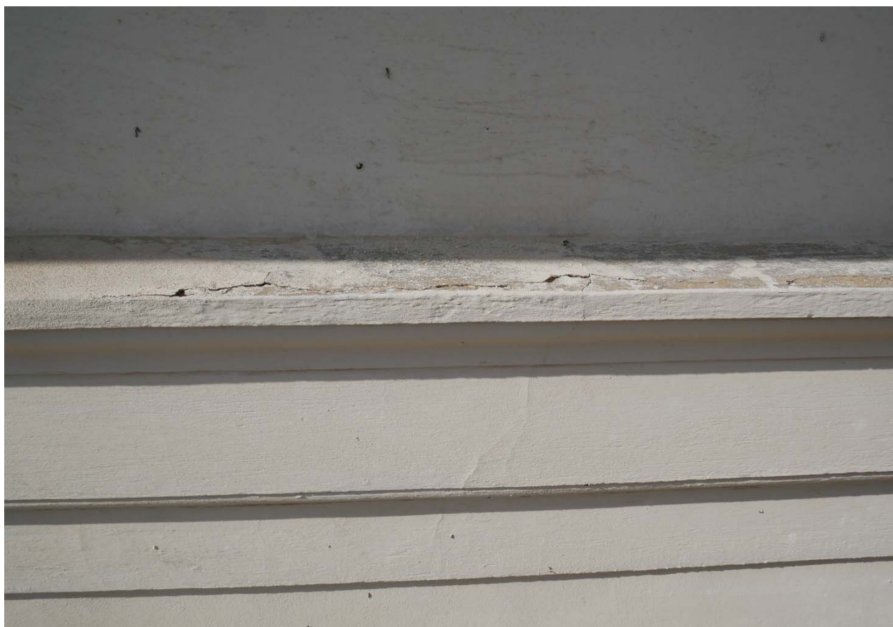
Trhliny v profilacích římsy
