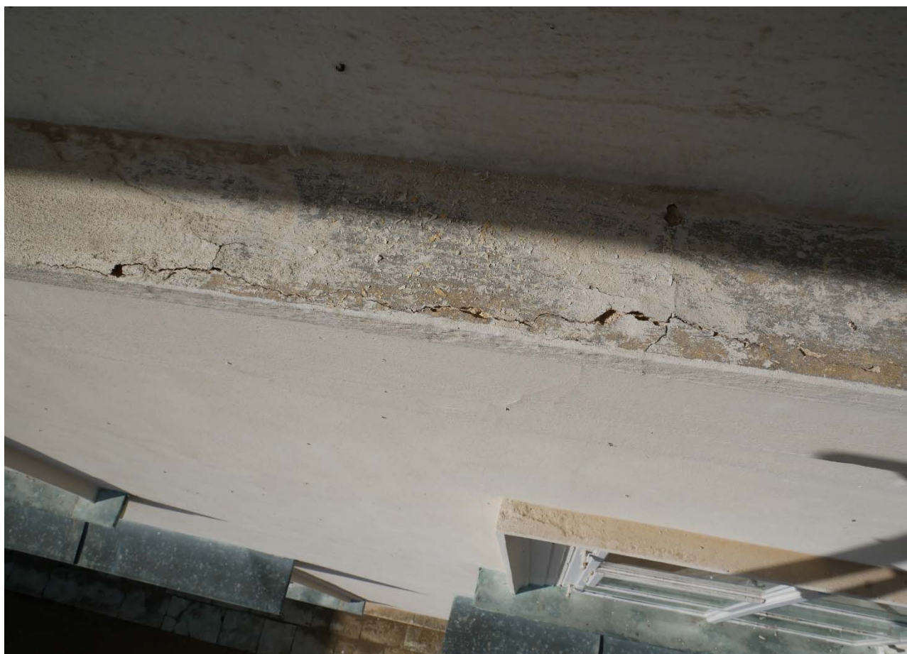
Trhliny v římse
