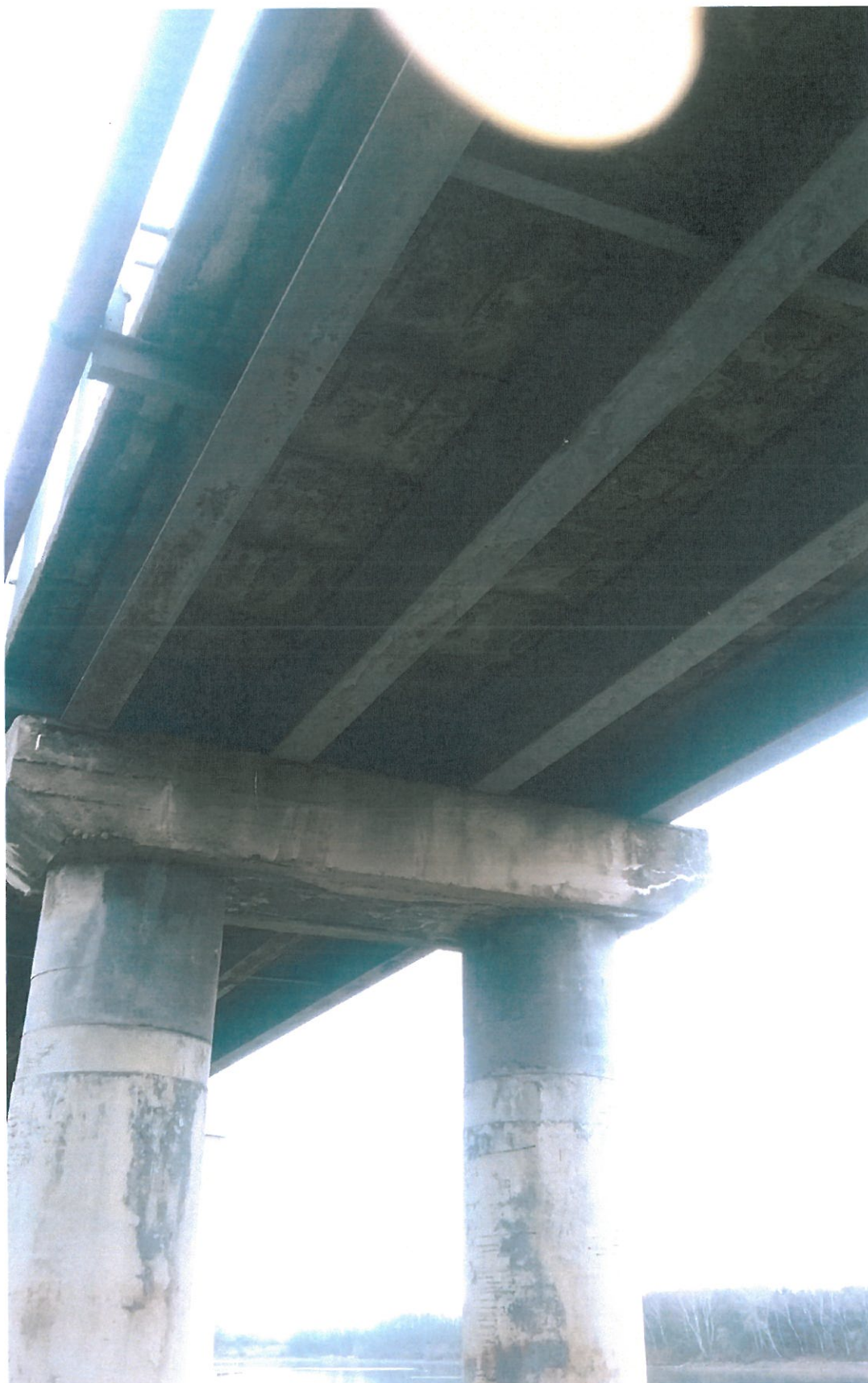
Pohled na betonové zhlaví, ocelovou konstrukci a poškozenou železobetonovou konstrukci
