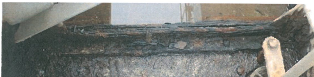
Obr. 7 Vrstevnatá korozí L profilů
