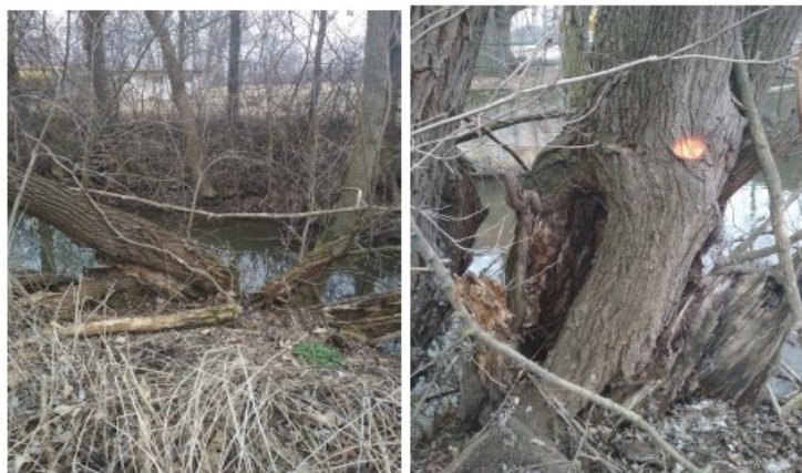
rozpadající se vícekmene zasahující do průtočného profilu a nad obhospodařovaný pozemek, dutina u báze kmene s pokročilou jádrovou hnilobou
