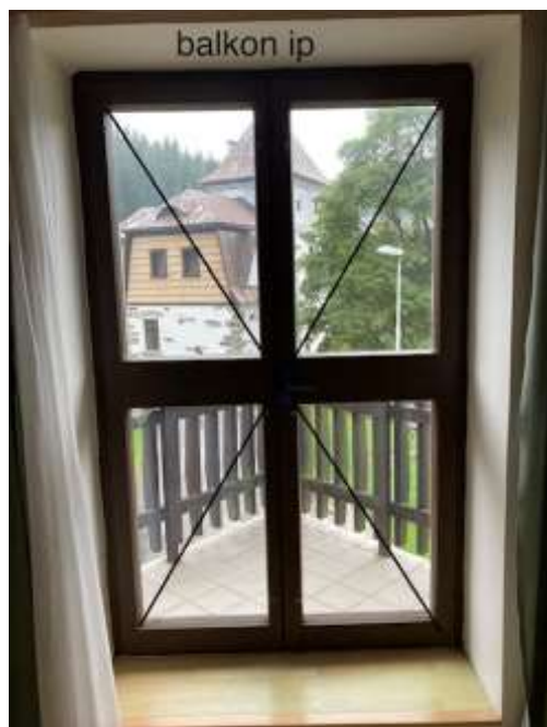
OBR. 19) BALKONOVÉ DVEŘE IP - ZÁPADNÍ A SEVERNÍ POHLED
