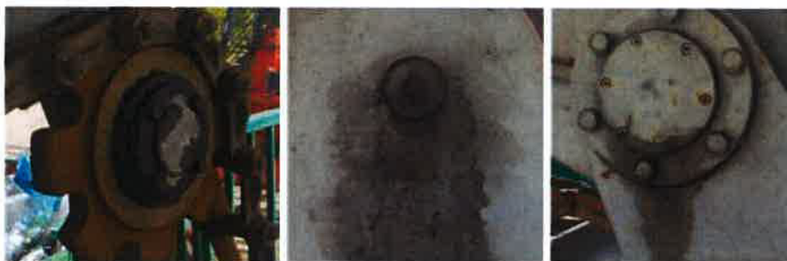
Úkapy na čepech čistícího stroje
