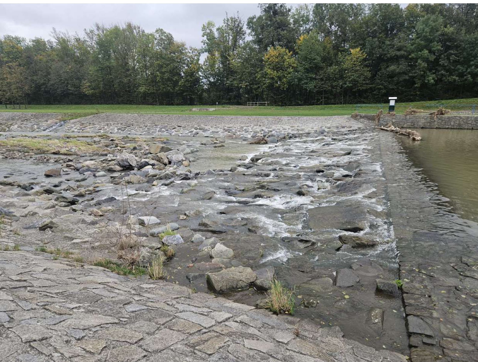
Pohled na rozvolněný přechodový prvek jezu - balvanitý skluz z levého břehu
