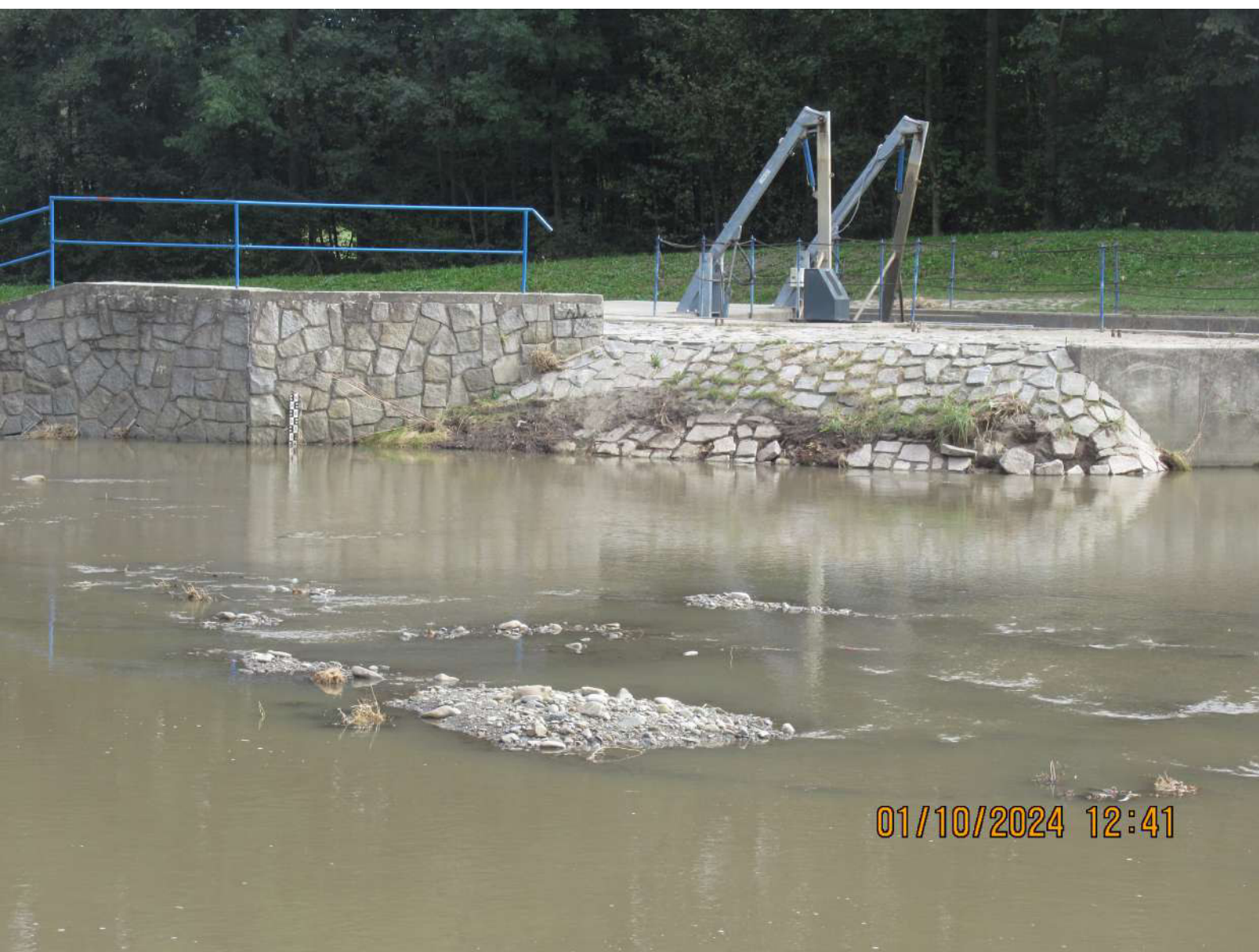
Narušené PB opevnění jezu
