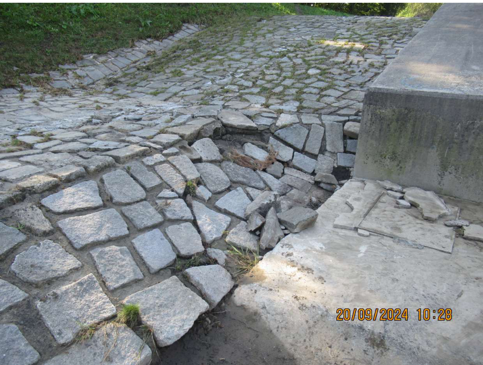
Poškozená PB opevnění kamennou dlažbou
