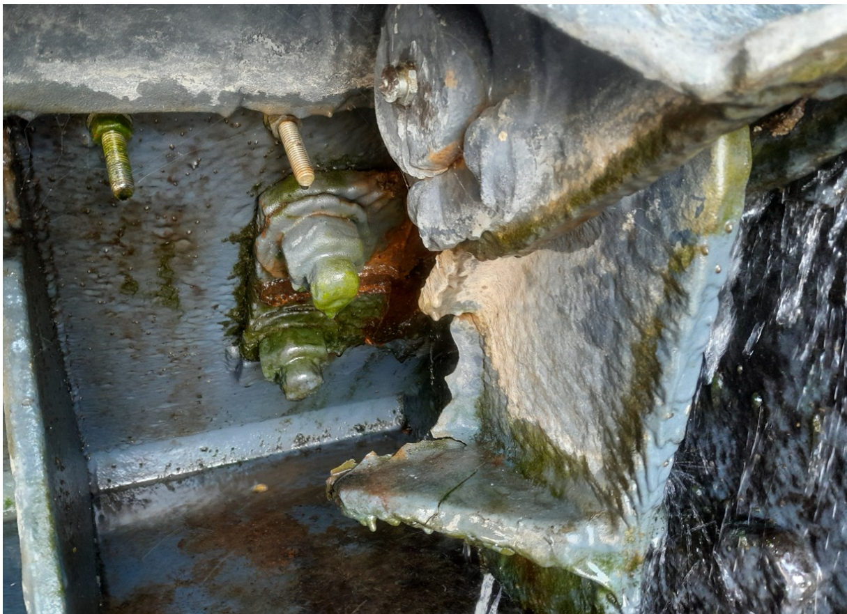
Poškozené levé ložisko levé jezové klapky
